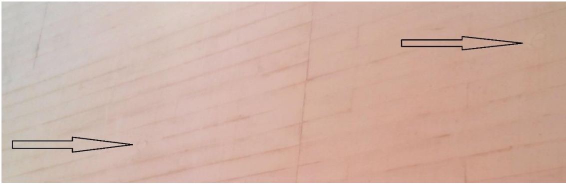
Encofrado de tablilla con hormigón blanco. Orificios tapados con mortero con excelente resultado. ETSI Telecomunicaciones, fachada este. UPV.
