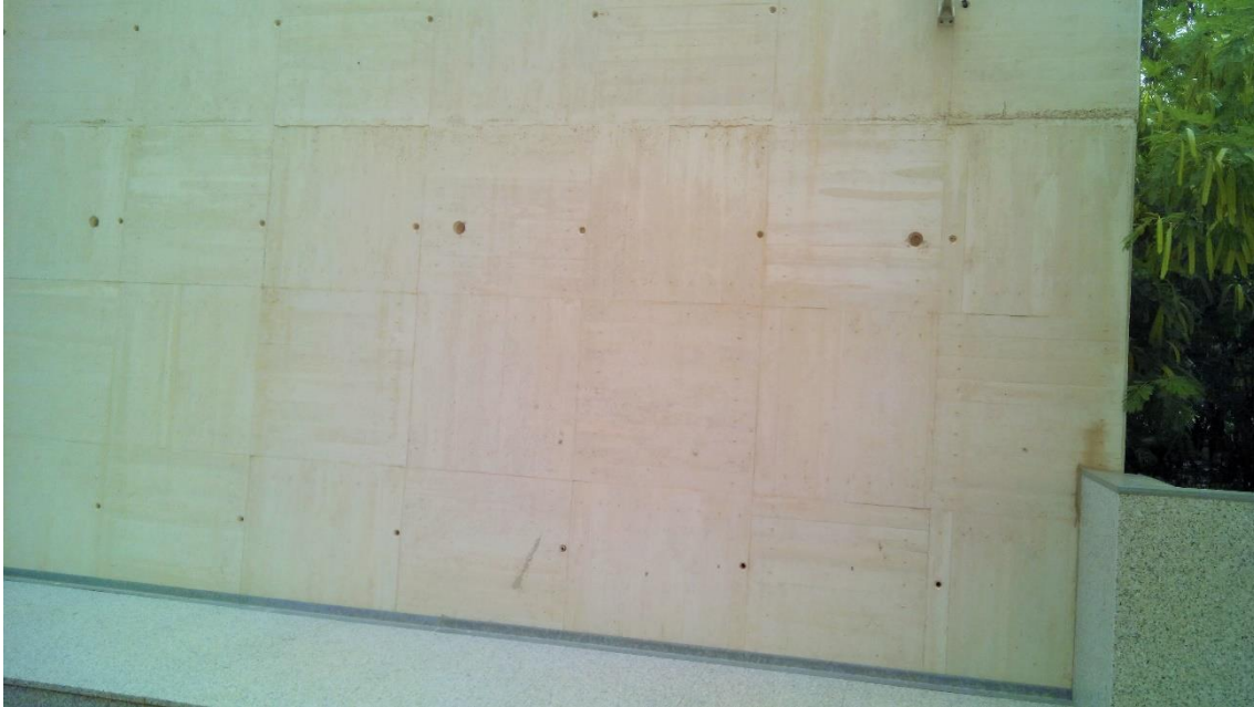
Forro de tablilla clavado sobre encofrado marco modular de 3x1 m. Edificio Manuel Sanchis Guarner, fachada sur. Universitat de València.
