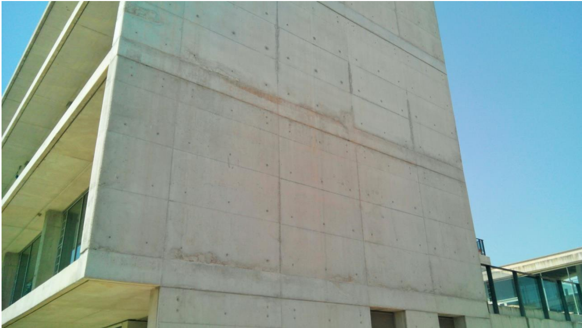
Pérdida de finos por falta de estanqueidad. Casa del alumno, fachada este. UPV.
