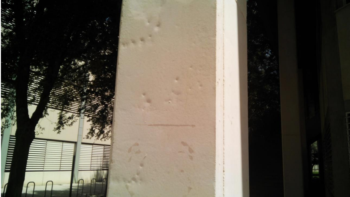
Huella de encofrado metálico con abolladuras. ETSI Telecomunicaciones, pilar noroeste. UPV.
