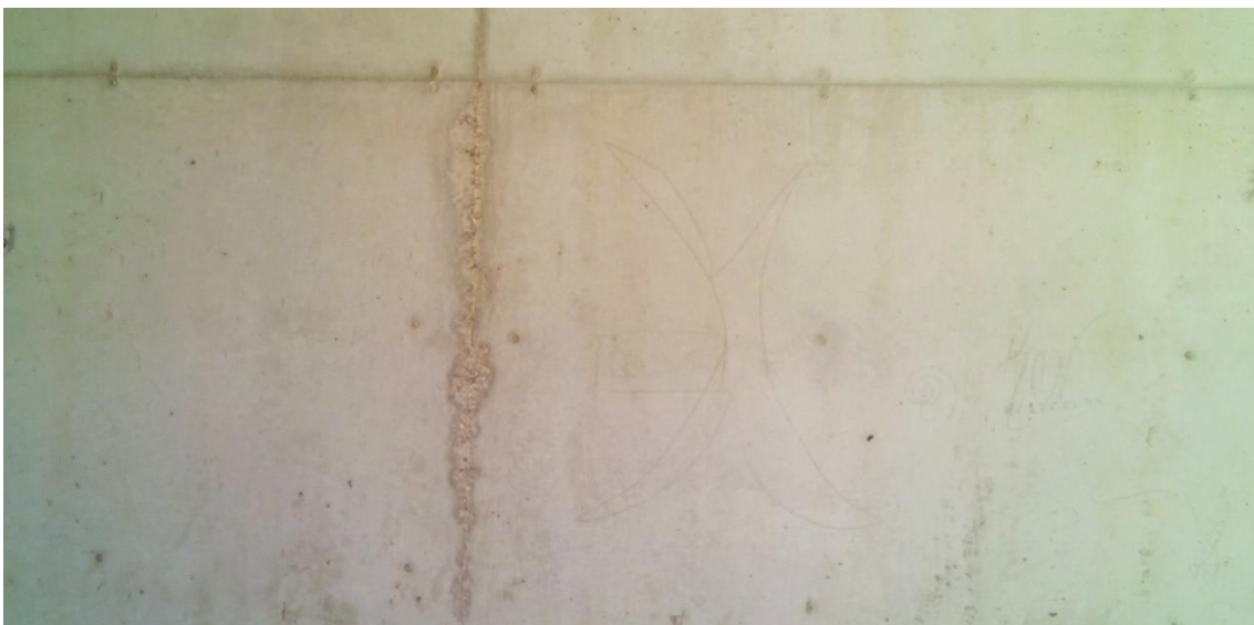
Pérdida de finos en junta de forro encofrado de vigas. Casa del alumno. UPV.
