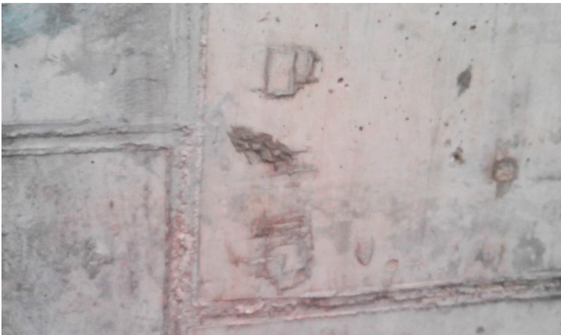
Huella de forro contrachapado muy deteriorado por arrancamiento de fragmentos de capas de contrachapado y película protectora. Garaje Plaza del Árbol. Valencia.
