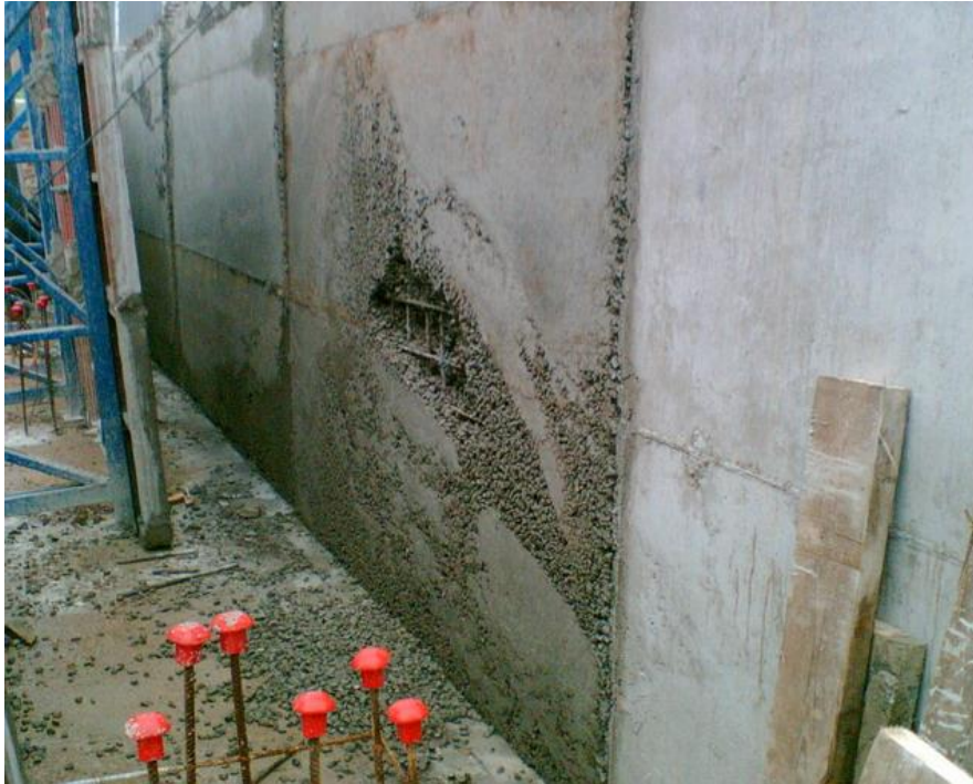
Error en vertido y compactación. http://www.estudioarquitecturatecnica.es/
