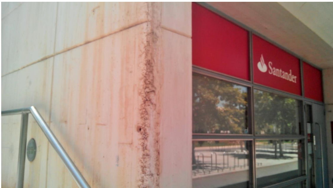
Pérdida de lechada en zona de esquina. Ágora. UPV.
