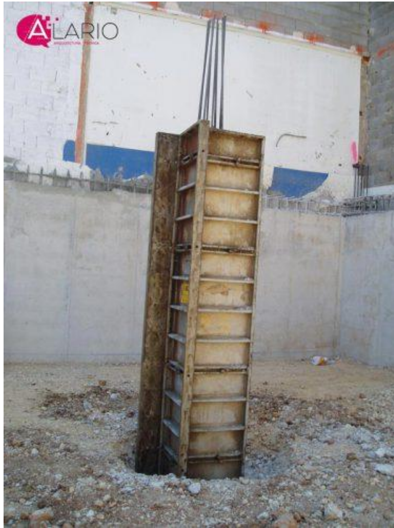
Encofrado metálico de pilar con cara encofrante oxidada. Muro con manchas de óxido (Enrique Alario)
