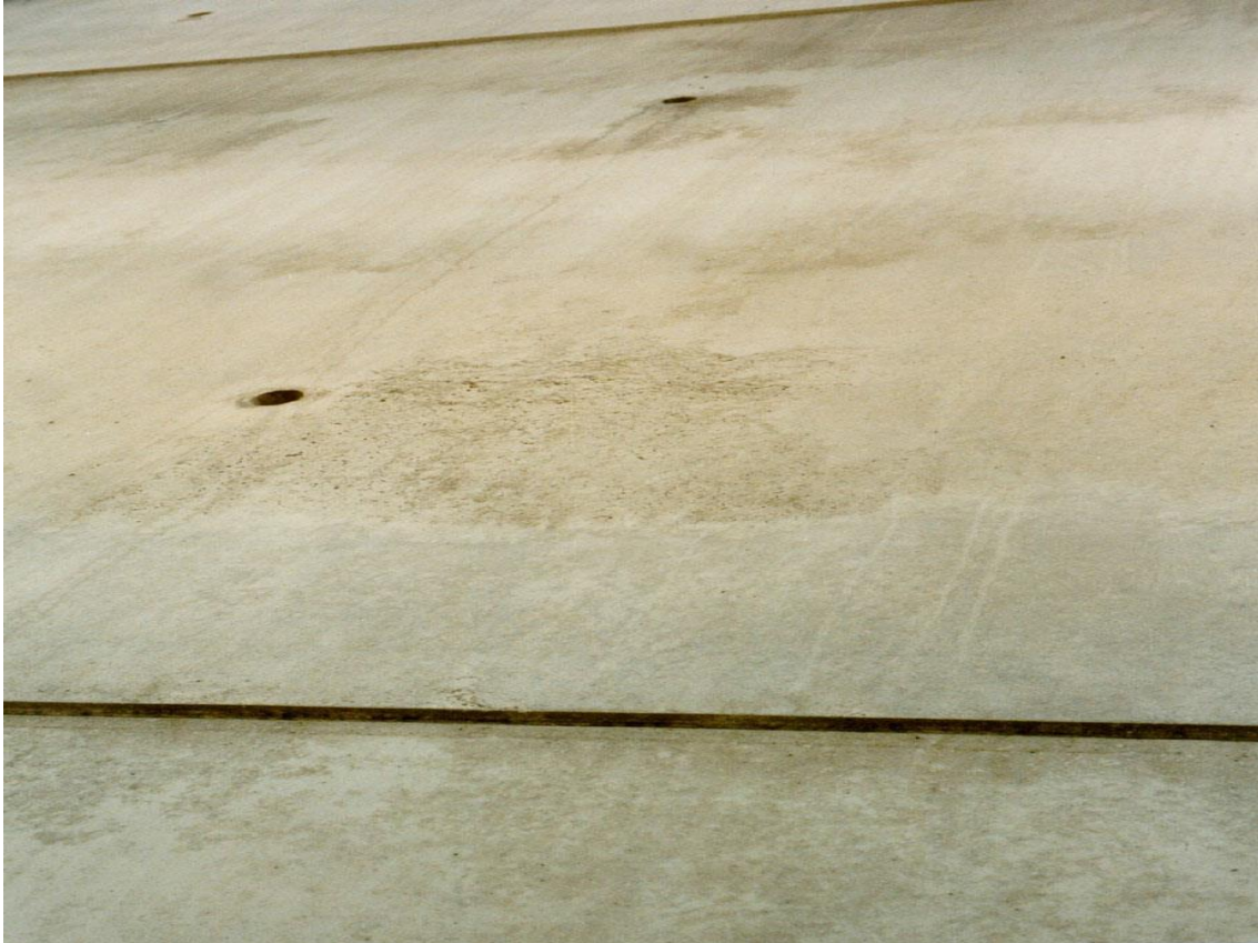
Manchas por mala aplicación de desencofrante. Prof. Dr. Christoph Motzko.
