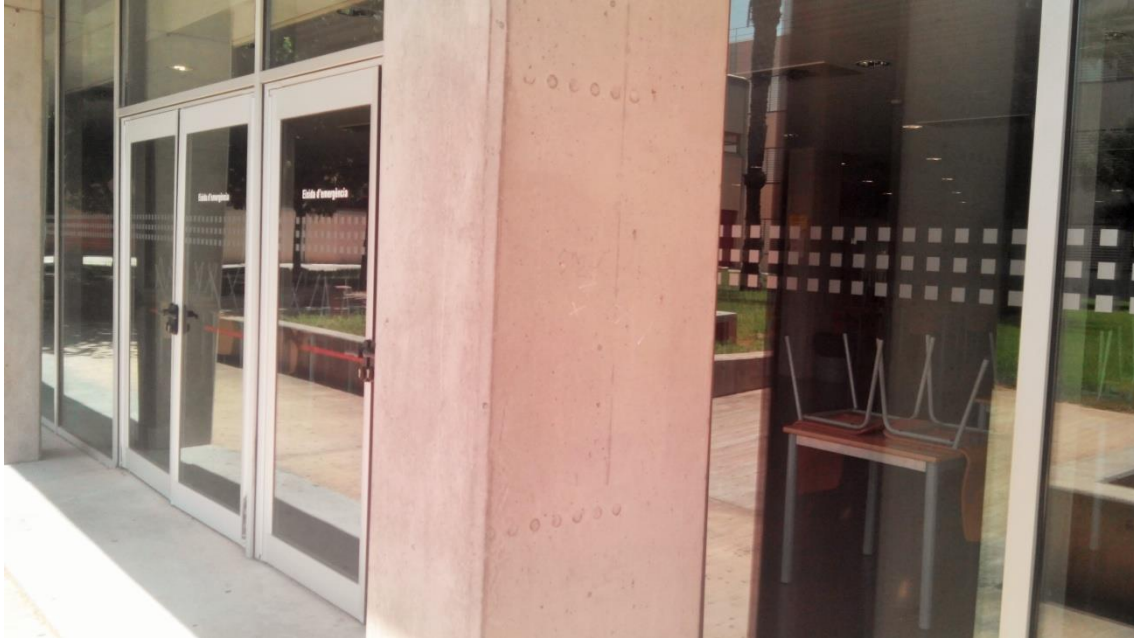
Pilar con esquinas matadas bien ejecutadas. Casa del alumno, fachada sur. UPV.
