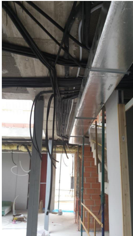
Imagen 3.68. Visión general del paso de tubos de electricidad
