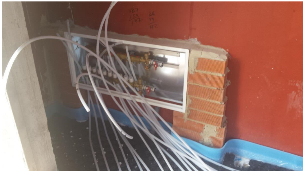
Imagen 3.60. Conexión de los tubos del suelo radiante con la red general de la vivienda al cuadro de distribución o colector
