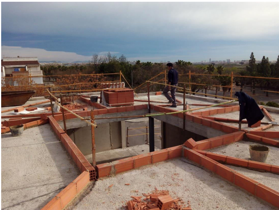
Imagen 3.48. Insuficiente barandilla en patio de luces
