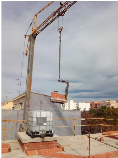
Imagen 3.49. Movimiento de grúa sin anclar el material y con gente dentro del perímetro de grúa
