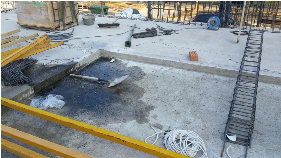
Imagen 3.8. Desorden generalizado de la zona de trabajo
