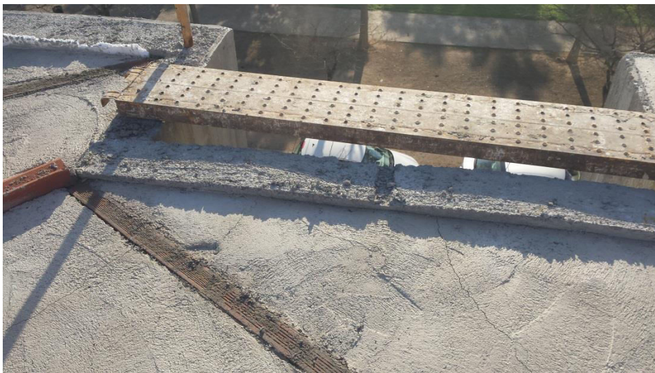
Imagen 3.54. Solución incorrecta para tapar el hueco en cubierta
