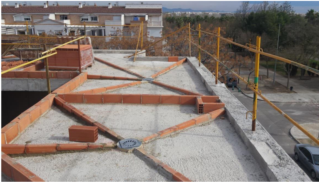
Imagen 3.47. Ejecución de faldones en cubierta y mala colocación de barandilla en esquina
