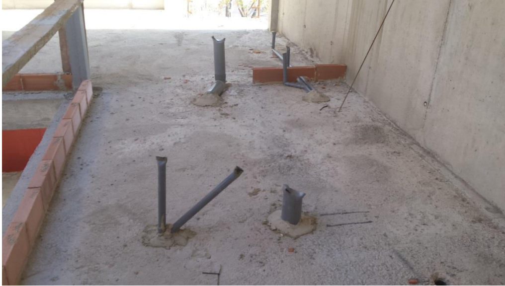
Imagen 3.53. Bajantes de los aparatos sanitarios del baño principal
