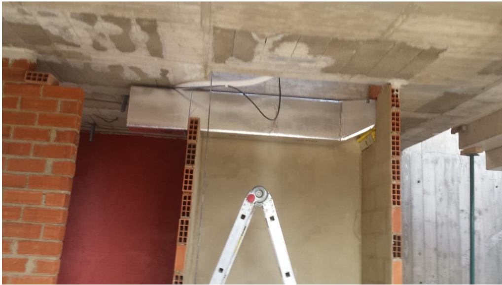
Imagen 3.55. Pasos de instalaciones, se ve climatización, electricidad y bajantes verticales del baño superior
