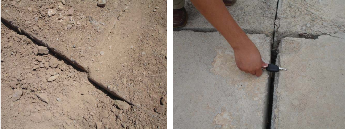
Figuras 9 y 10: Deslizamiento relativo en cimentación y abertura de juntas en cubierta
