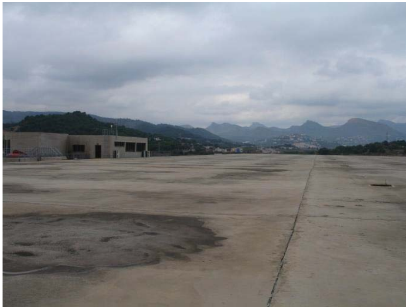
Figura 11: Retención de pluviales en la cubierta
