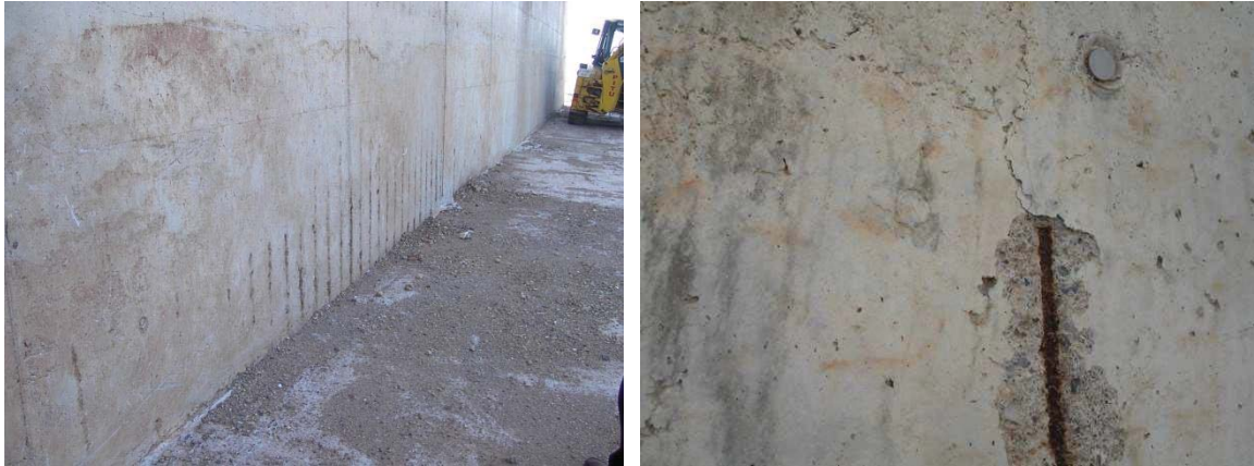
Figuras 12 y 13: Corrosión de las armaduras
