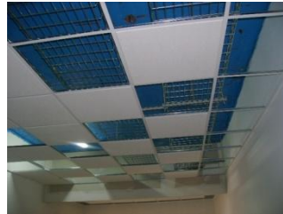
Canalizaciones por falso techo
