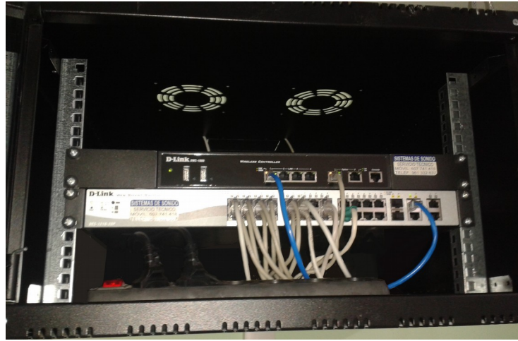
Ilustración 12: Armario Rack con Controlador WiFi y Switch PoE
