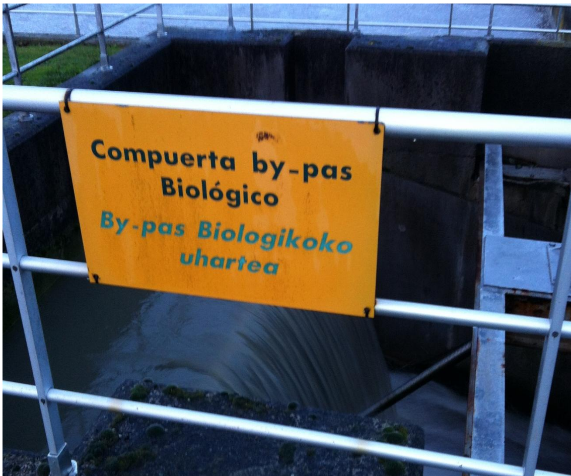
Figura 3.20: By-pass en el canal de salida de decantación primaria de la EDAR de Arazuri-Pamplona (Fotografía de Mikel Sanz).
