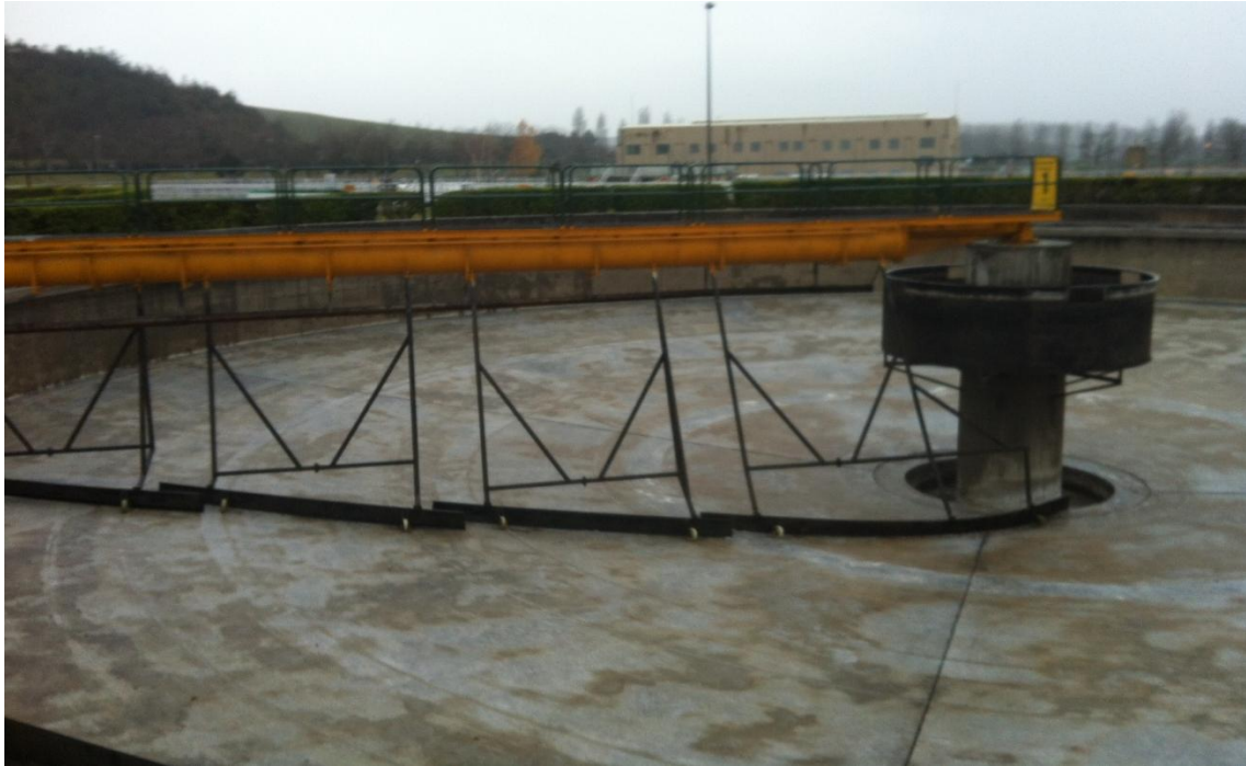
Figura 3.7: Decantador primario en la EDAR de Arazuri (Fotografía de Mikel Sanz).
