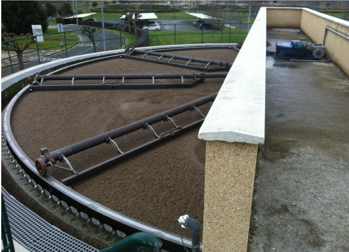
Figura 3.15: Espesado de fango secundario por flotación en la EDAR de Arazuri (Fotografía de Mikel Sanz).
