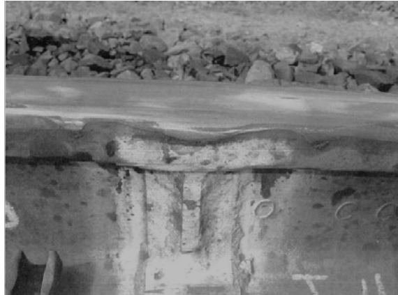
Figura 2.12. Hundimiento de junta de vía. De la referencia [200].
