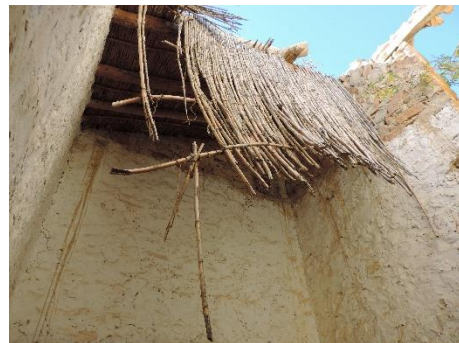
Figura 100 - Colapso de la cubierta del Mas de la Vall, Llucaena. Fuente: Propia.
