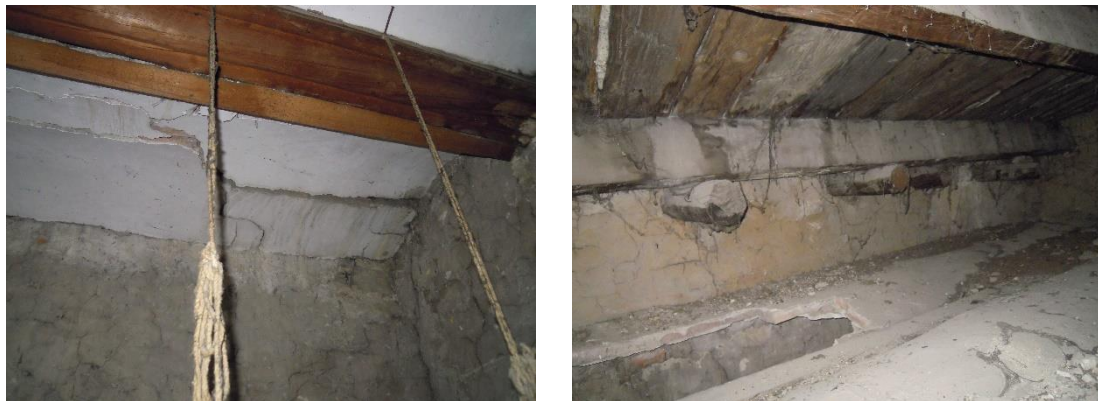
Figura 105 - Patologías en revoltones cerámicos. Fuente: Propia.
