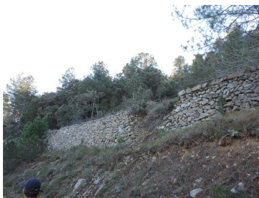
Figura 108 - Ejemplo de un desprendimiento en un muro de piedra en seco. Fuente: Propia.
