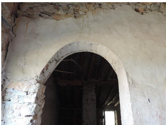
Figura 91 - Restos de un encofrado de yeso en un arco. Fuente: Propia.
