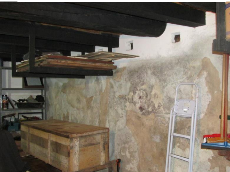
Fig.83. Humedad en el muro de piedra que hace divisa con el terreno
