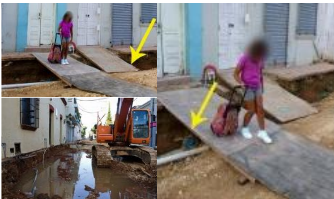
Figura 156. Situación alarmante de la circulación de los moradores en la Calle Padre Billini. Fuente: Las fotografías realizadas por Manolo Vidal, residente en el sector. (2014)
