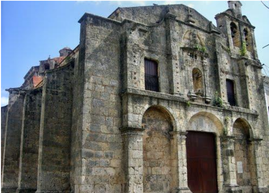
Figura 125. Iglesia Regina Angelorum, fachada frontal, patologías: algas verdes epiliticas, humedades, desconchados, corrosión. Fuente: Jemmy Bello (2013)
