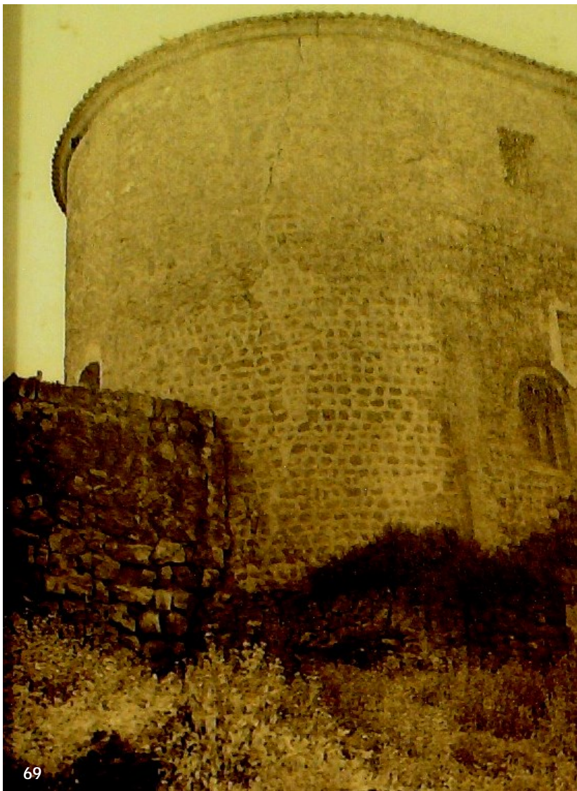
Grietas Ábside – Año 1980
