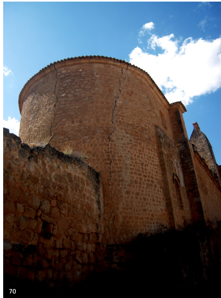
Grietas Ábside – Estado Actual
