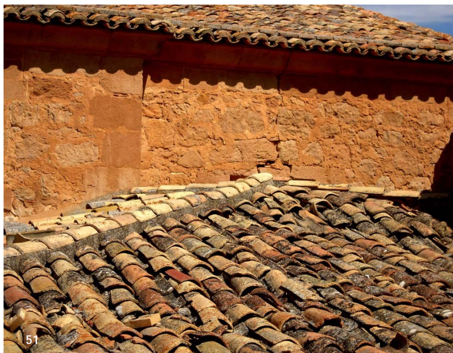
Desplazamiento y rotura de tejas sacristía
