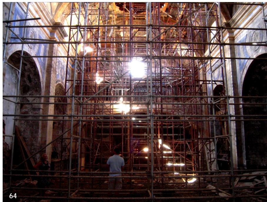
64 Coro- Estado Actual
