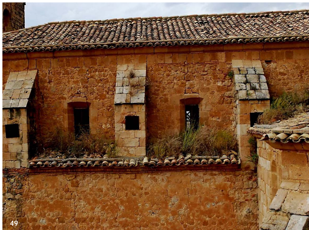
Presencia de plantas de envergadura en cubiertas.
