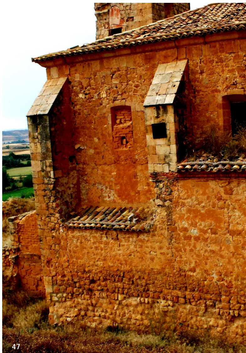
Humedad ascendente por capilaridad – Ejemplo en foto Fda. Sur
