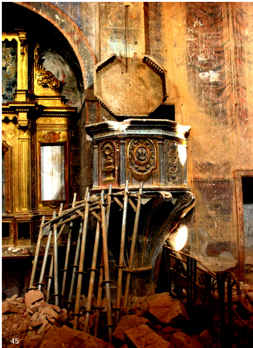
Precario estado del púlpito
