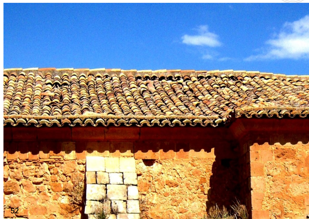
Desplazamiento y rotura de tejas vista desde fachada Sur
