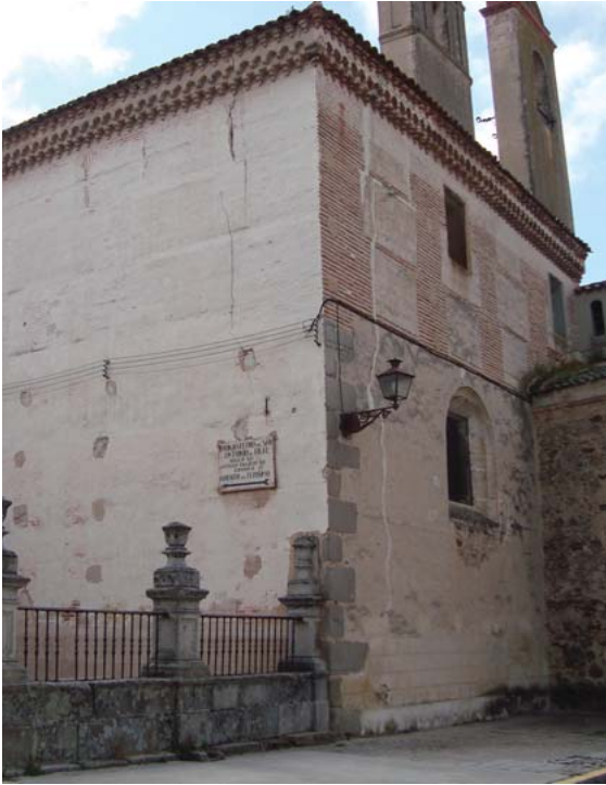
Figura 3.64. Ejemplo de grietas provocadas por el empuje de la cubierta (Convento de San Antonio el Real en Segovia).
