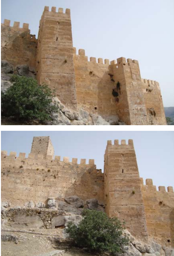
Figura 9.73. Imágenes del estado actual de las torres y los lienzos de muralla con presencia de nueva vegetación en algunos huecos y mechinales.
