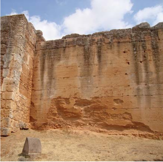
Figura 8.13. Imagen actual de la Muralla de Niebla en la que se aprecian las pérdidas de material en las nuevas tapias producidas por la humedad por capilaridad.
