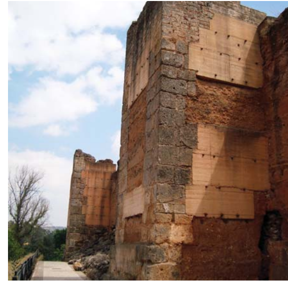
Figura 7.18. Imagen del estado actual de una de las torres de la Muralla de Niebla en la que se han reconstruido las tapias adosadas al muro original.
