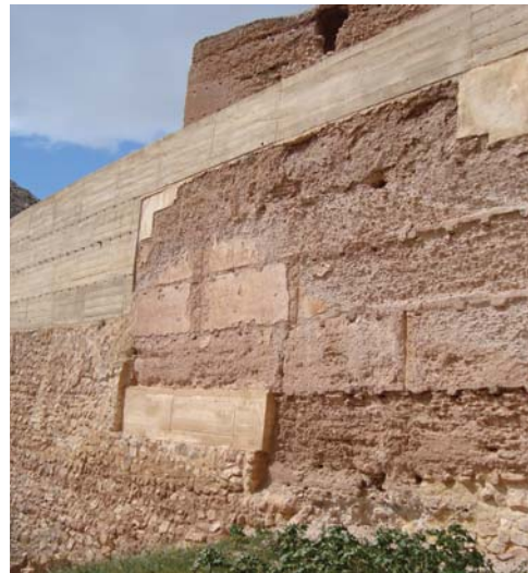
Figura 3.53. Ejemplo de pérdida de costra y exposición del núcleo de tierra en un muro de tapia calicostrada (Castillo de la Mola, Novelda).
