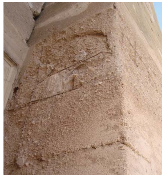
Figura 8.5. Imagen actual del Castillo de Orce, en la que se aprecia que se han producido desprendimientos superficiales quedando vistas las armaduras de acero liso empleadas en la unión.
