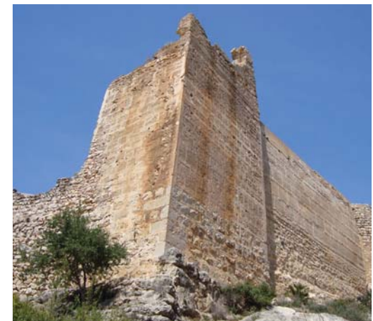
Figura 8.10. Imagen actual del Castillo de Alcalá de Xivert en la que se aprecian las manchas de suciedad producidas por las escorrentías superficiales de agua desde la coronación.
