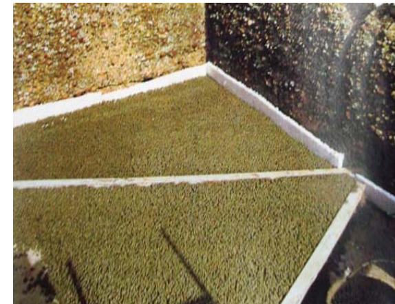
Figura 9.29. Imagen de las cubiertas en la fase de formación de pendientes. Expediente A97.0050E.23BC del archivo de la Consejería de Cultura de la Junta de Andalucía.
