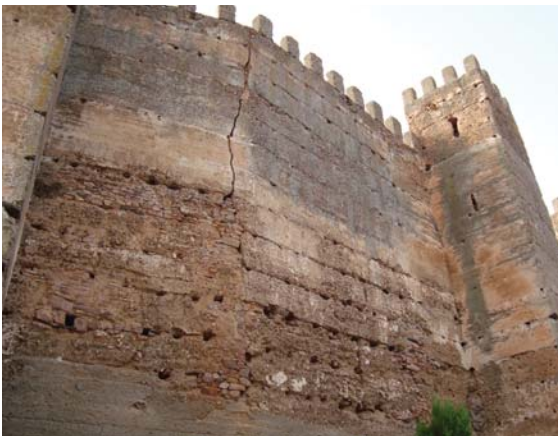
Figura 9.37. Detalle de la imagen actual del lienzo entre los torreones 8 y 9 en la que se detecta la fisura vertical.
