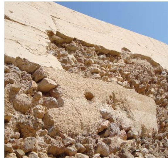
Figura 3.50. Erosión superficial de los muros de tapia con mampuestos del Castillo de Alhama de Murcia.
