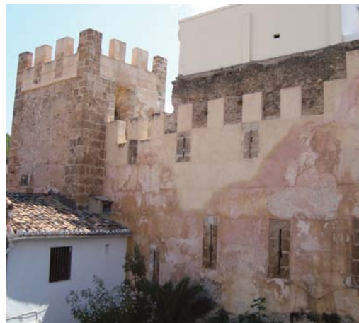
Figura 8.9. Imagen actual del Castillo de Buñol en la que se puede ver la humedad que afecta a gran parte de los muros.
