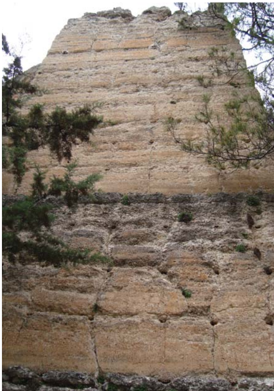
Figura 3.41. Degradación actual de los muros de tapia de la Torre del Agua en Segura de la Sierra (Jaén).
