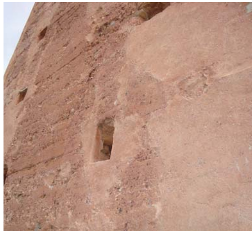
Figura 9.61. Detalle del estado actual de las superficies de la torre.
