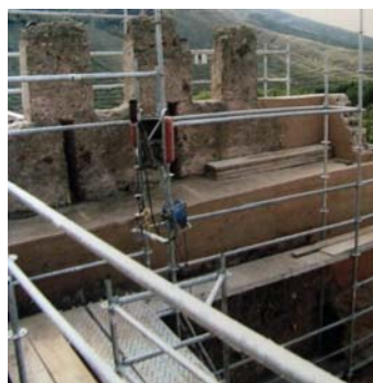
Figura 7.14. Detalle de la intervención en la coronación en el Castillo de Yanguas, se han ejecutado nuevas tapias en las esquinas faltantes sin construcción de almenas. Expediente PI 1109.
