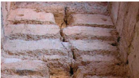
Figura 9.32. Imagen interior de la grieta del torreón 4. Extraída del expediente I06.2117.23 del archivo de la Consejería de Cultura de la Junta de Andalucía.
