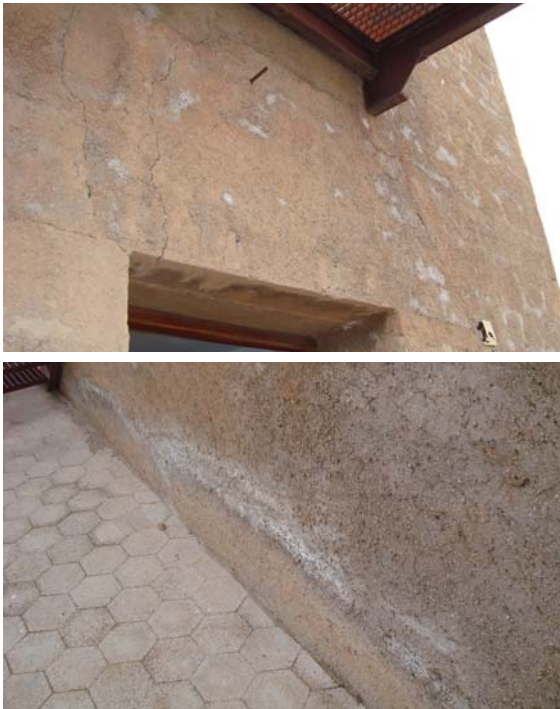
Figura 9.23. Imágenes actuales de la Torre del Homenaje en las que se aprecian las eflorescencias.
