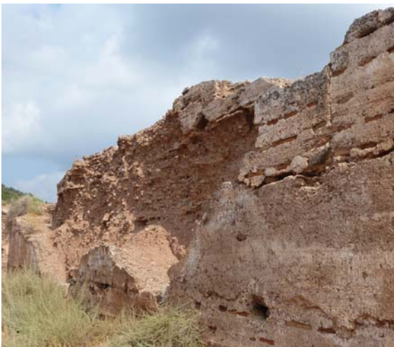
Figura 3.58. Ejemplo de pérdida progresiva y desprendimientos de la costra y los ladrillo en la tapia valenciana (Castillo de la Vilavella en Nules, Castellón)
