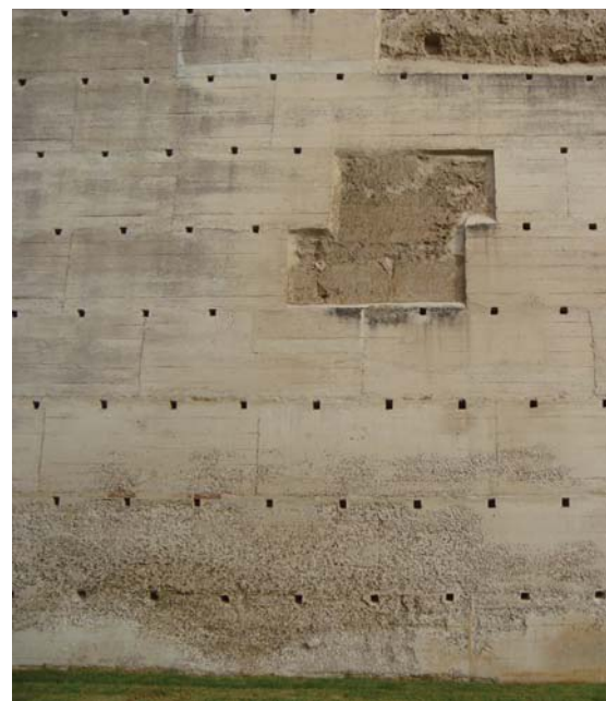
Figura 8.2. Imagen actual del Alcázar de Jerez de la Frontera, en la que se aprecia que se han producido erosiones superficiales en las nuevas tapias producidas por la humedad por capilaridad.
