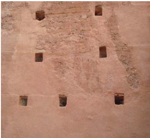
Figura 9.62. Detalle del estado actual de las superficies de la torre.
