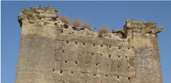
Figura 3.46. Coronación protegida con verdugadas de ladrillo y su proceso de erosión (Muralla de Castro del Río, Córdoba).
