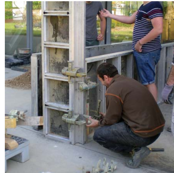
Figura 3.15. Encofrado metálico para la ejecución de un muro de tapia durante los talleres del Festival Grains d'Isère. Le Grands Ateliers. Villefontaine (Francia).
