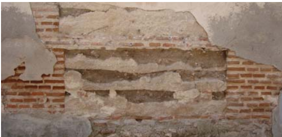
Figura 3.61. Ejemplo de degradación de un cajón de tapia calicostrada (Edificio residencial en Arévalo).
