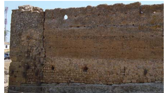
Figura 3.44. Estado de conservación de un muro de tapia construido sobre un zócalo de mampostería (Alcazaba de Carmona).
