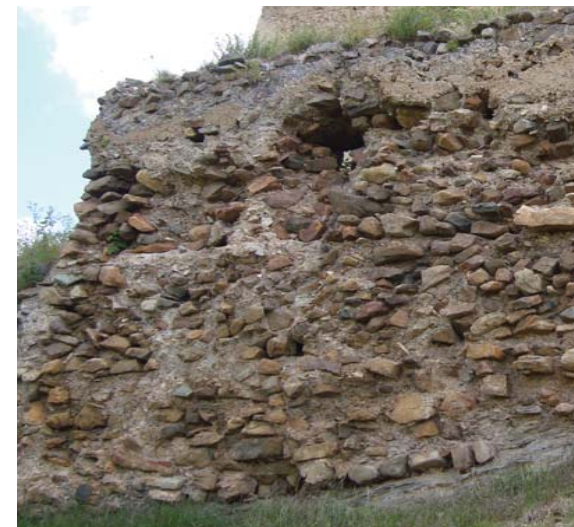
Figura 3.56. Ejemplo de erosión superficial de un muro de tapia con mampuestos en el interior (Castillo de Yanguas, Soria).
