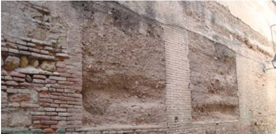
Figura 3.60. Ejemplo de degradación de un cajón de tapia de tierra (Muralla de Córdoba).
