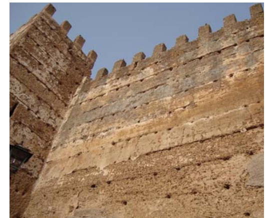
Figura 9.39. Imagen actual de los lienzos de muralla en las que se detectan intervenciones puntuales de reintegración de superficies.
