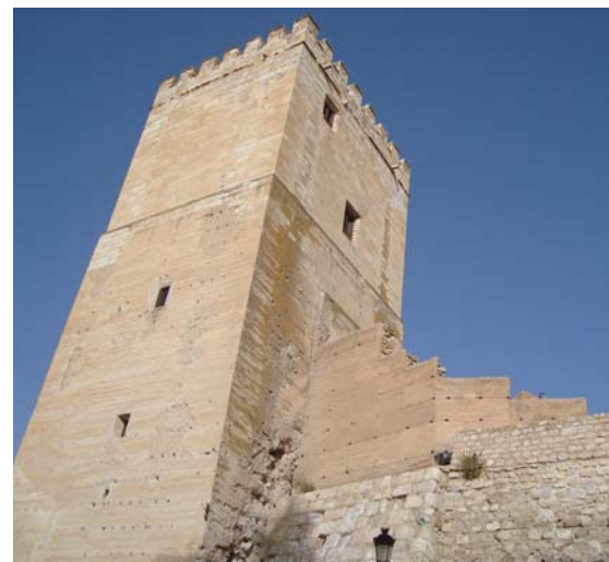
Figura 7.7. Imagen actual de la Alcazaba de las siete torres de Orce en la que se pueden ver zonas intervenidas con tapia y otras con mampostería.
