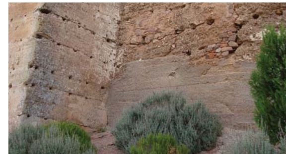
Figura 9.41. Detalle de la zona inferior de la muralla con reparaciones anteriores realizadas con morteros cementosos.
