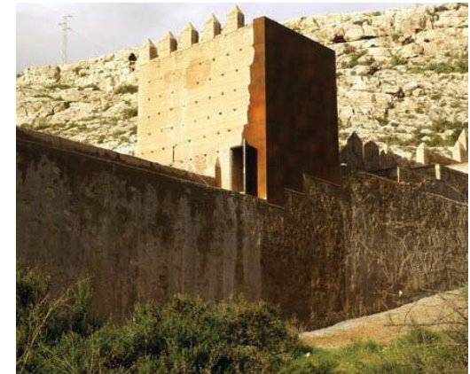
Figura 8.16. Imagen de una de las torres de la Muralla de la Hoya en Almería, en la que se aprecian manchas de óxido producidas por el acero corten de la intervención (imagen de la web www.amigosdelaalcazaba.es ).
