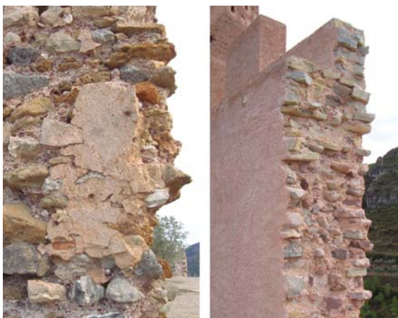
Figura 9.64. Iz: Detalle de un tramo de muralla que ha perdido prácticamente toda la capa superficial (imagen de la autora). Der: Sección del tramo de muralla reconstruido.
