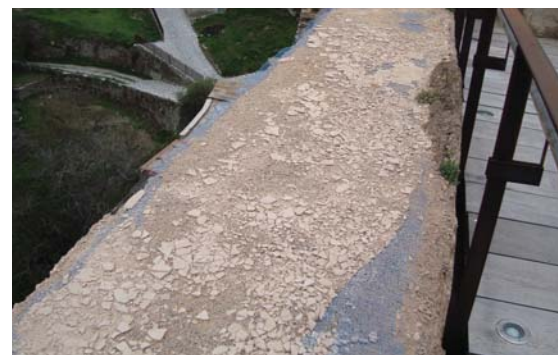
Figura 7.46. Imagen del estado actual de las coronaciones de los muros en el Castillo de Bcares (Almería).
