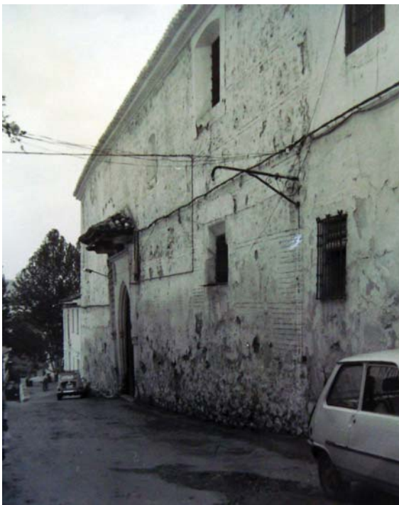
Figura 5.26. Imagen del Convento de Santa Clara de Loja antes de la intervención (extraída del expediente PI 0088.04 del archivo del IPCE).
