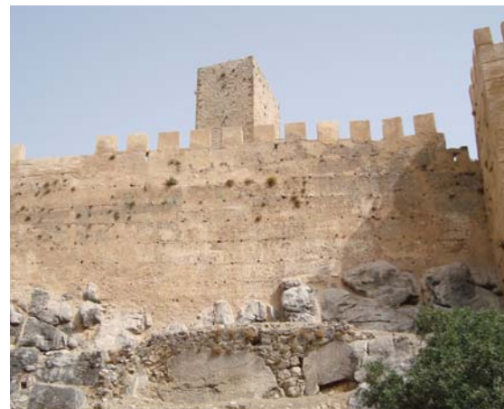
Figura 9.67. Sup: Estado previo a la intervención de uno de los lienzos de muralla (imagen de la documentación fotográfica del proyecto de 2006, arquitectos Carlos Porrás Funes y Clemente Porrás Funes). Inf: Estado actual del mismo lienzo de muralla tras la intervención en el que se propone la recuperación de las almenas, excepto las que están totalmente desaparecidas.
