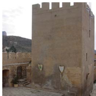
Figura 9.19. Imagen de la Torre del Homenaje antes de la intervención (base de datos del Ministerio de Fomento).
