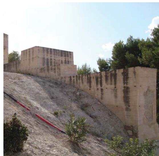
Figura 8.11. Imagen actual del Castillo de Moratalla en la que se aprecian las manchas de suciedad producidas por las agujas que generan puntos de escorrentías superficiales de agua desde la coronación.
