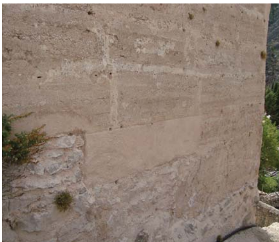
Figura 9.66. Muro de tapia sobre basamento de mampostería que se adapta a la pendiente del terreno sobre el que apoya.
