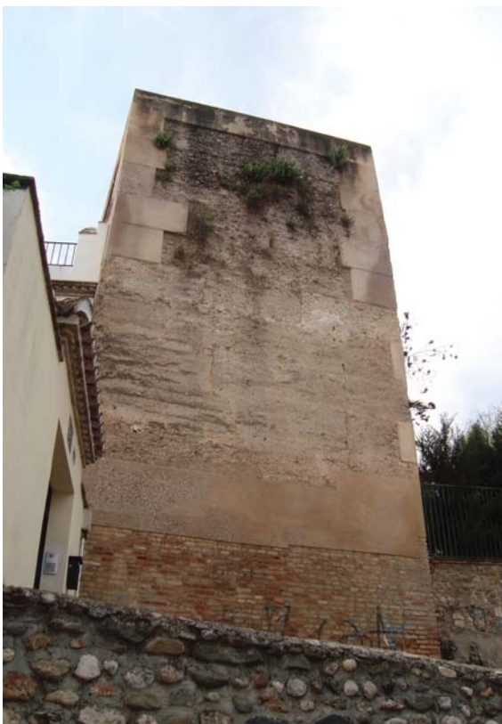
Figura 6.40. Imagen actual de la Torre de la Alcazaba Qadima de Granada después de la intervención.
