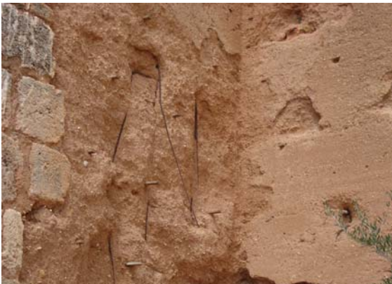
Figura 8.4. Imagen actual de la Muralla de Niebla, en la que se aprecia que se han producido desprendimientos superficiales quedando vistas las armaduras de acero liso empleadas en la unión.
