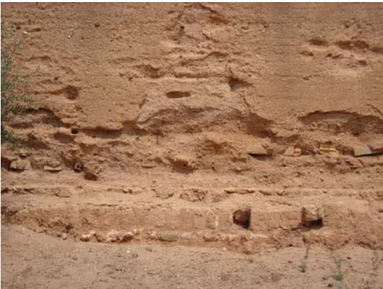
Figura 8.14. Imagen actual de la Muralla de Niebla en la que se aprecian ladrillos empleados en la unión del material preexistente con el de la intervención, tras la erosión y el desprendimiento de las superficies.
