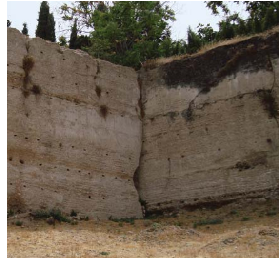
Figura 3.63. Ejemplo de discontinuidad estructural debida a la falta de traba entre dos paños de muro (Muralla del Albaicín de Granada).
