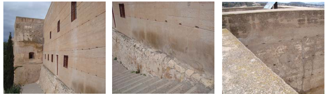
Figura 9.17. Imágenes de la muralla en las que pueden apreciarse las patologías actuales que la afectan.
