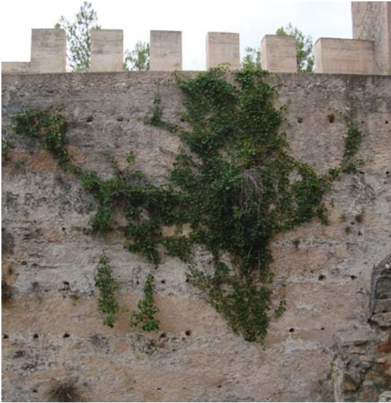
Figura 8.7. Imagen actual de la Muralla de Xàtiva en la que se aprecia la vegetación por la que está afectada.
