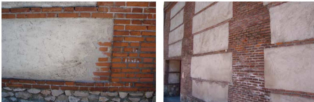
Figura 9.46. Imágenes actuales de detalle de la zona de muralla que se restaura con esta intervención. Actualmente es posible ver que esta intervención se realizó también con fábrica de ladrillo, ya que en una de las esquinas de la tapia inferior se ha desprendido el revestimiento debido a la humedad y es posible ver la fábrica.
