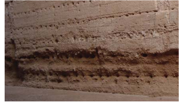
Figura 3.43. Erosión y pérdida de material en la base del muro de muralla en Córdoba.
