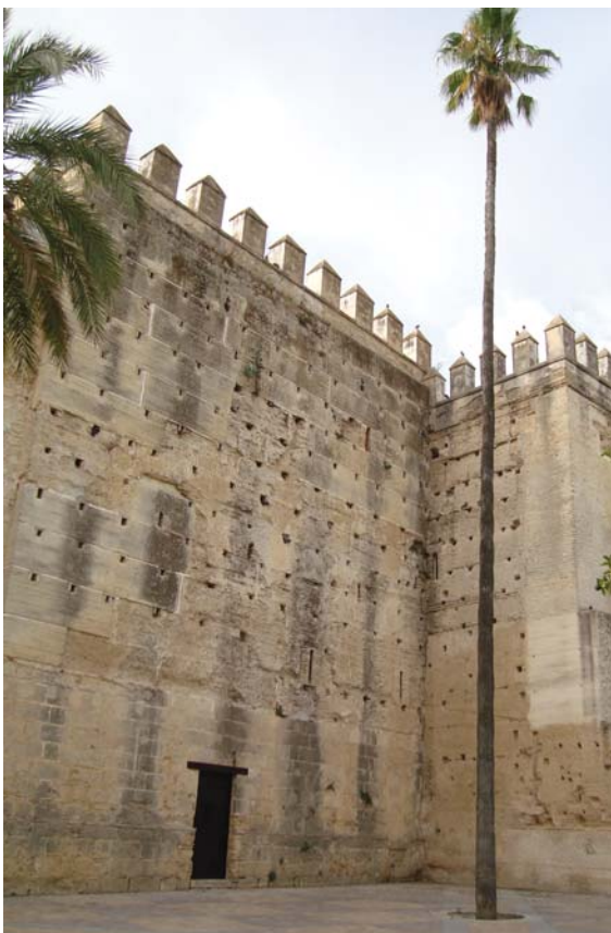
Figura 6.7. Imagen del estado actual de una de las torres del Alcázar de Jerez de la Frontera.
