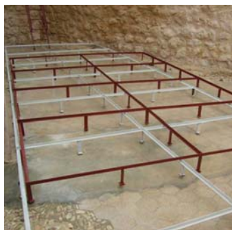
Figura 9.20. Imagen del montaje de la estructura del pavimento (base de datos del Ministerio de Fomento).
