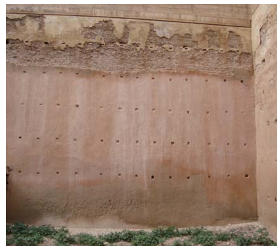
Figura 9.4. Imagen de una de las zonas intervenidas en las décadas anteriores a los ochenta. Enlucido con mortero de cemento y reproducción de los mechinales.
