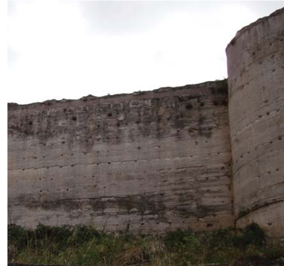
Figura 3.49. Patologías superficiales que afectan la Muralla de la Alcazaba Qadima de Granada (vegetación, humedades, erosión superficial...).
