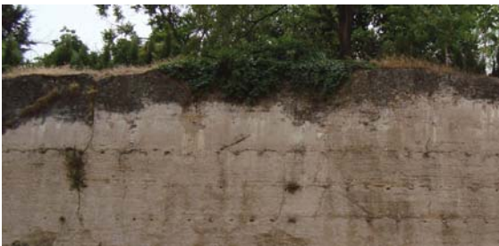
Figura 3.48. Crecimiento de vegetación en la coronación del muro debido a los agentes atmosféricos (Muralla del Albaicín, Granada).
