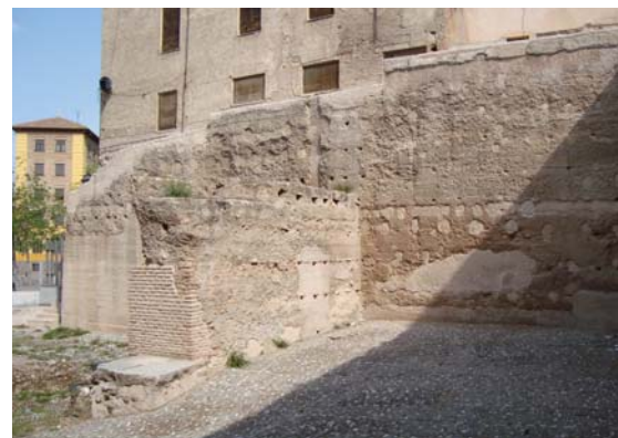
Figura 7.45. Imagen de la solución de las coronaciones de los muros en la Puerta de Elvira (Granada).
