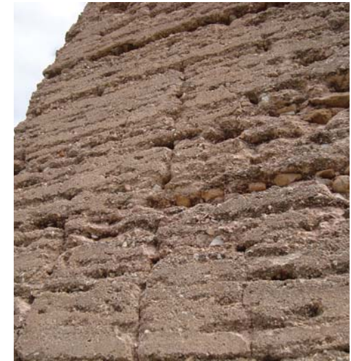
Figura 3.54. Imagen de la degradación superficial en las zonas críticas (juntas entre cajones y tongadas) en un muro de tapia con mampuestos (Torres de Sta Catalina, Orcera).
