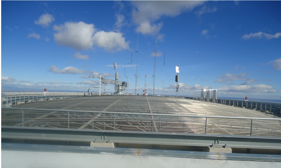
Figura 6.15: Panorámica de la azotea destacando la extensa zona central diáfana cubierta por el entramado metálico (Fuente: propia)
