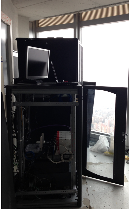
Figura 6.26: Sala técnica que alberga el “rack de comunicaciones” en la planta 55 de Torre Espacio (Fuente: propia)
