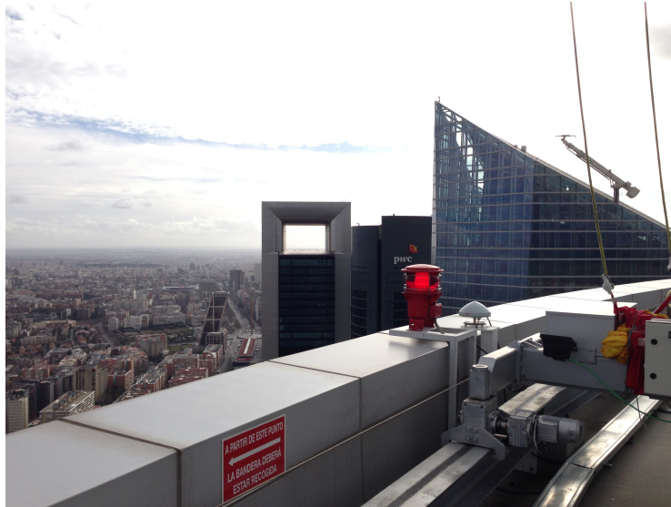
Figura 6.36: Antena GNSS 2 sobre pilar metálico en la azotea de Torre Espacio (Fuente: propia)
