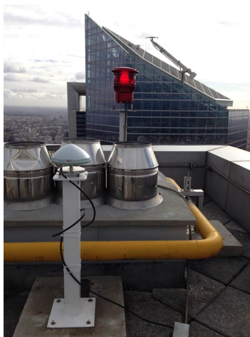
Figura 6.23: Antena GNSS 3 sobre pilar metálico en la azotea de Torre Espacio (Fuente: propia)
