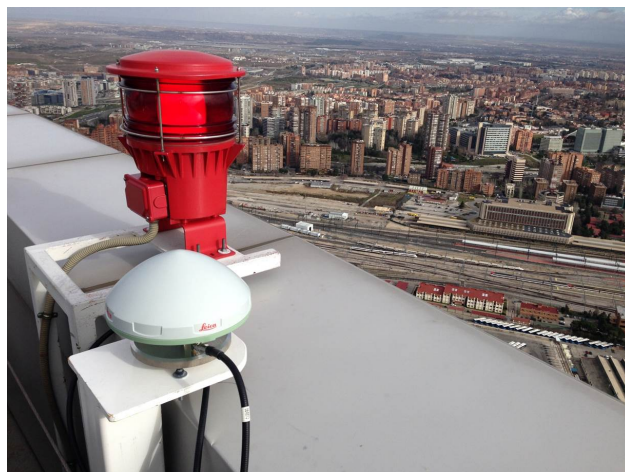
Figura 6.22: Antena GNSS 2 sobre pilar metálico en la azotea de Torre Espacio (Fuente: propia)
