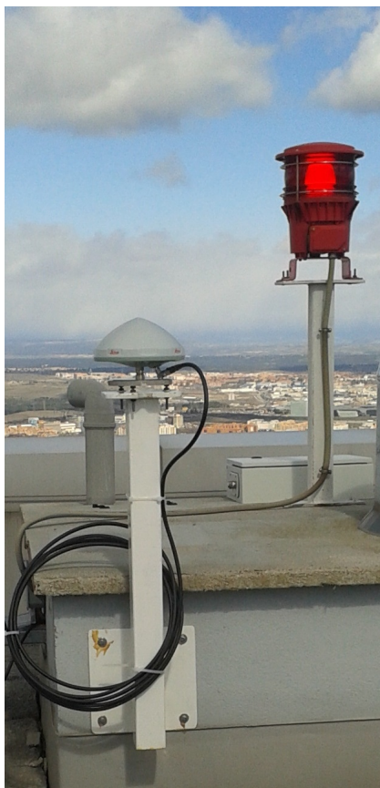
Figura 6.21: Antena GNSS 1 sobre pilar metálico en la azotea de Torre Espacio (Fuente: propia)
