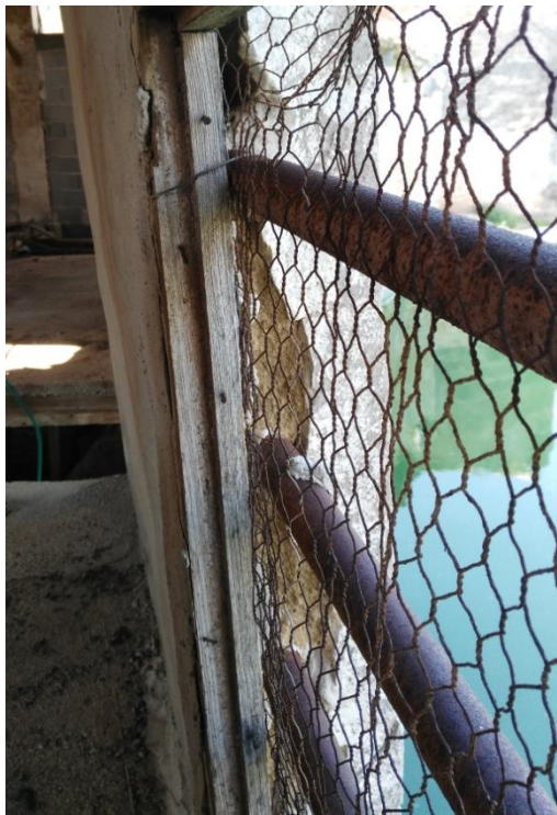
Ilustración 71. Oxidación en elementos de cerrajería exterior.
