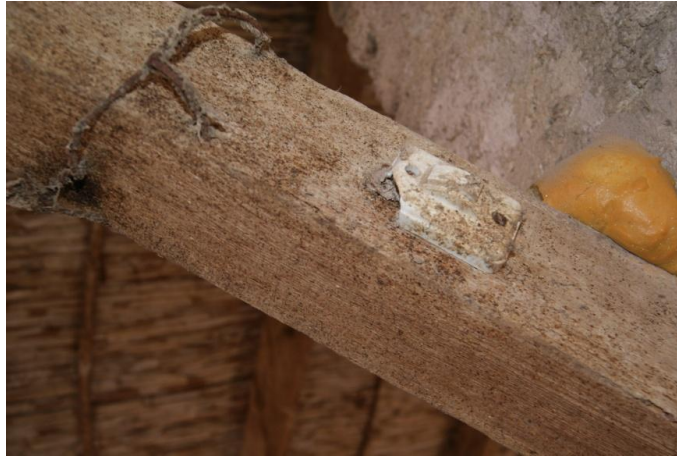
Ilustración 72. Estado de la madera de de los corrales
