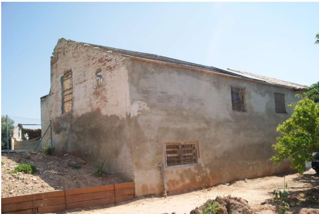
Ilustración 66. Fachada sureste con humedades por capilaridad
