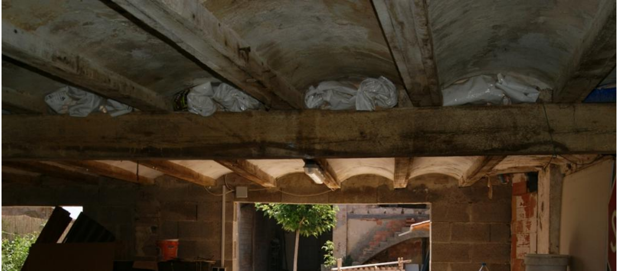
Ilustración 67. Humedad en la parte inferior del forjado.
