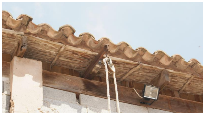
Ilustración 73 Cambio de tonalidad en viga de madera por humedad. Fuente: Propia
