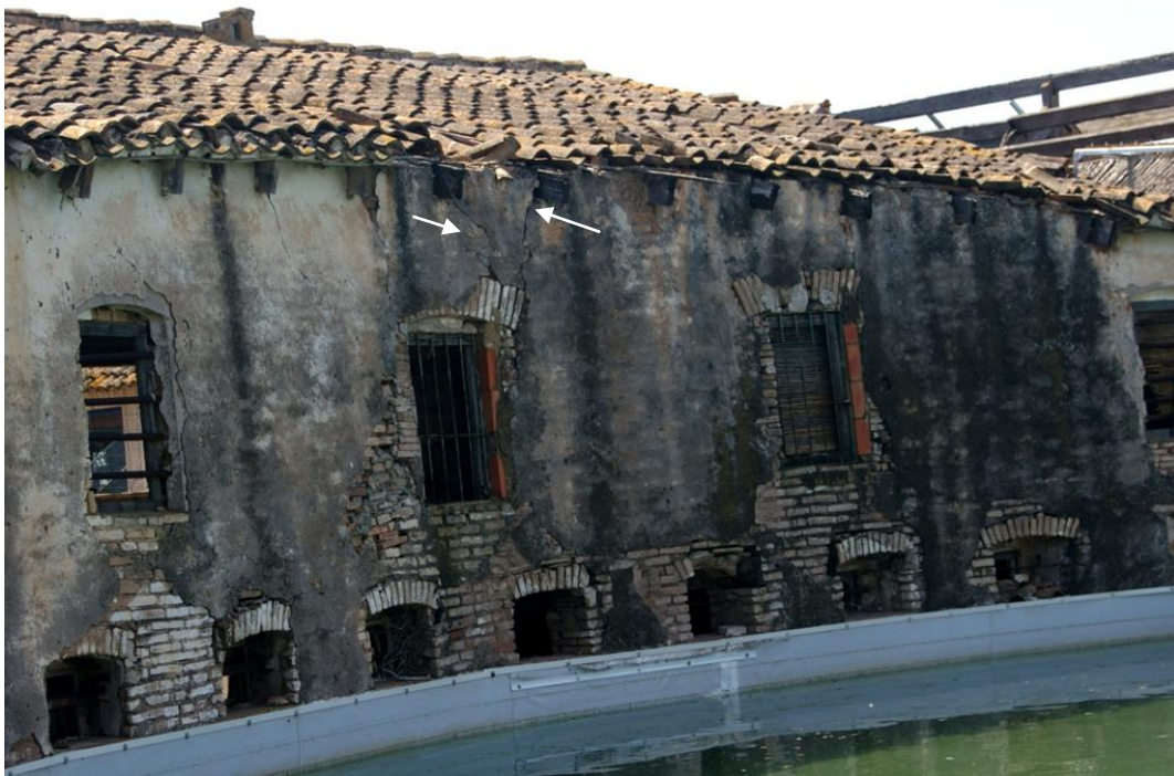
Ilustración 68. Grietas en fachada noroeste.
