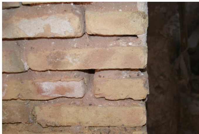
Ilustración 74. Pilares con arenización de mortero
