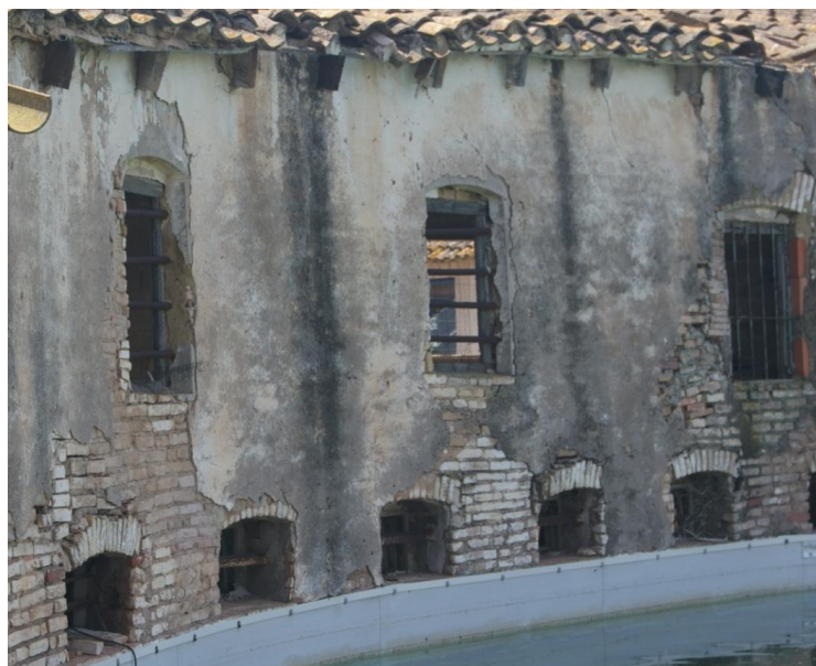
Ilustración 70. Desprendimiento revestimiento de fachada con manchas de humedad. Fuente: Propia autora
