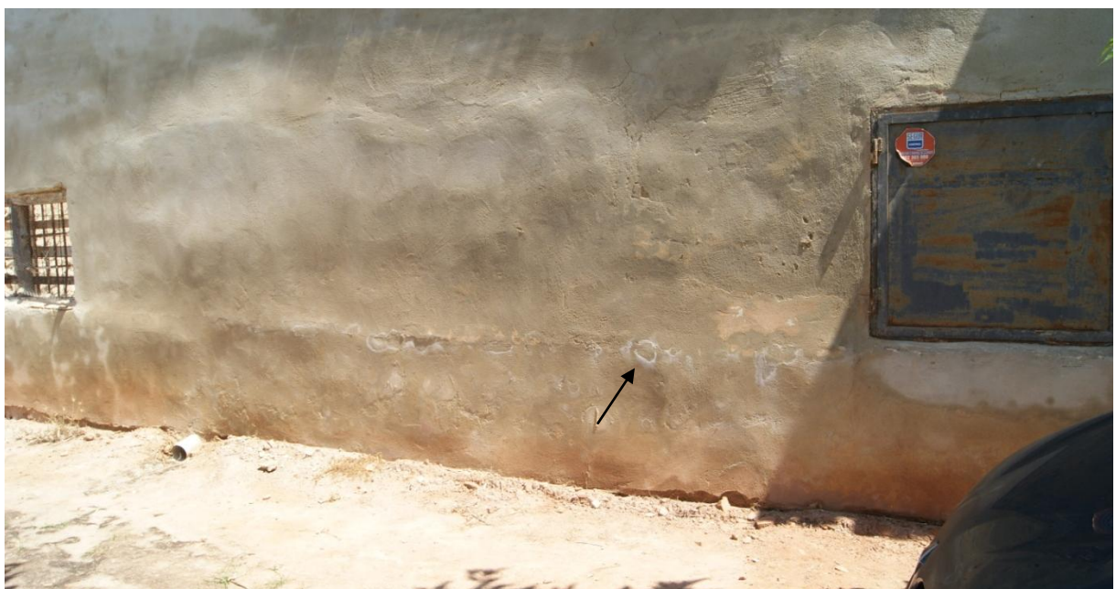
Ilustración 69. Eflorescencias en fachada Sureste.
