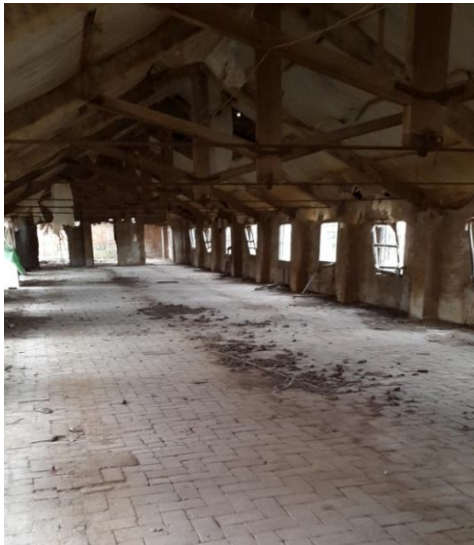
Ilustración 64. Ejemplo de pavimento antes de ser desmantelado. Fuente: Propia.
