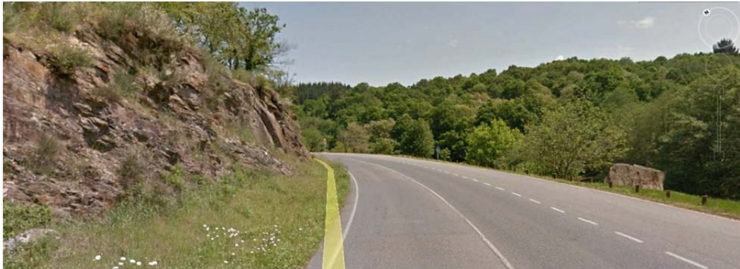
Figura 102: Caso analizado: desmonte en el interior de una curva en la carretera CP-29-25.
