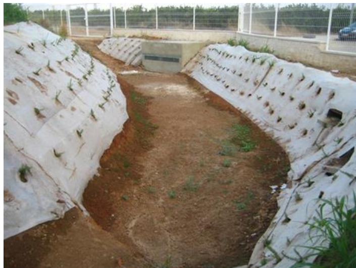
Retention-infiltration basin in Xàtiva (Valencia).
