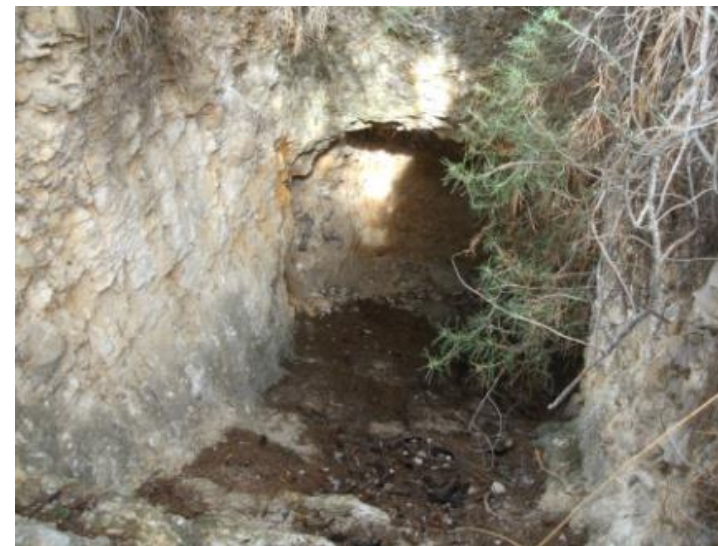
Figura 96. Estructura subterránea con erosión de escalones, acumulación de tierras e invasión de vegetación en el km 11 de la CV-35.
