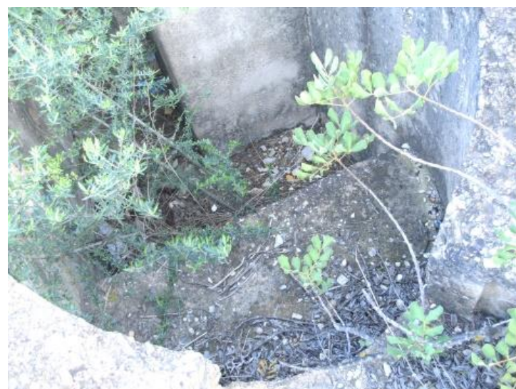
Figura 92. Casamatas con presencia de costra biótica e invasión de vegetación en el km 11 de la CV-35.
