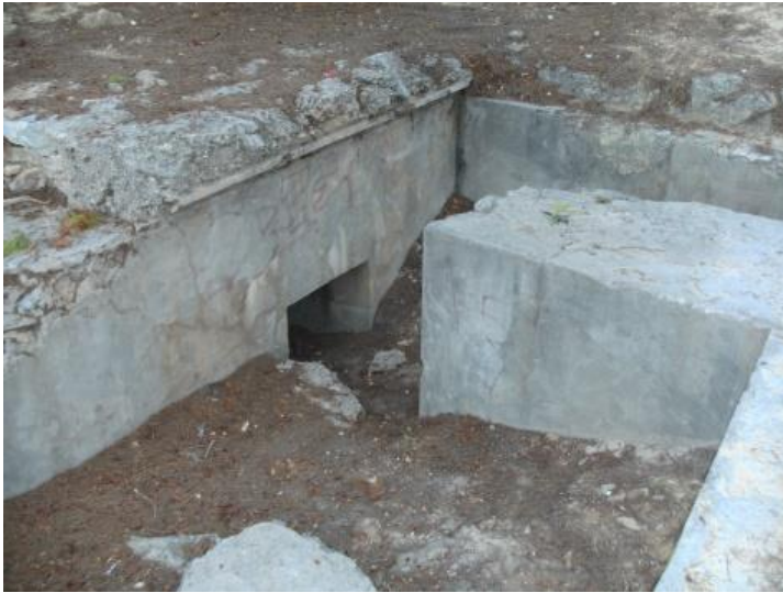
Figura 85. Exterior de casamata con microfisuración en La Vallesa.
