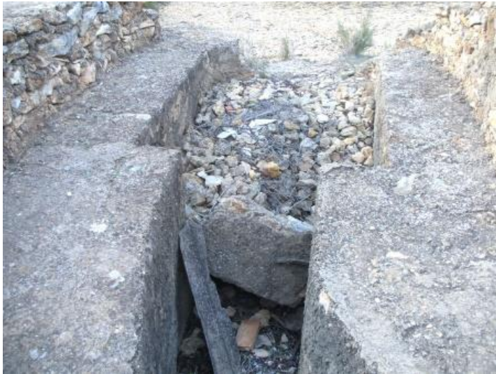
Figura 83. Parapeto ondulado con presencia de costra negra en La Vallesa.
