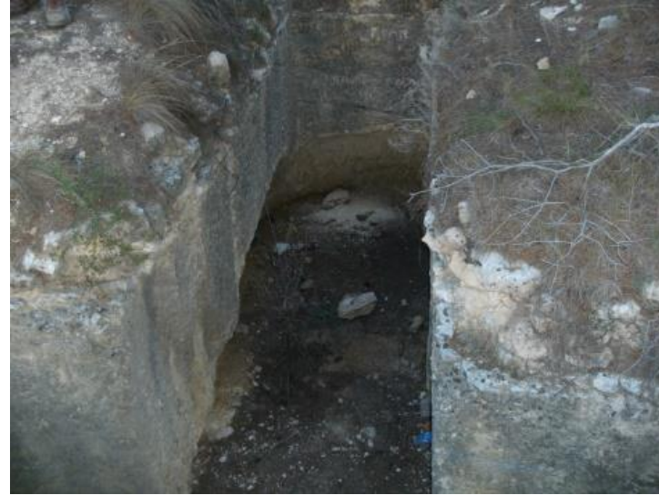
Figura 91. Abrigo bajo parapeto con derrumbes en La Vallesa.
