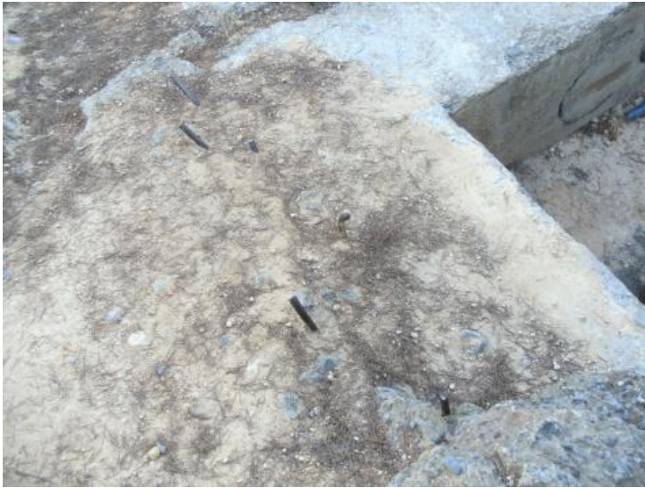
Figura 93. Armaduras de acero oxidadas en La Vallesa.
