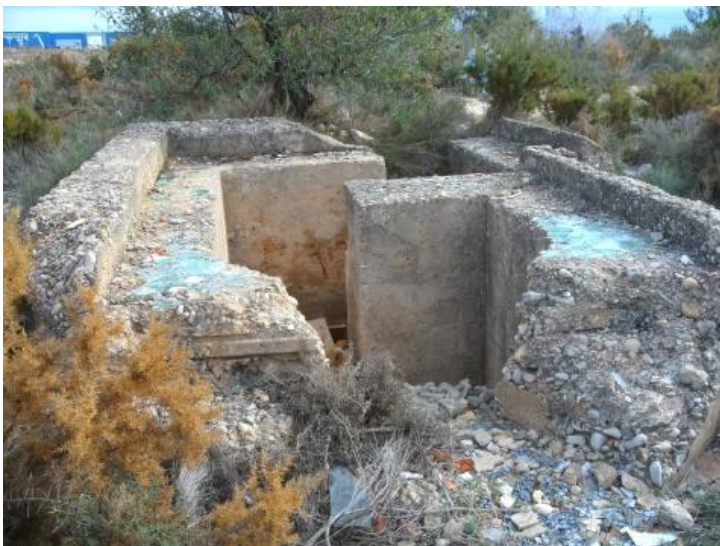
Figura 94. Casamata con fisuración y pérdida de material en el km 11 de la CV-35.
