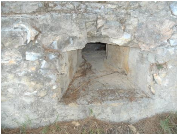
Figura 86. Tronera con falta de mampuestos en La Vallesa.
