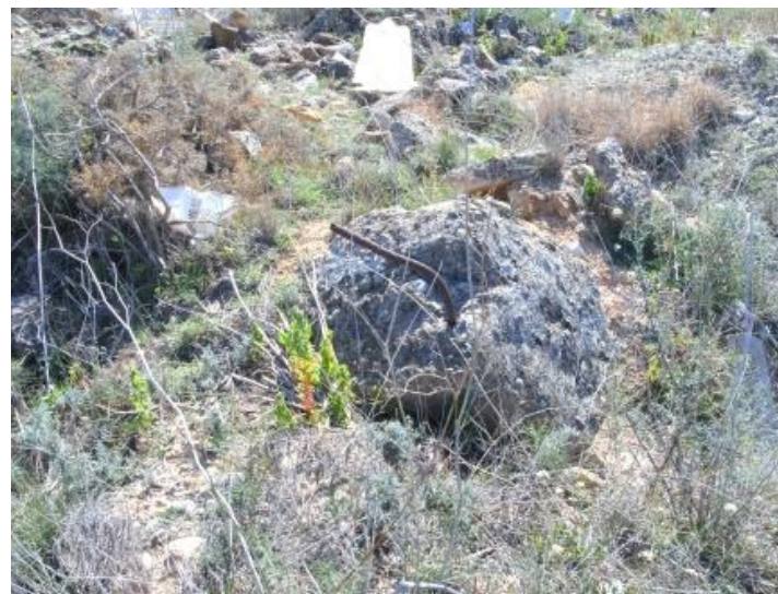
Figura 67. Restos de hormigón con presencia de armaduras de acero.
