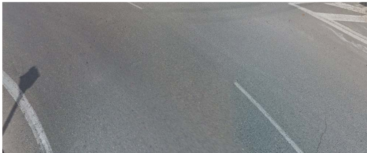
Fig. 5 Estado actual del pavimento
