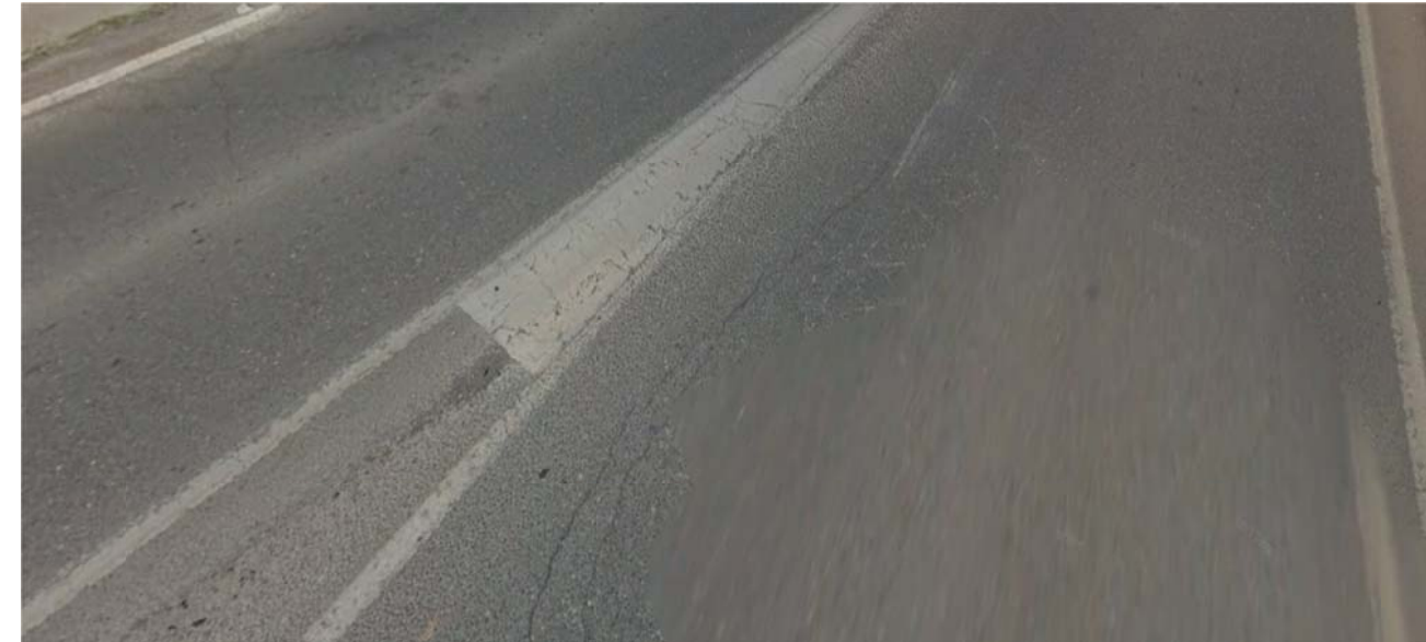
Fig. 6 Estado actual del pavimento
