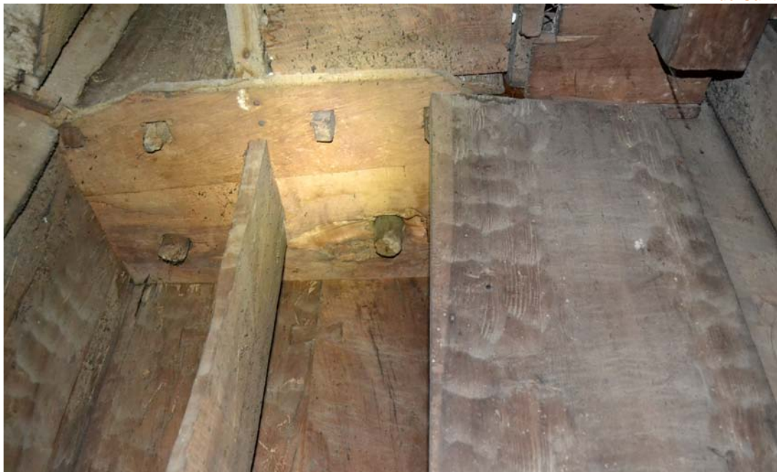
Tauló de fusta situat verticalment per suportar la càrrega d'un element més avançat, Retaule de Sant Ruf
