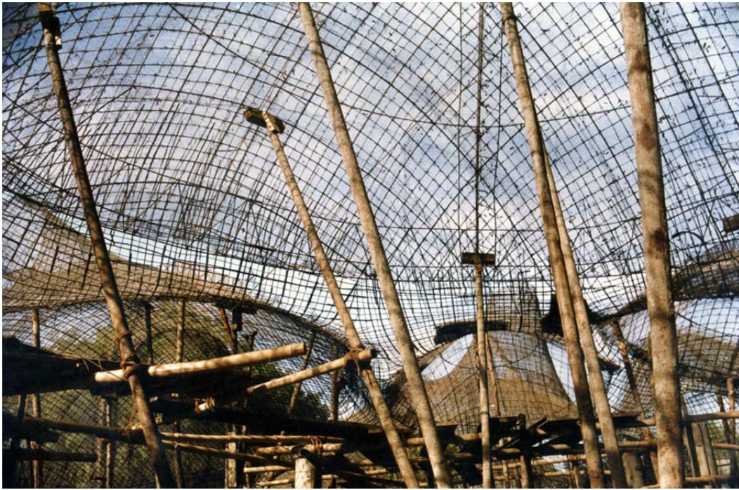
Fig. 33 Construcción de la galería de arte Husain Doshi Gufa. Fotografías cortesía de B. Doshi.
