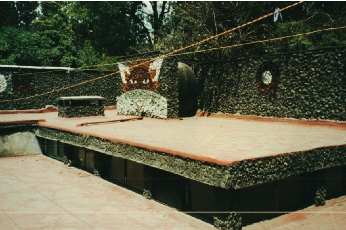
Fig. 74-75 Terraza y acceso dela casa de Colon Nancarrow. Proyecto de Juan O'Gorman. (1947) Fotografías cortesía de Víctor Jiménez
