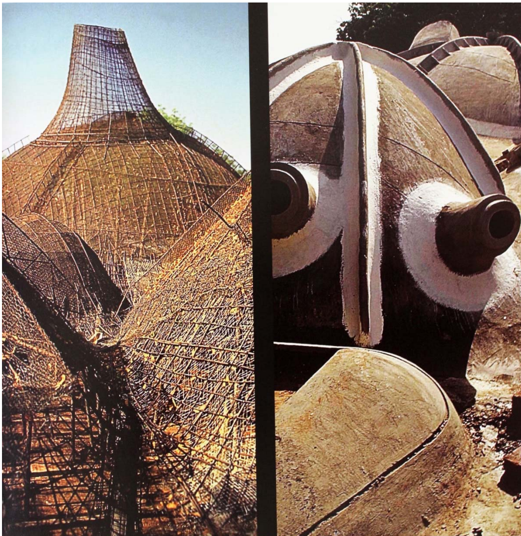
Fig. 34 Construcción de la galería de arte Husain Doshi Gufa. Fotografías cortesía de B. Doshi.
