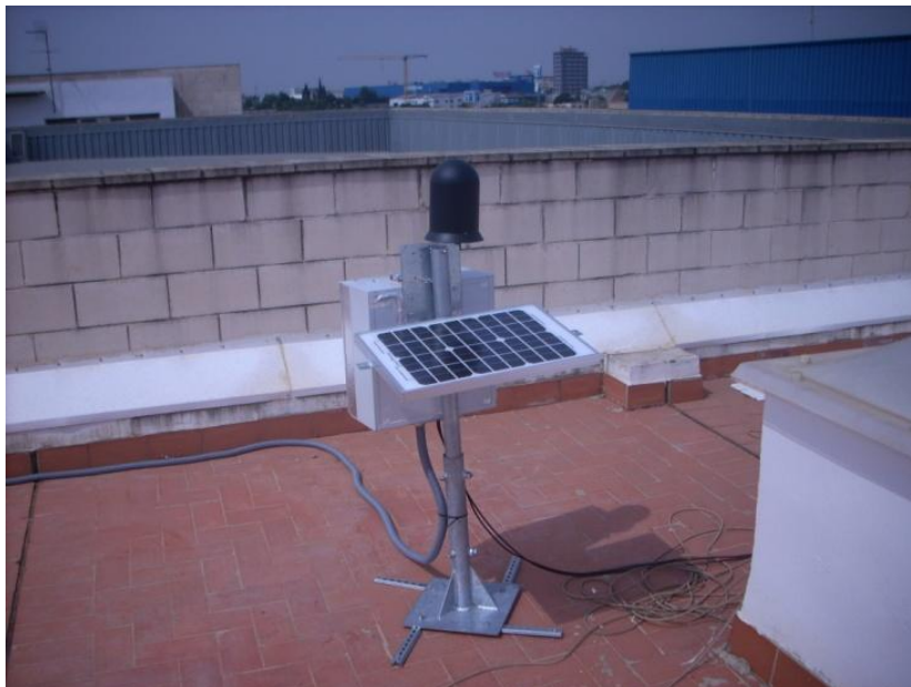
Figura 4.12. Primer prototipo instalado en entorno real (Aplicaciones Tecnológicas S.A.)
