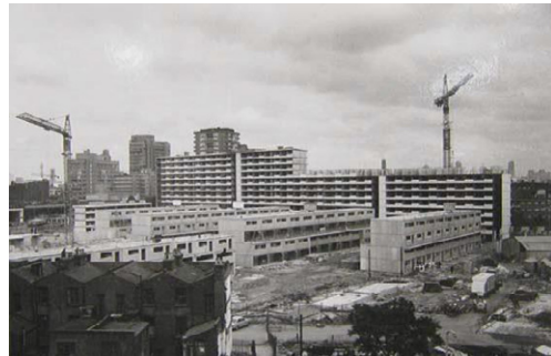
Arriba: Vista de Bing Maps. Sobre estas líneas: Fotos de la Heygate en construcción. Southwark archives. Extraídas de "Heygate Estate. History building record". Página 22. Reproducido con permiso de Southwark Archives y Purcell Miller Tritton LLP.
