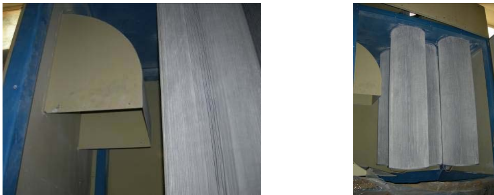
Figura 55. Detalle cámara filtrante.
