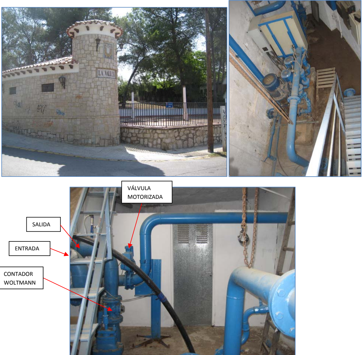
Ilustración 10 : Imágenes del depósito de La Vallesa y de los equipos electromecánicos.
