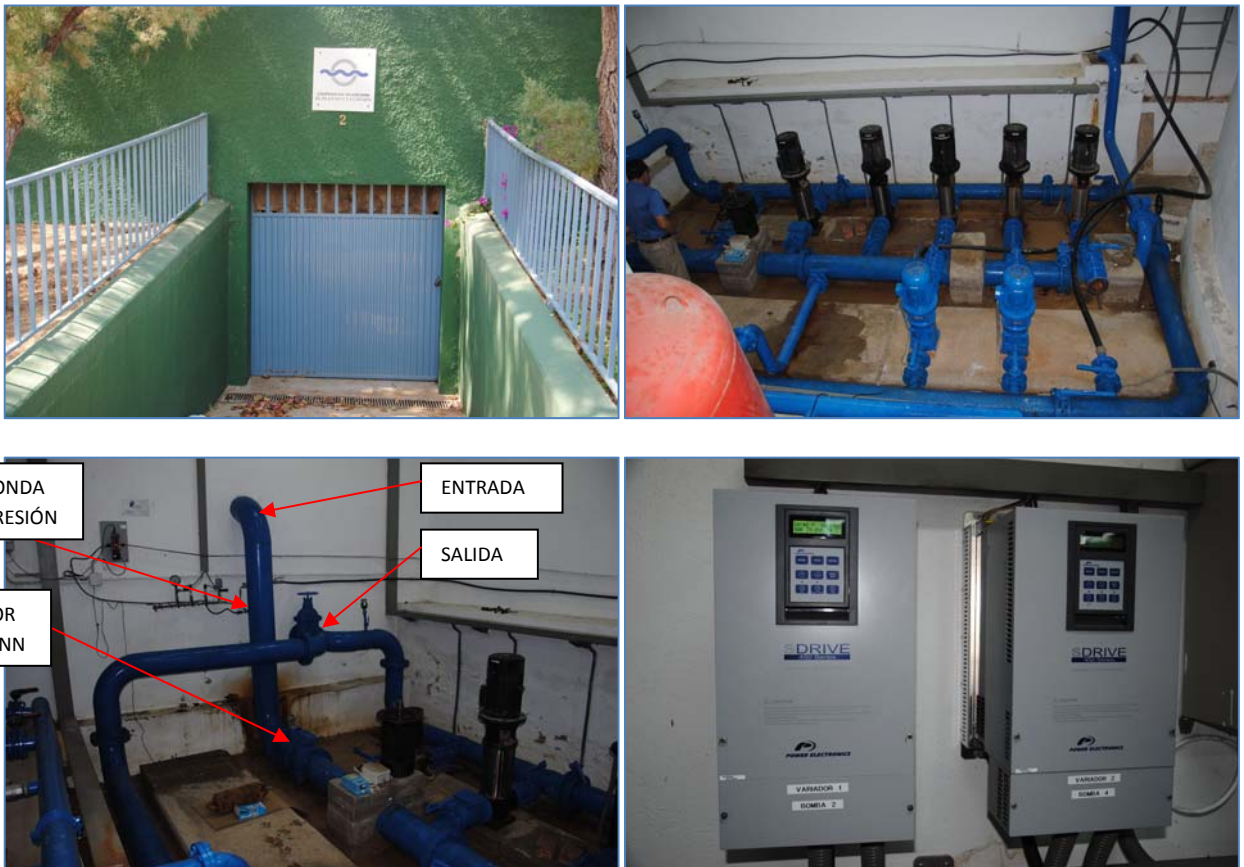
Ilustración 5 : Imágenes del depósito de Colinas y de los equipos electromecánicos.
