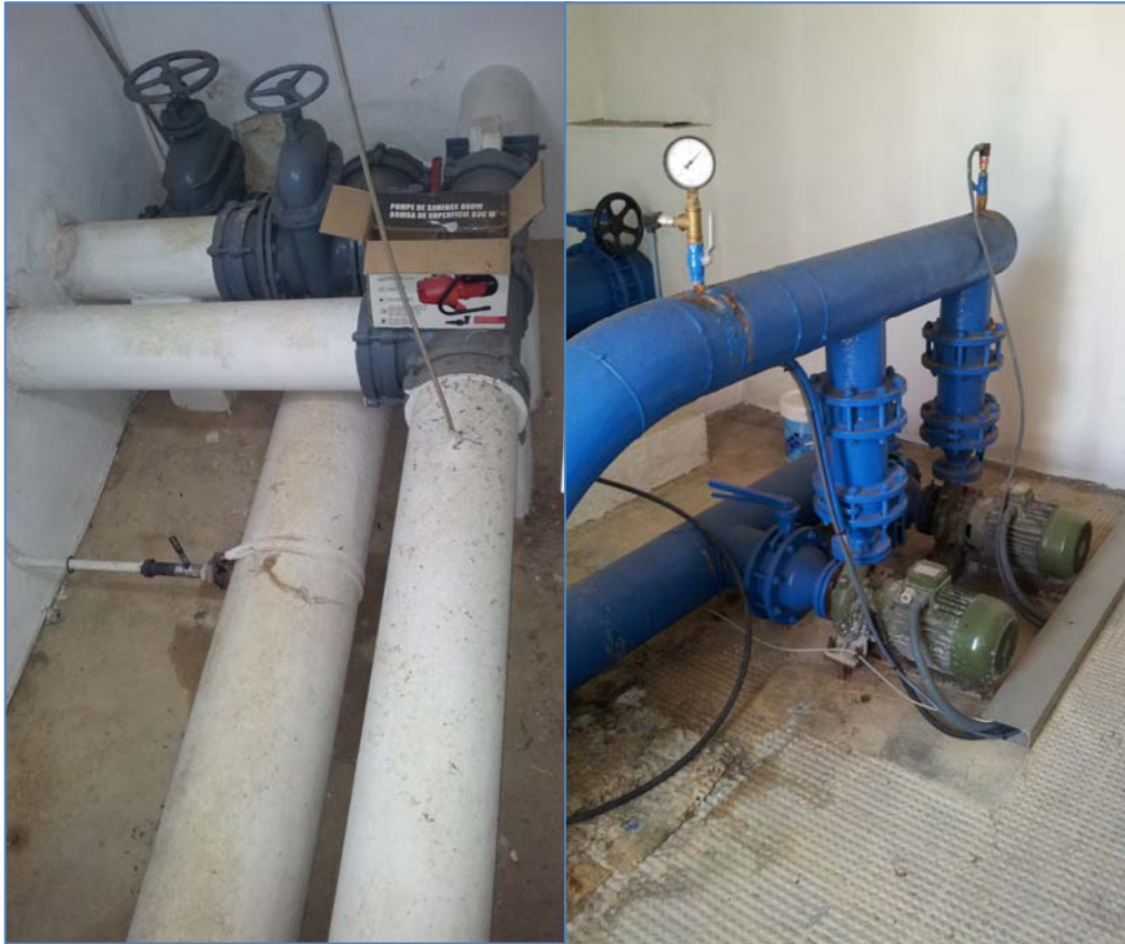
Ilustración 6 : Tuberías de entrada e interconexión de El Plantío viejo y grupo de presión que alimenta la urbanización adyacente.
