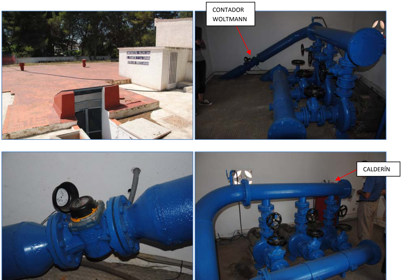
Ilustración 11 : Imágenes del depósito de Montecañada y de los equipos electromecánicos.
