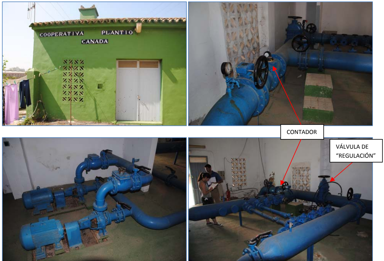
Ilustración 8 : Imágenes del pto. de producción de Sta. Bárbara y de su instrumentación.
