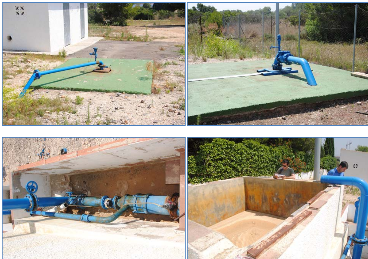
Ilustración 14 : Imágenes de los Pozos del Pla 2 y 3 y del desarenador
