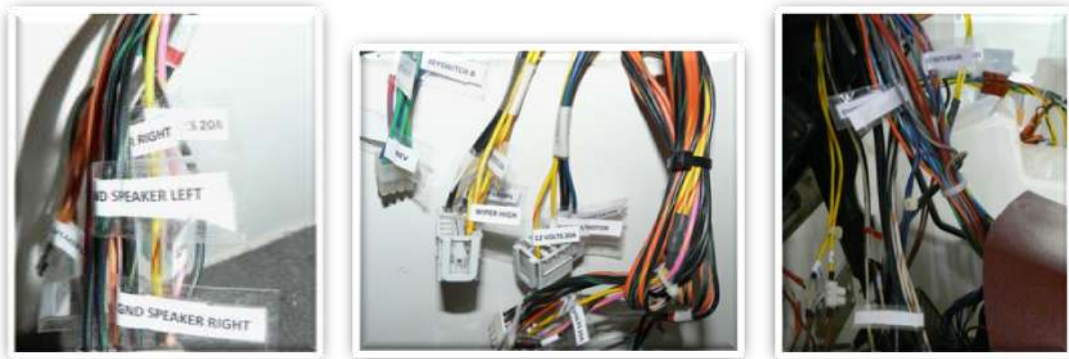
FIGURA 12: ETIQUETAS COLOCADAS EN LOS DISTINTOS CABLES
