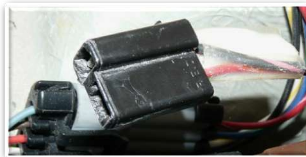
FIGURA 35: CONECTOR DE BATERÍA DE SERVICIOS AUXILIARES
