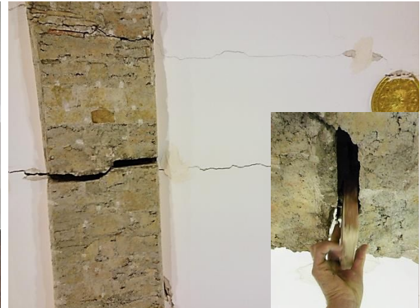
Figura 29: Grieta de 15cm de profundidad. Retacado.
