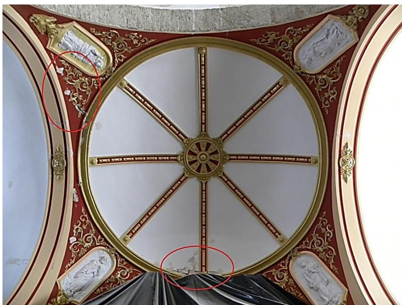
Figura 24: Principales daños detectados en el intradós de la cúpula.
