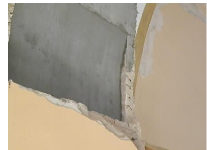
Figura 32: Cajeadado en arranque de arco.
