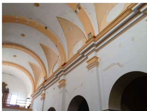
Figura 19: Lesiones de esfuerzo cortante en los muros de la nave central.
