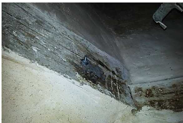
Figura 79: Detalle de refuerzo en el zuncho perimetral interior del cuerpo de campanas.
