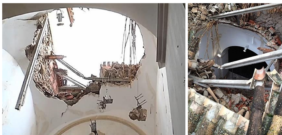
Figura 5: Vista interior y exterior de la cúpula derruida.
