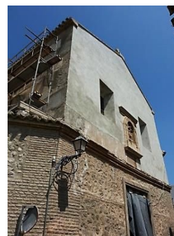
Figura 99: Fachada SW. Enlucido.
