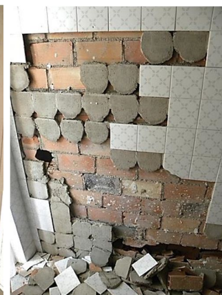
Figura 15: Desperfectos en acabados.
