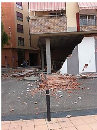
Figura 13: Daños en fachada de Planta Baja.
