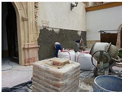
Figura 13: Enfoscado de mortero de cemento en el zócalo exterior.
