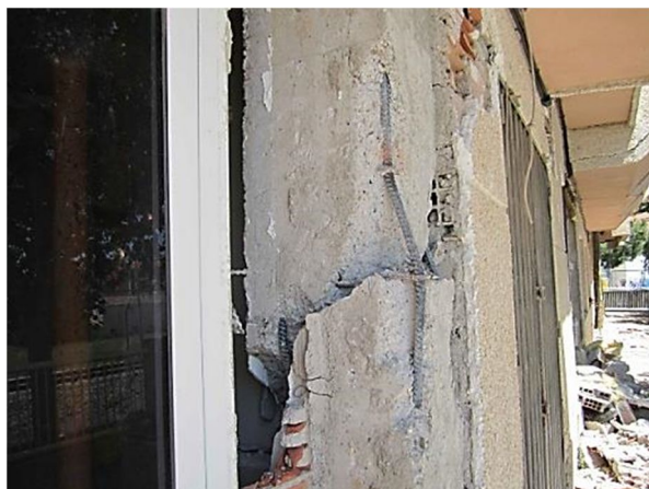
Figura 11: Pilar con rotura y desplazamiento.
