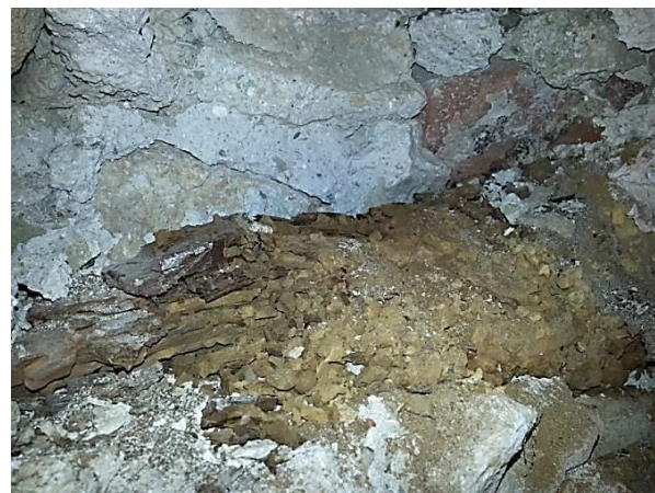
Figura 69: Pudrición de apoyo de madera.
