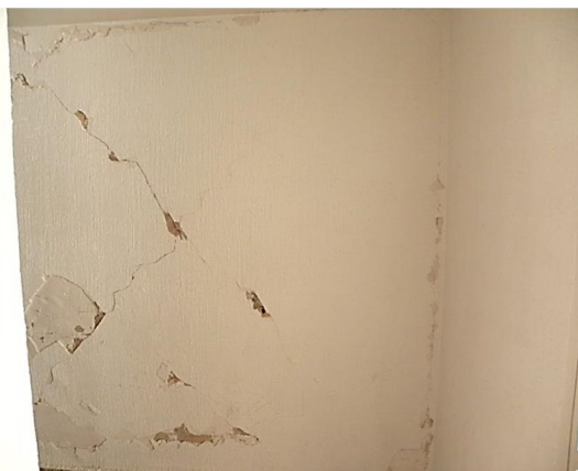
Figura 14: Daños en tabiquería de viviendas.
