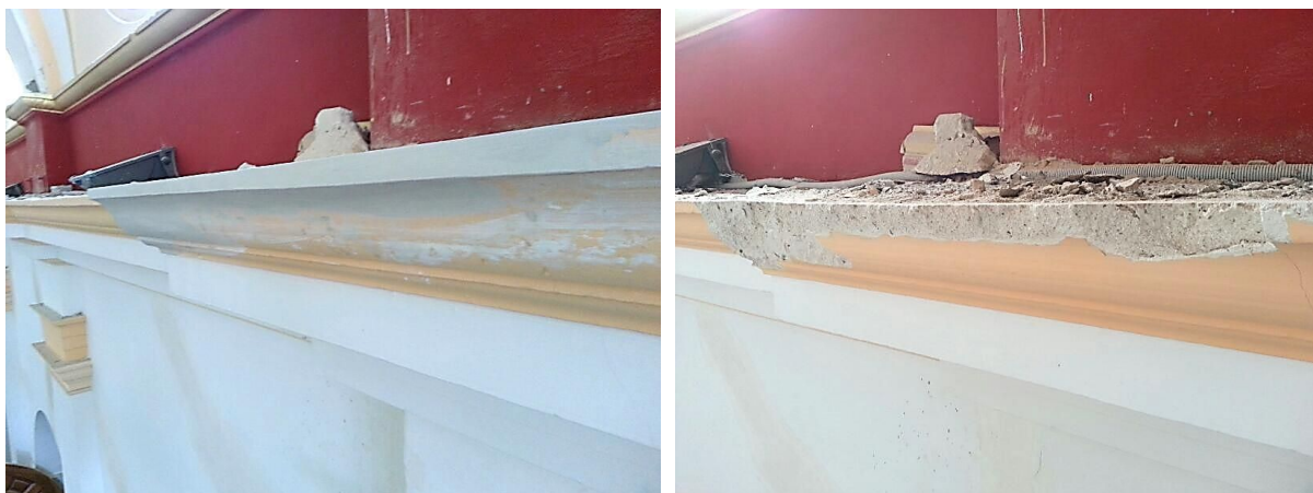
Figura 52: Recuperación de molduras en el interior de la Iglesia de San Cristóbal.
