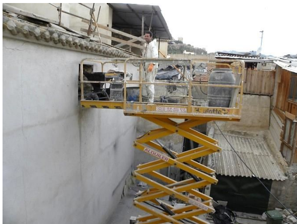
Figura 111: Plataforma exterior de apoyo de bomba de inyección.
