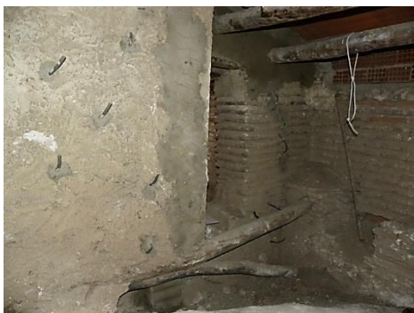
Figura 2: Detalle de los rollizos de madera sustentando la ampliación del contrafuerte.
