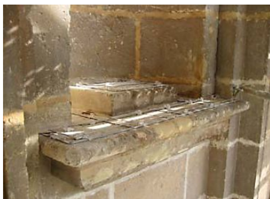
Figura 9: Sistema electrostático antipalomas colocado en una fachada pétrea..
