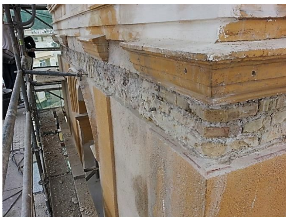
Figura 62: Picado del revestimiento de las fachadas del campanario, en la zona de colocación de bandas.
