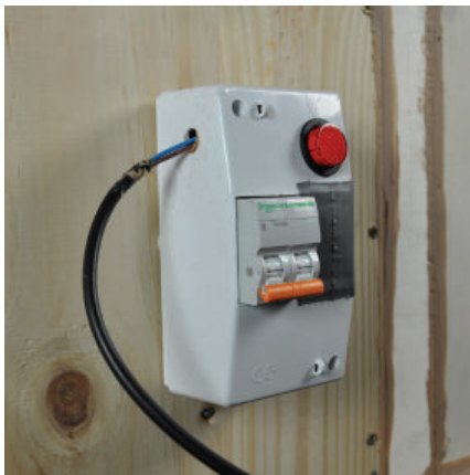
Figura 2.2.4.2: Caja de conexiones.
