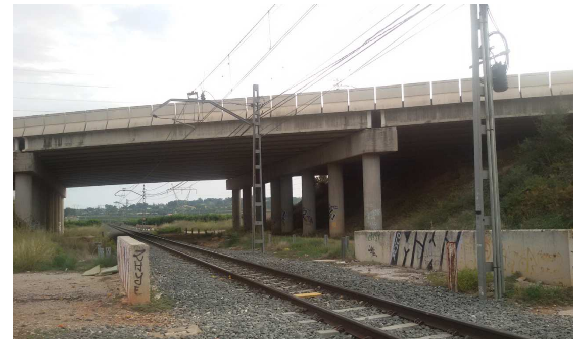
Foto 22: Antiguo paso a nivel camino Garrofera Guaita (P.K 7+127)
