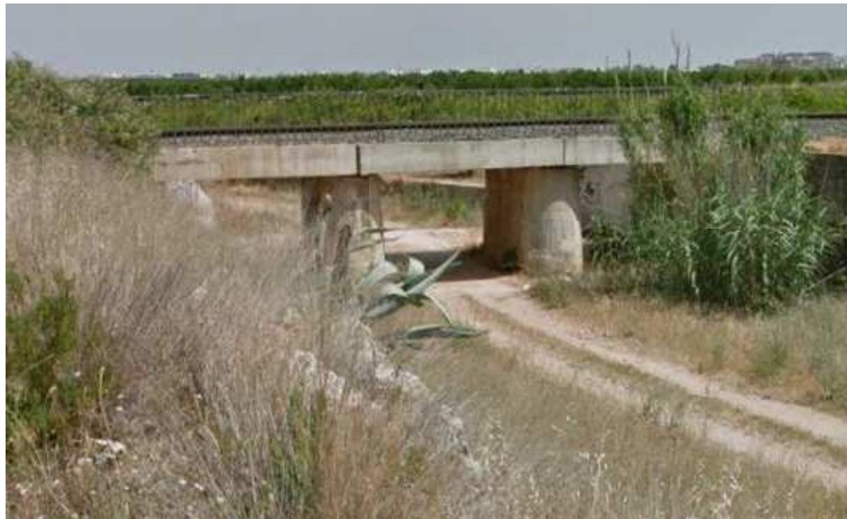
Foto 23: Barranco cañada del Alcadet (PK 7+454)
