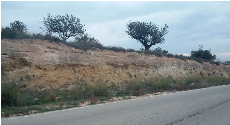
Figura 5. Desmonte afectado por fuerte erosión superficial en vial urbano, Paterna (Valencia)
