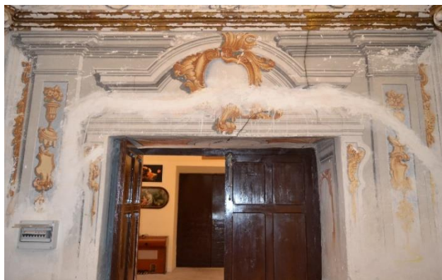
Ilustración 33. Puerta de acceso. Daños y decoraciones.
