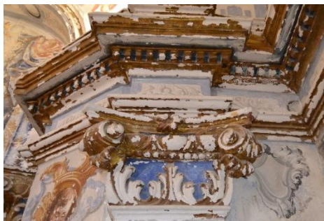
Ilustración 41. Capitel donde se aprecia el oro afectado.
