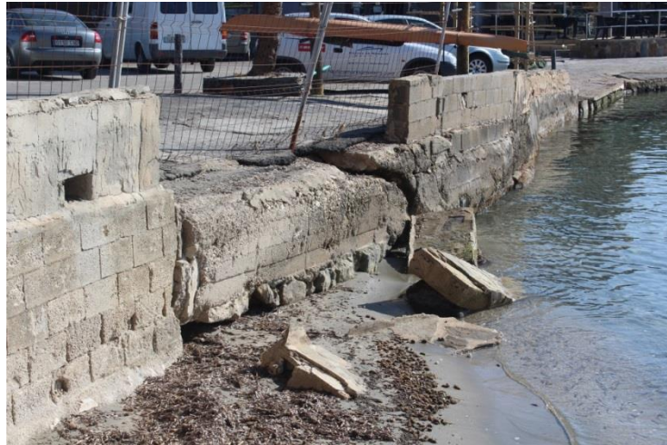
Figura 3. Estado actual del muelle exterior
