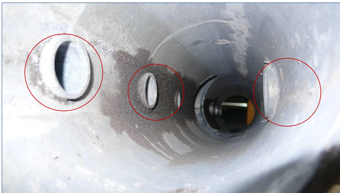
Fotografía 39: Hidrante 8. Estado interior sección 1, se observa la inserción de los tubos que configuran las salidas y la conexión de la ventosa.
