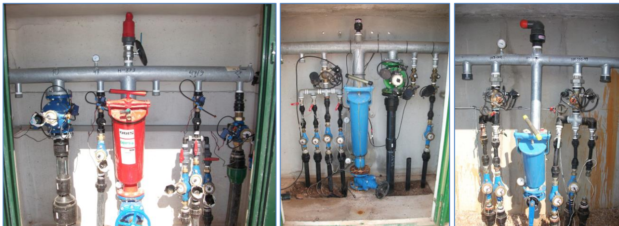
Fotografía 2-10: Hidrante vertical V2-1-1. C.R. de Castellón, Nules y Villareal 2010. Tipo 3. (Fotos Miranda M.). Contadores agua abajo lo que permite que se vacíen después del riego. Filtro de malla mal colocado, ventosa en algunos hidrantes sin válvula de aislamiento.
