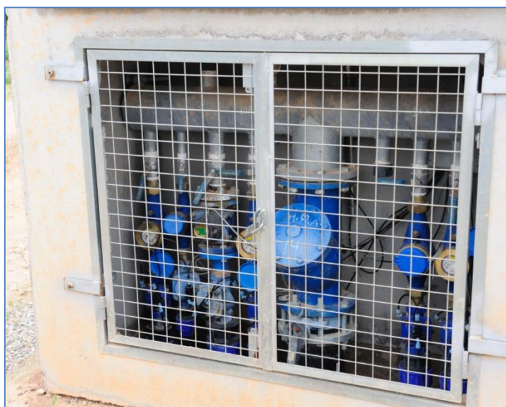
Fotografía 67: Hidrante con toma de 40 mm ensayado.
