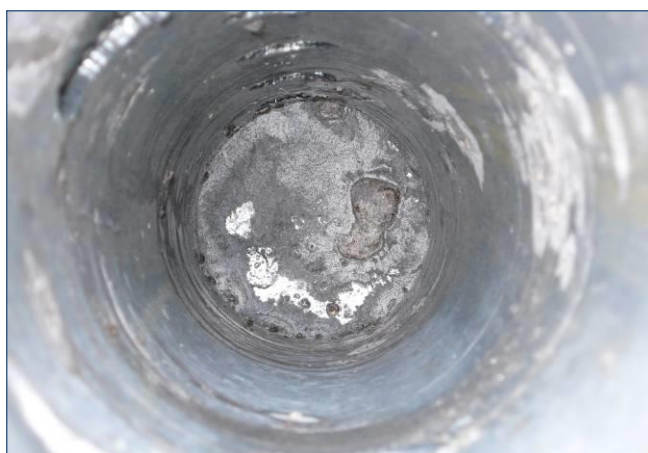
Fotografía 19: Estado interior zona seccionada. Detalle alta acumulación de Zn.
