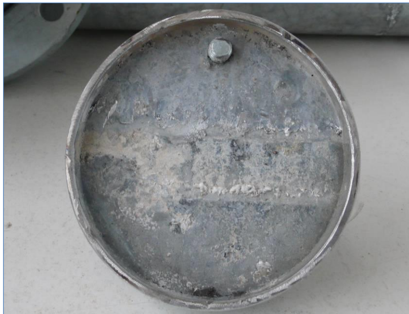
Fotografía 25: Hidrante 5. Estado interior zona seccionada, extremo toma 72-73.
