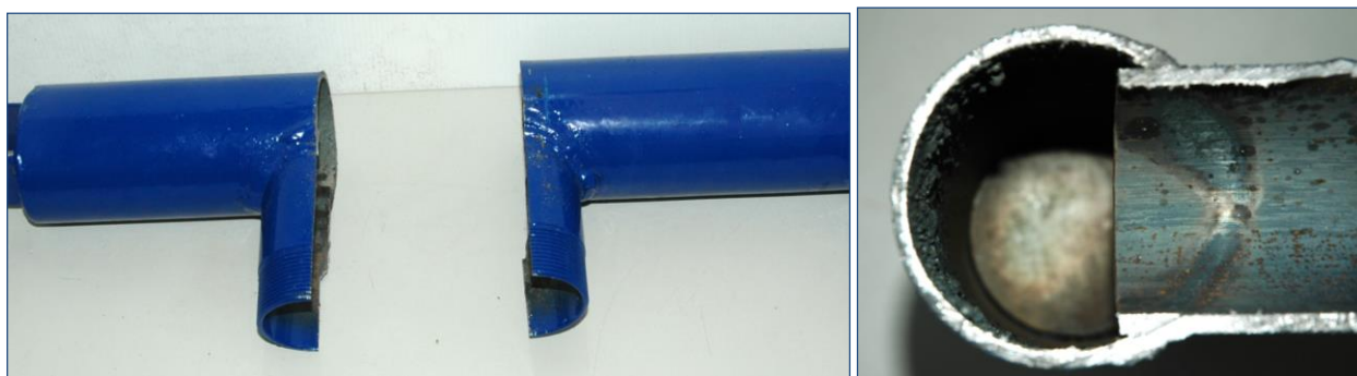
Fotografía 2-31: Hidrante 1. Corte realizado. Estado interior de la zona seccionada. Detalle con puntos de corrosión y alta rugosidad interior. Soldadura de las tomas con resalte.
