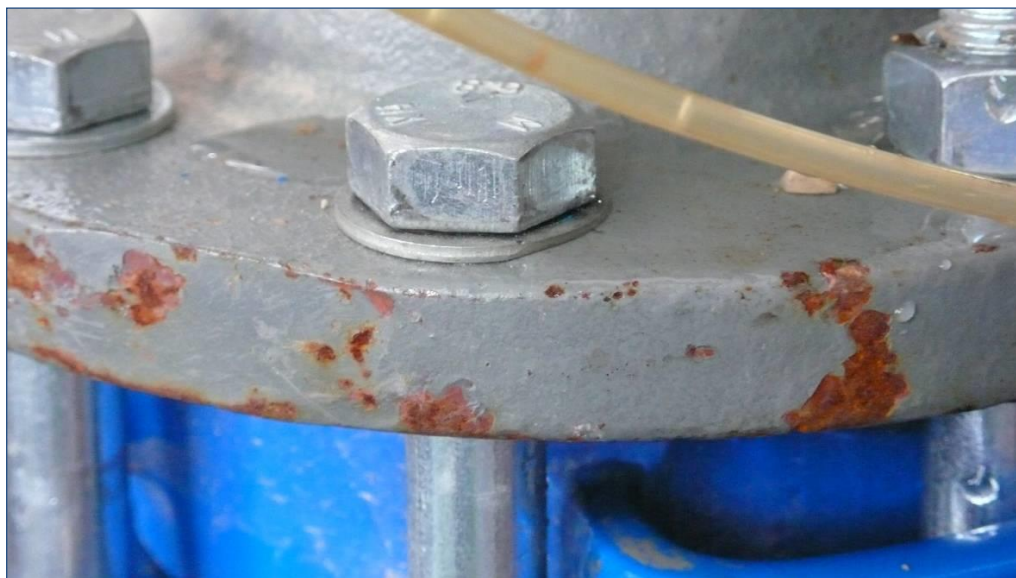
Fotografía 12: Hidrante 2. Daños y corrosión exterior del filtro caza piedras.
