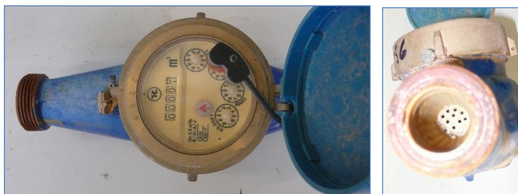
Fotografía 2-55: Estado exterior contador 25C. Presenta restos de obturación en el filtro.
