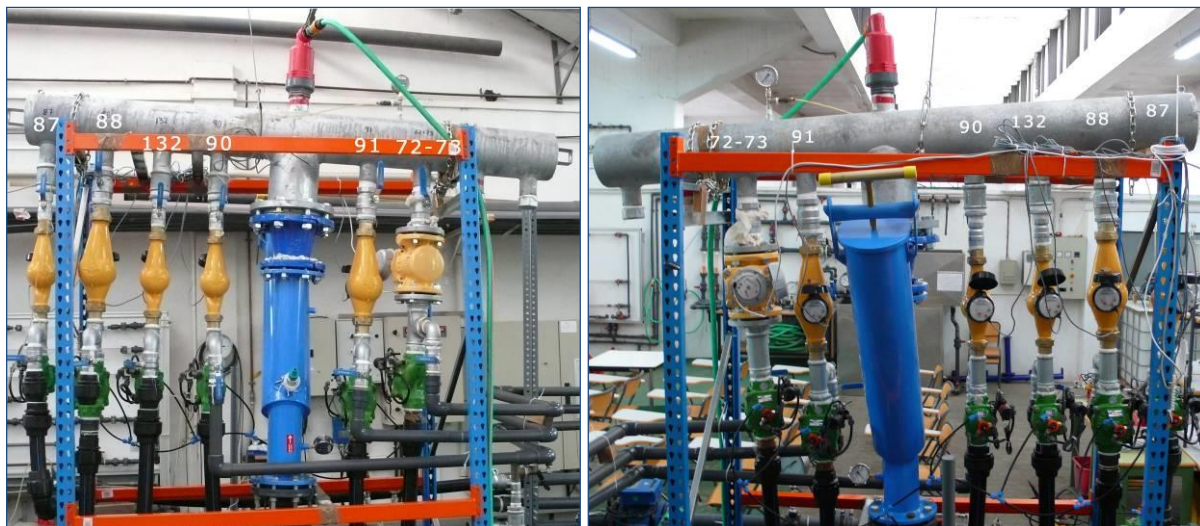
Fotografía 21: Hidrante 5. Detalle e identificación de tomas.
