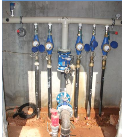
Fotografía 2-17: Hidrante vertical V2-2. C.R. Cota 220 2010. Tipo 3. (Fotos Miranda M.). Buen acceso a las tomas y válvula de retención en cada toma para evitar el vaciado del contador después de la parada del riego. Filtro bien colocado.
