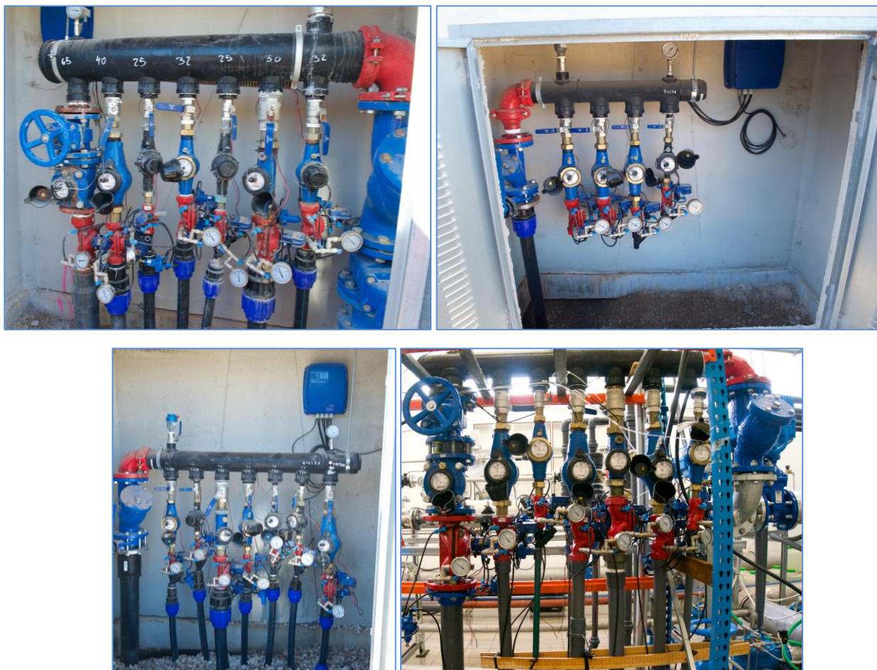
Fotografía 2-2: Hidrante Vertical V1. C.R. Valle de Carcer y Sellent. Tipo 3. (Fotos Balbastre I.). Tomas poco separadas lo que dificulta el mantenimiento, obligando a que las válvulas hidráulicas estén ladeadas, filtro caza piedras en posición incorrecta.
