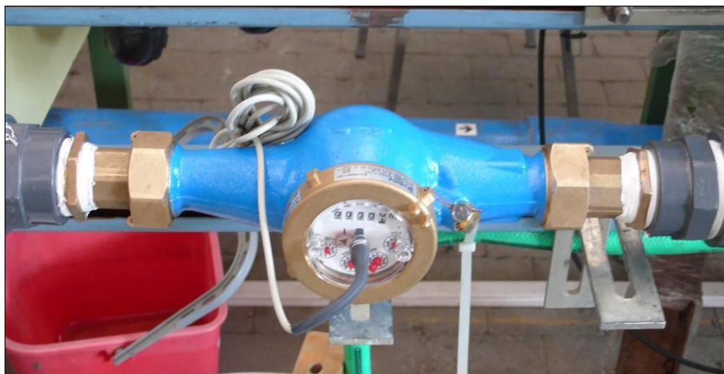
Fotografía 53: Contador Wehrle Modelo MTKHWK en posición horizontal, girado 90°.
