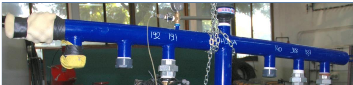
Fotografía 2: Hidrante 1. Colector completo
