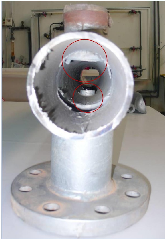
Fotografía 28: Hidrante 6. Estado interior sección 2. Inserción de los tubos que configuran las salidas y la conexión de la ventosa.
