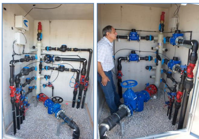
Fotografía 2-28: Hidrante horizontal H2-5. C.R. L'Alcudia. Tipo 3. (Fotos Balbastre I.). Buen acceso para mantenimiento. Elemento de filtrado en posición correcta. Tramos rectos aguas arriba y abajo de los contadores.
