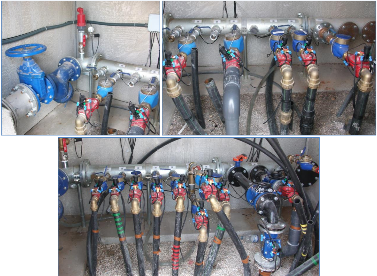
Fotografía 2-22: Hidrante horizontal H1-7. C.R. CGU Alto Vinalopó 2010. Tipo 1. (Fotos Miranda M.). Filtro bien colocado. Buen acceso a las tomas.
