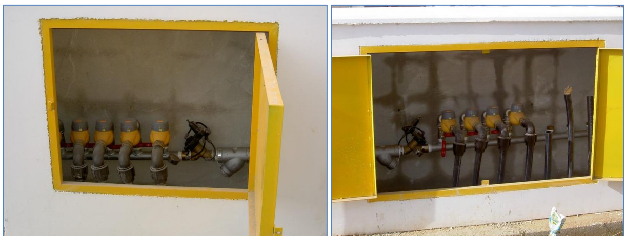
Fotografía 2-23: Hidrante horizontal H1-7. Tipo 3. Fotos (Munasa 2015). Difícil acceso para mantenimiento.
