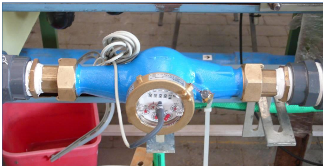
Fotografía 51: Contador Wehrle Modelo MTKHWK en posición horizontal, girado 90°.
