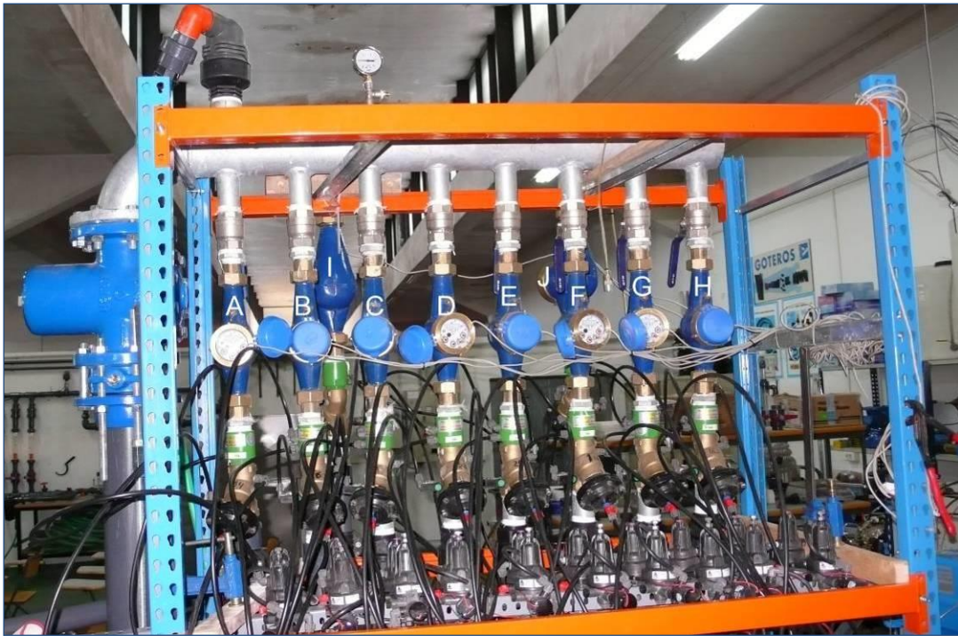
Fotografía 30: Hidrante 7. Detalle frontal del hidrante.
