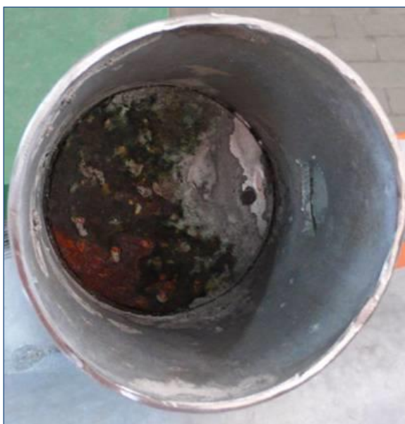
Fotografía 18: Hidrante 3. Estado interior zona seccionada. Detalle puntos de corrosión.
