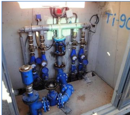
Fotografía 2-18: Hidrante vertical V2-2. C.R. del Bajo Priorato (Tarragona). Tipo 3. Fotos (Moval Agroingeniería 2015). Buen acceso a las tomas. Válvula de retención en cada toma pero colocada aguas arriba del contador lo que no evita el vaciado de los contadores después del riego. Sin elemento de filtración.
