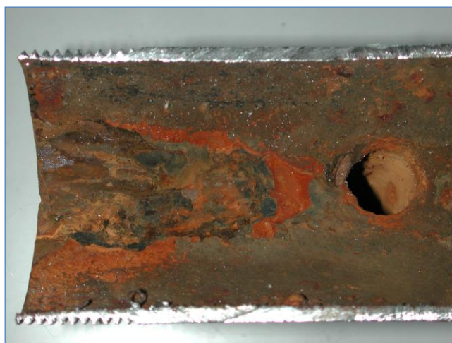
Fotografía 48: Estado interior zona seccionada. Detalle.
