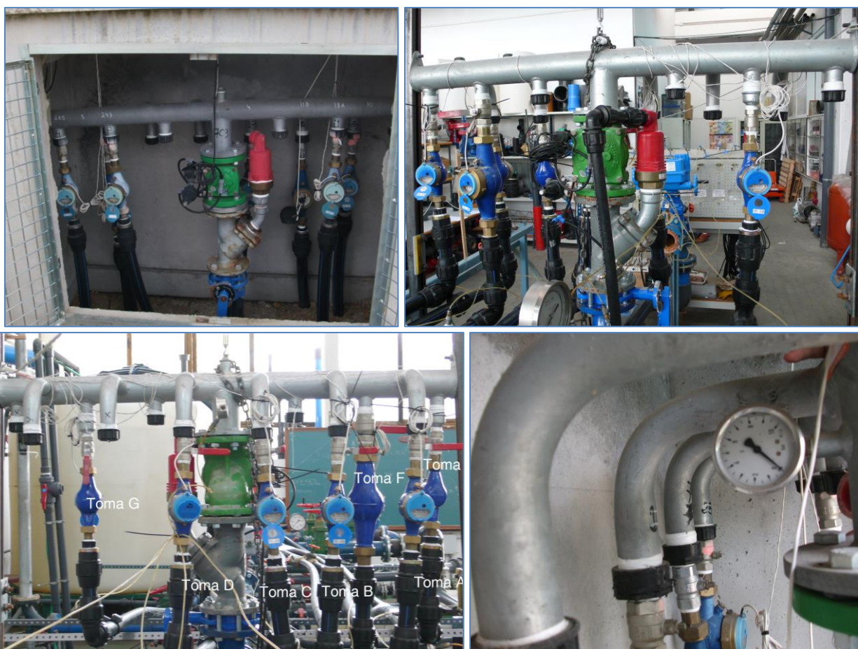
Fotografía 2-16: Hidrante vertical V2-1-3. C.R. Rio de Alcoy 2010. Tipo 3. (Fotos Miranda M., Balbastre I.). Filtro caza piedras mal colocado, ventosa sin válvula de aislamiento y mal colocada. Excesivas tomas por hidrantes y muy juntas, lo que impide el acceso a las tomas en segundo plano y dificulta el mantenimiento.
