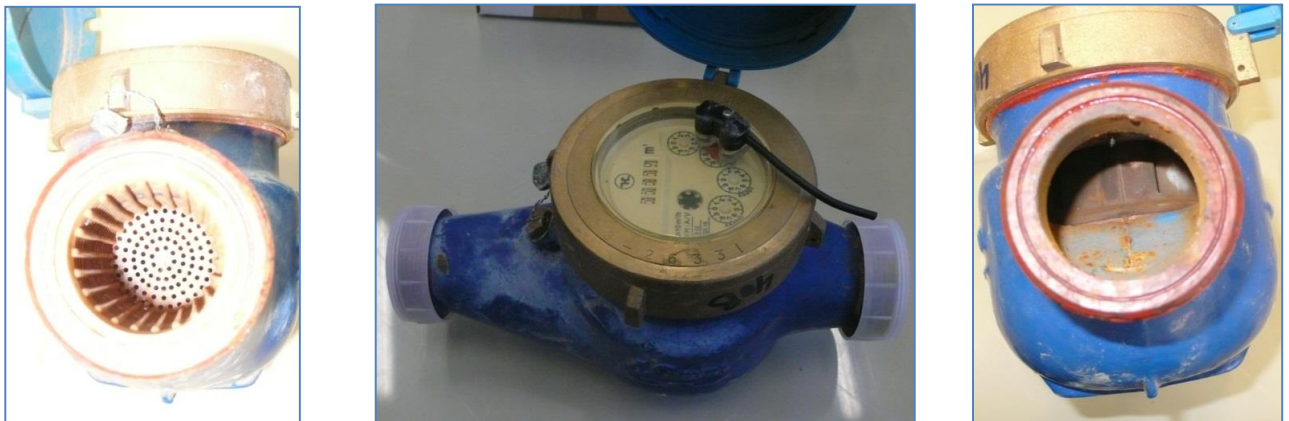
Fotografía 56: Estado exterior contador 40B
