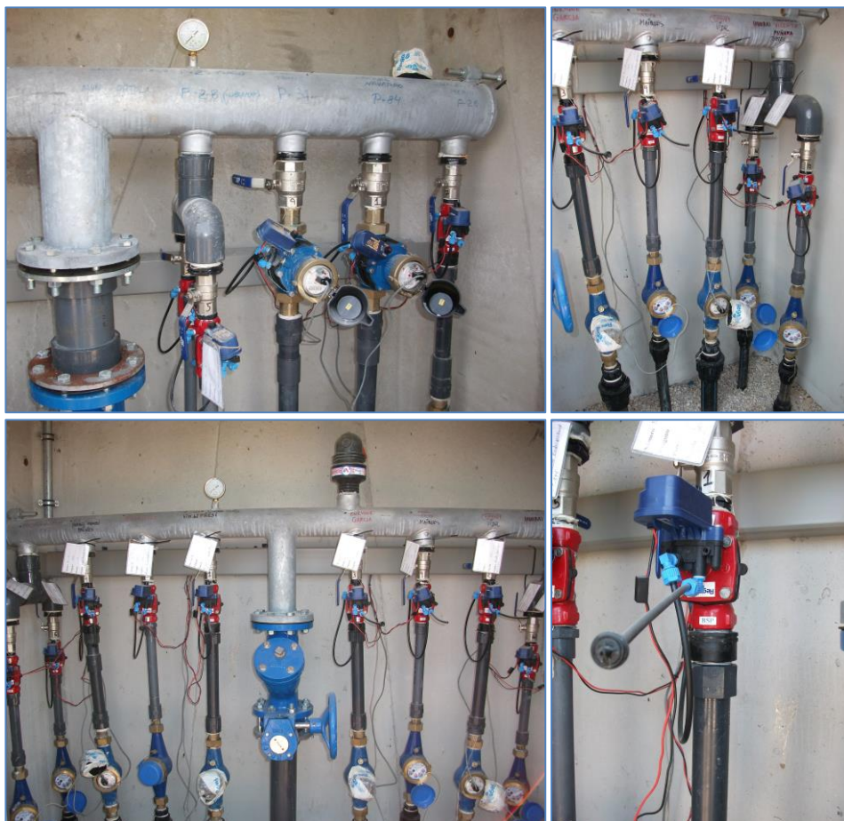
Fotografía 2-12: Hidrante vertical V2-1-2. C.R. Rafelguaraf 2010. Tipo 1. (Fotos Miranda M.). Contadores aguas abajo lo que permite que se vacían después del riego. Filtro caza piedras mal colocado, ventosa sin válvula de aislamiento. En el drenaje de las válvulas hidráulicas se coloca un emisor de riego localizado, para que la apertura sea progresiva e intentar eliminar el bloqueo de contadores por caudales elevados en el inicio del riego.
