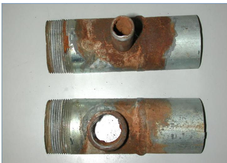
Fotografía 2-44: Estado soldadura exterior
