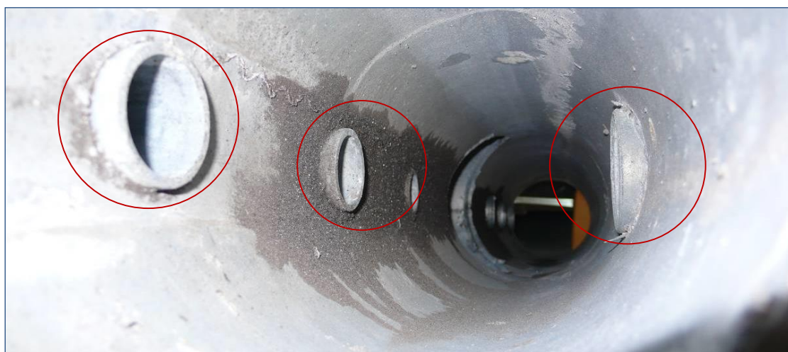
Fotografía 2-39: Hidrante 8. Estado interior donde se observa la inserción con resalte de los tubos que configuran las salidas y la conexión de la ventosa.
