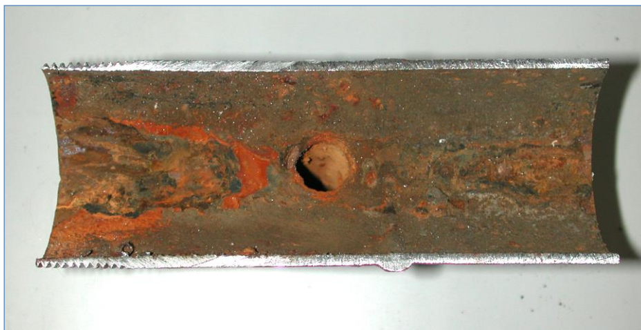
Fotografía 47: Estado interior zona seccionada
