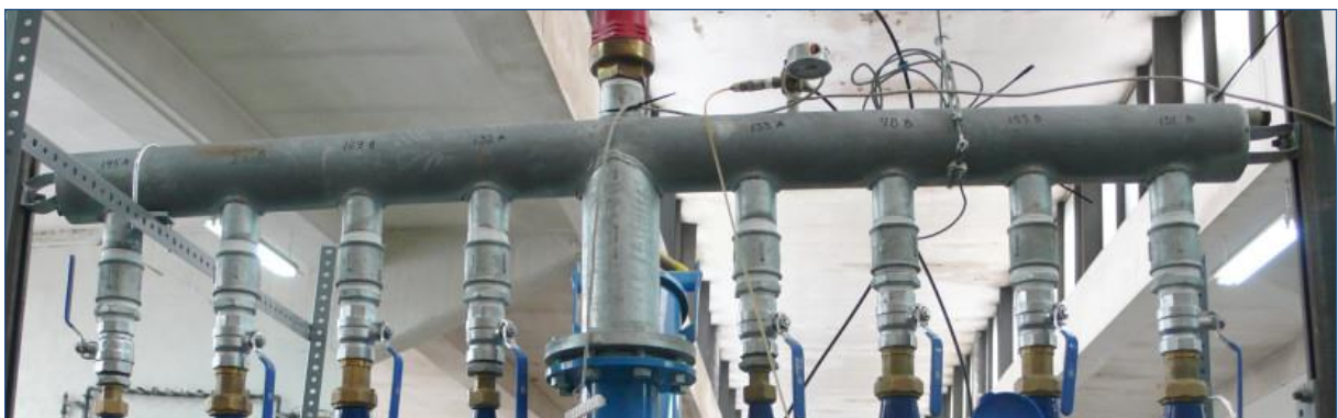
Fotografía 17: Hidrante 3. Colector completo
