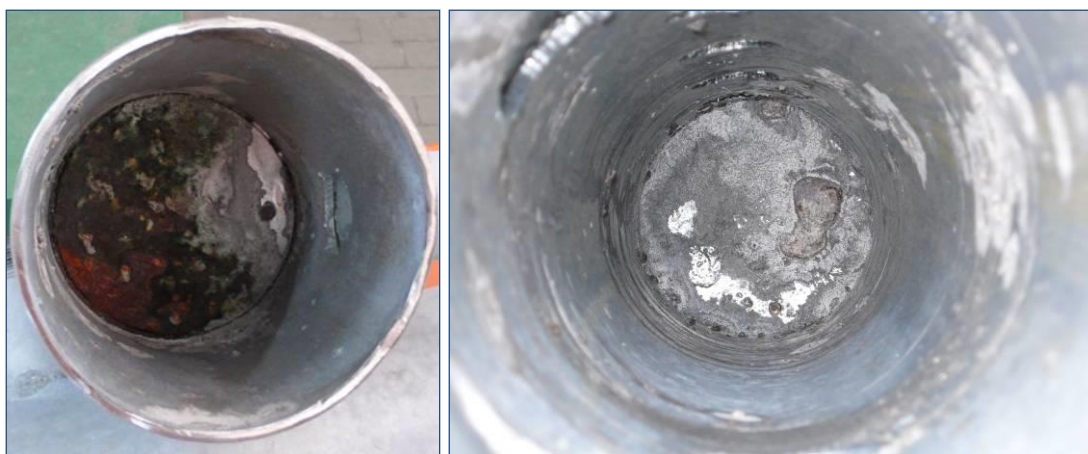
Fotografía 2-34: Hidrante 3. Estado interior zona seccionada. Detalle puntos de corrosión y alta acumulación de Zn.
