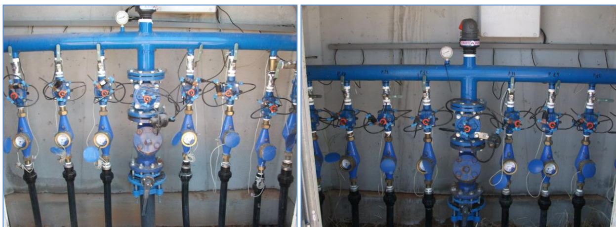
Fotografía 2-7: Hidrante vertical V2. C.R. Carlet 2010. Tipo 3. (Fotos Miranda M.) Contadores se vacían después del riego. Filtro caza piedras mal colocado, ventosa sin válvula de aislamiento, colector pintado (recubrimiento no adecuado).
