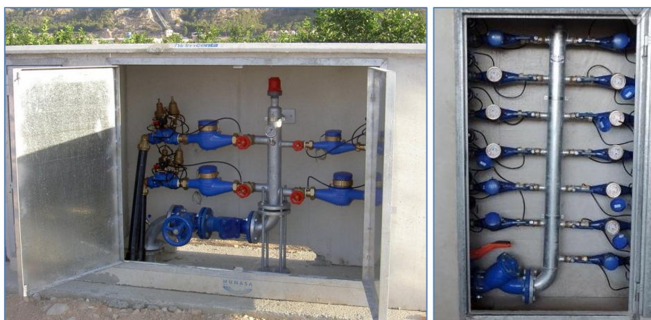
Fotografía 2-25: Hidrante horizontal H2-2. Tipo 4. Fotos (Munasa 2015). Derecha contadores en mala posición (horizontales pero girados 90°).
