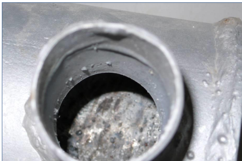
Fotografía 11: Hidrante 2. Estado interior zona seccionada. Detalle alta rugosidad interior.
