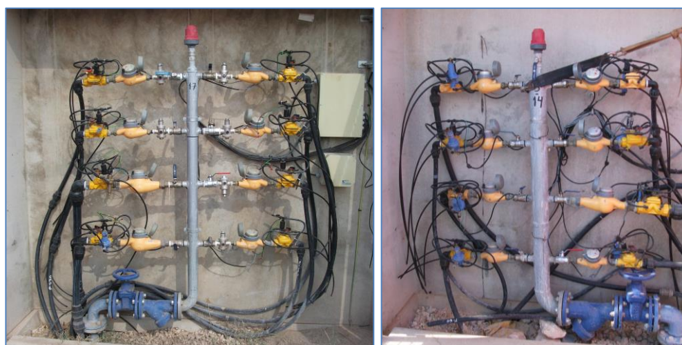
Fotografía 2-26: Hidrante horizontal H2-2. C.R. CGU Alto Vinalopó 2010. Tipo 3. (Fotos Miranda M.). Filtro bien colocado. Buen acceso a las tomas. Anclajes insuficientes.
