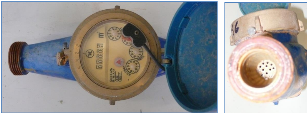
Fotografía 63: Estado exterior contador 25C. Presenta restos de obturación en el filtro.
