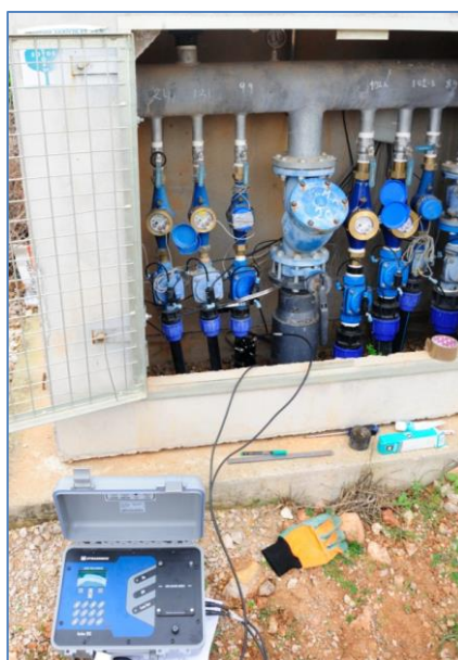
Fotografía 65: Detalle instalación en Toma 25.
