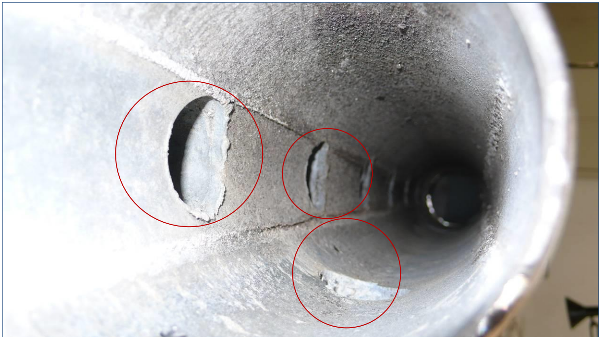
Fotografía 2-37: Hidrante 7. Estado interior, se observa que la inserción de los tubos que configuran las salidas es limpia, sin inserciones del tubo de la toma en el colector.
