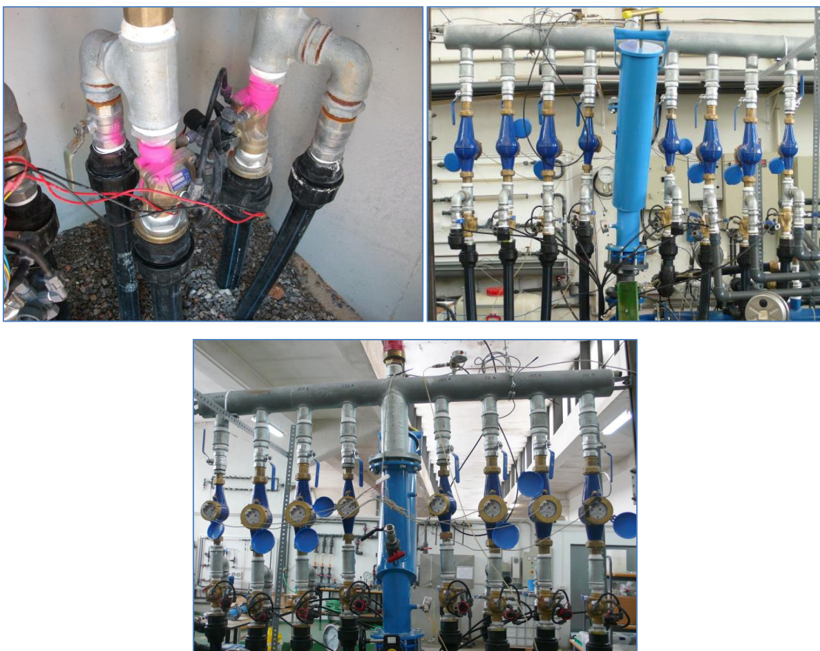
Fotografía 2-14: Hidrante vertical V2-1-2. C.R. Picassent Sector XI 2008 y 2010. Tipo 1. (Fotos Miranda M., Balbastre I.). Filtro de malla mal colocado, ventosa sin válvula de aislamiento. Tomas en derivación para cada salida. Estas tomas permiten tener acceso al agua sin estar programado el riego.
