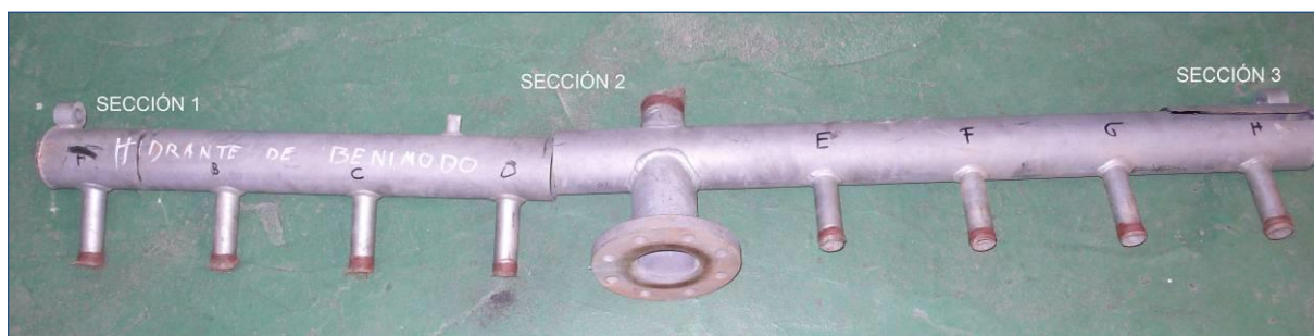
Fotografía 27: Hidrante 6. Colector completo
