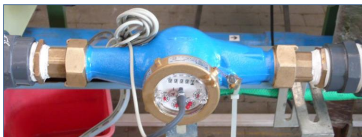
Fotografía 2-52: Contador Wehrle Modelo MTKHWK en posición horizontal, girado 90°.
