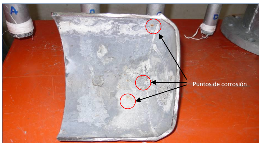
Fotografía 2-40: Hidrante 8. Detalles del estado interior puntos de corrosión.
