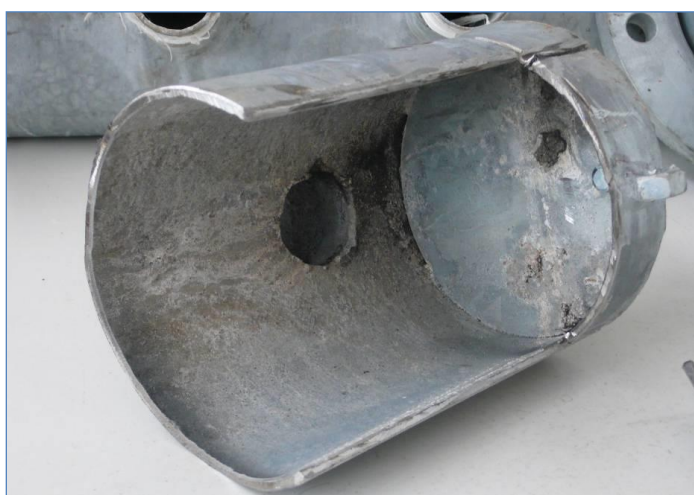
Fotografía 2-35: Hidrante 5. Estado interior zona seccionada, extremo toma 87 (extremo de colgado para el galvanizado).
