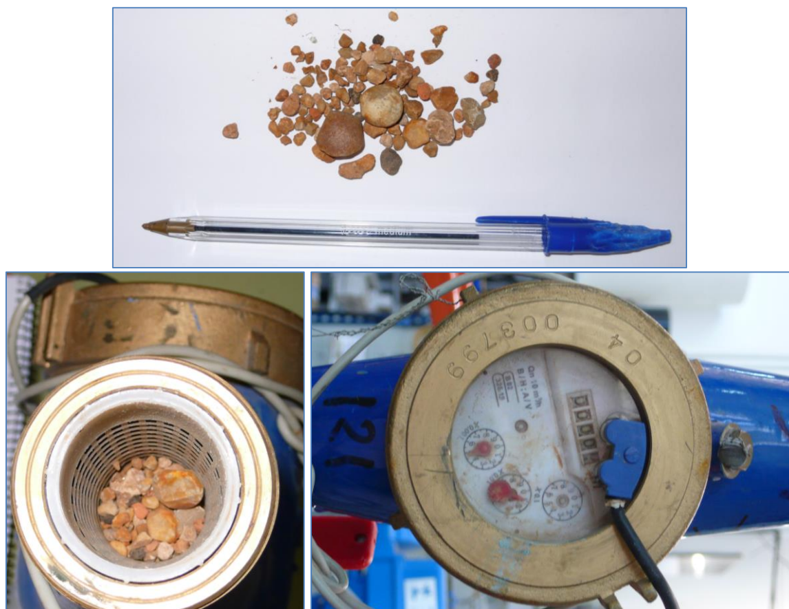
Fotografía 2-54: Condiciones de instalación deficientes. Piedras retenidas por el prefiltro y mecanismo lleno de barro en un contador de Chorro Múltiple.
