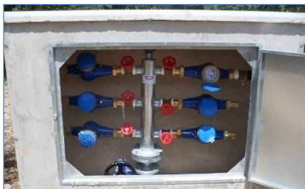
Fotografía 2-24: Hidrante horizontal H2. Tipo 1. Fotos (Munasa 2015). Sin elemento de filtrado, contadores en mala posición (horizontales pero girados 90°) y acceso limitado.
