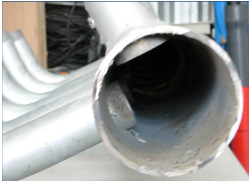
Fotografía 9: Hidrante 2. Detalle soldadura tomas al colector
