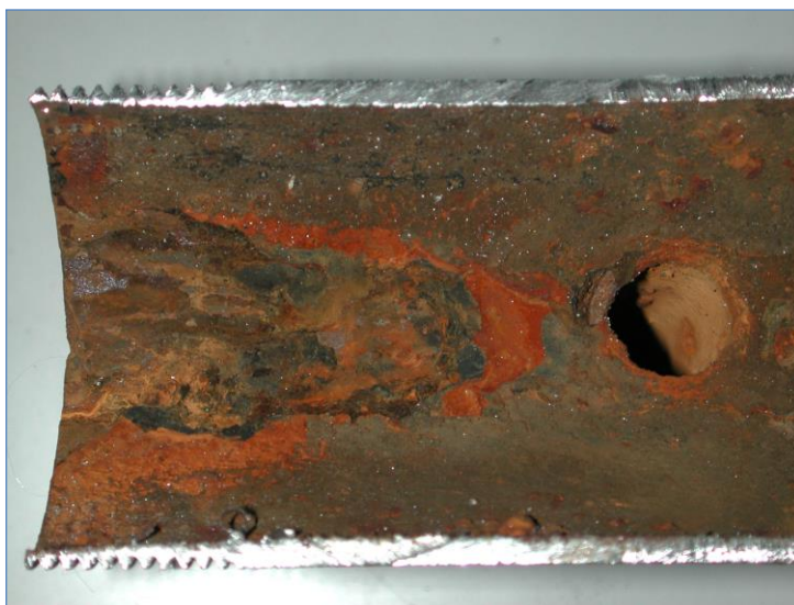
Fotografía 2-45: Estado interior zona seccionada. Detalle.
