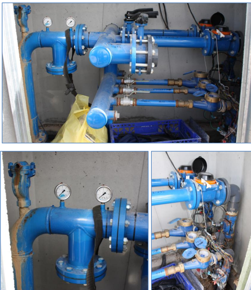
Fotografía 2-27: Hidrante horizontal H2-4. C.R. Senyera Tipo 1. (Fotos Palau C.V.) Difícil acceso a las tomas, difícil mantenimiento. Sin válvula de aislamiento en la ventosa. Sin ningún elemento de filtrado. Tramos rectos aguas arriba de los contadores.
