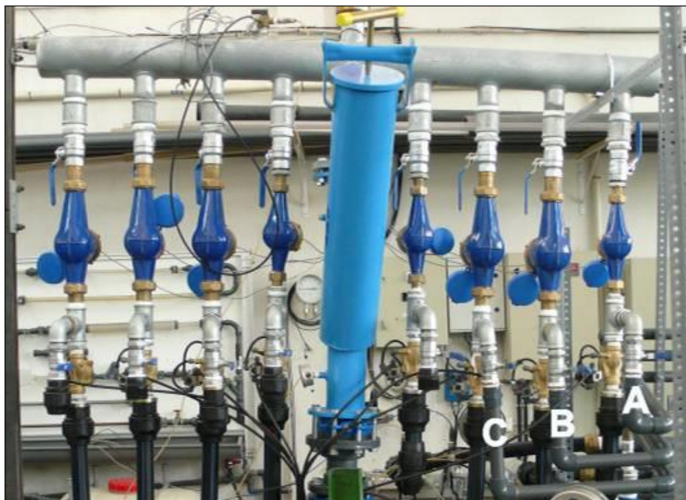
Fotografía 16: Hidrante 3. Detalle de las salidas en derivación instaladas.
