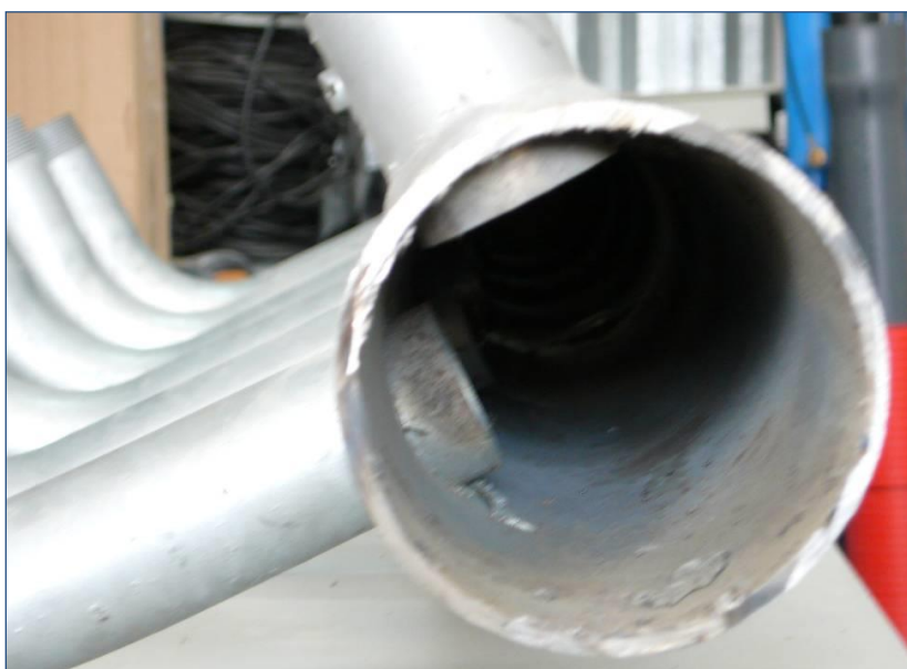
Fotografía 2-32: Hidrante 2. Detalle soldadura tomas al colector con resalte. Detalle alta rugosidad interior.
