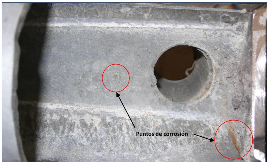
Fotografía 2-38: Hidrante 7. Puntos de corrosión.
