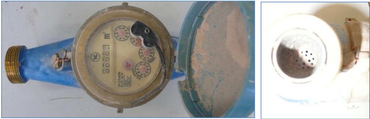
Fotografía 64: Estado exterior contador 25D. Presenta restos de obturación en el filtro.
