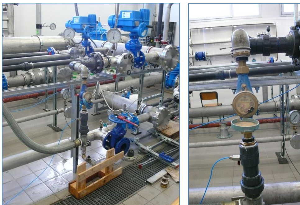
Fotografía 1: Detalles de la instalación del contador.
