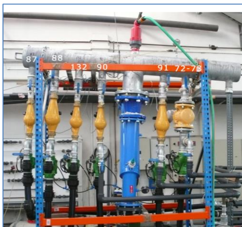
Fotografía 2-13: Hidrante vertical V2-1-2. C.R. Picassent Sector IV 2008 y 2010. Tipo 1. (Fotos Miranda M., Balbastre I.). Filtro de malla mal colocado, ventosa sin válvula de aislamiento. Tomas en derivación para cada salida. Estas tomas permiten tener acceso al agua sin estar programado el riego
