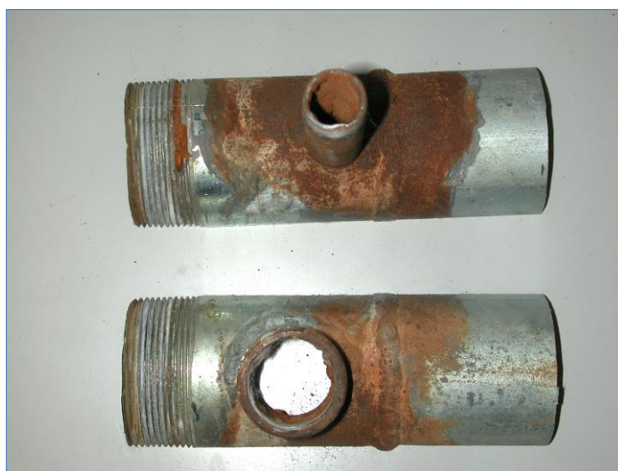
Fotografía 46: Estado soldadura exterior.
