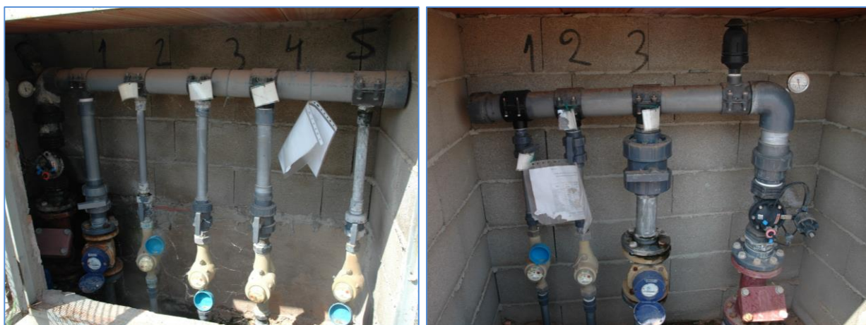
Fotografía 2-1: Hidrante Vertical V1. C.R. Bétera. 2000. Tipo 1. (Fotos Balbastre I.). Contadores aguas abajo de la toma, vacíos entre riegos, filtro caza piedras en posición incorrecta y ventosa sin válvula de aislamiento.
