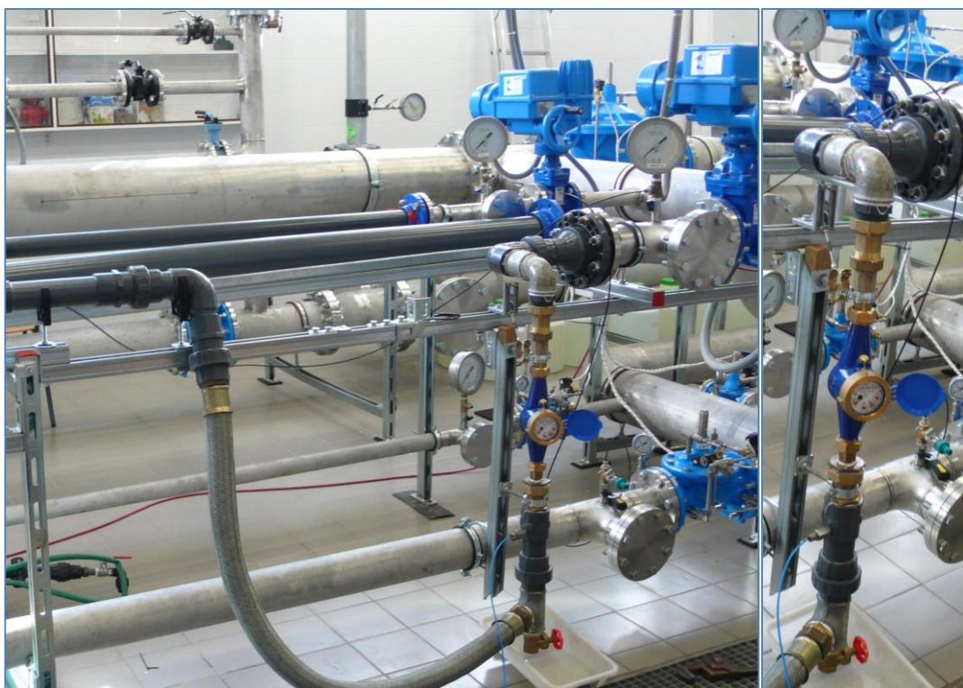
Fotografía 69: Detalles de la instalación del contador.
