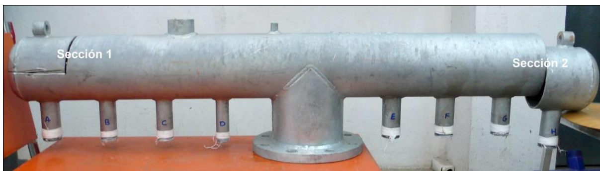
Fotografía 38: Hidrante 8. Colector completo
