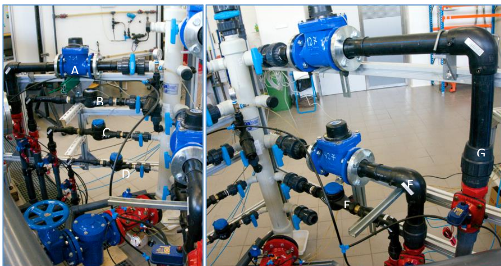
Fotografía 2: Detalle del hidrante.
