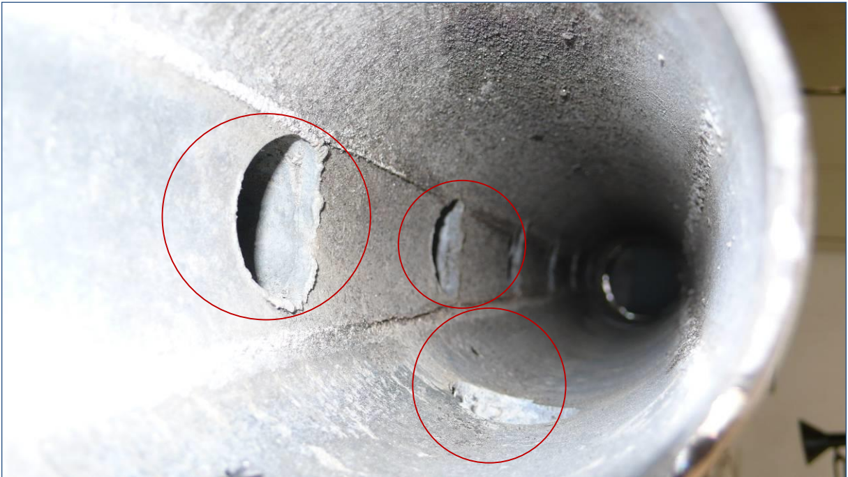
Fotografía 33: Hidrante 7. Estado interior sección 1, se observa que la inserción de los tubos que configuran las salidas es limpia, sin inserciones del tubo de la toma en el colector.
