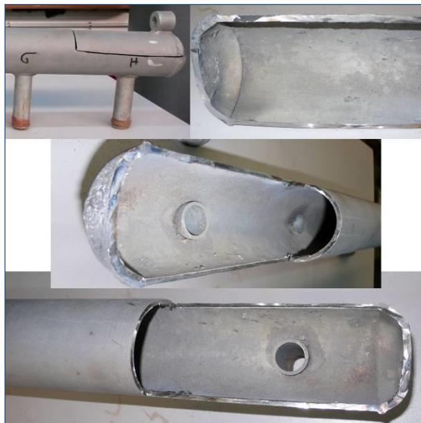
Fotografía 29: Hidrante 6. Detalles del estado interior de la sección 3. Extremo tomas G y H.
