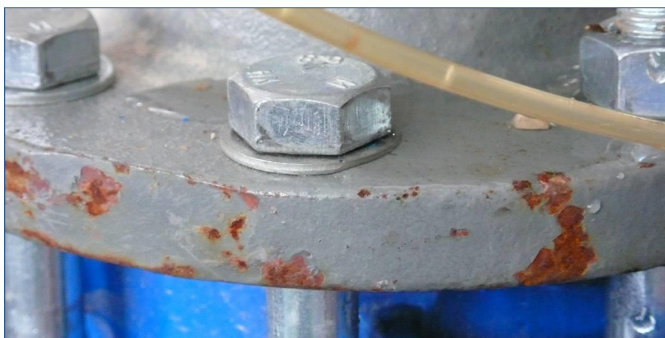
Fotografía 2-41: Hidrante 2. Daños y corrosión exterior del filtro caza piedras.
