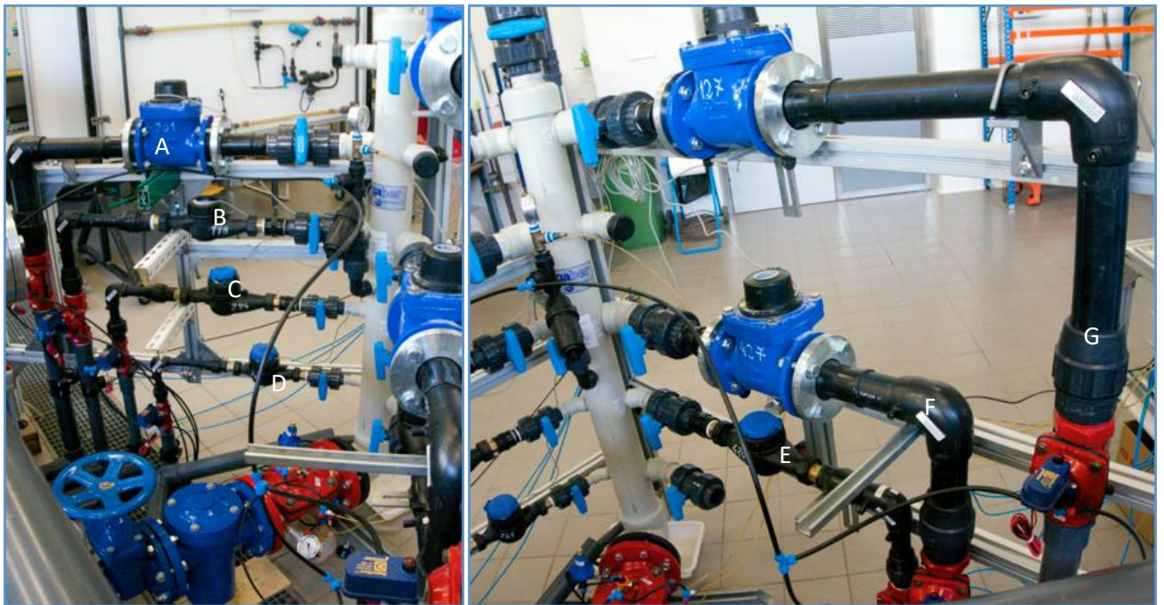
Fotografía 3-3: Detalle del Hidrante 10, Tipo “Costella”. Izquierda tomas A-B-C-D , derecha tomas E-F-G.
