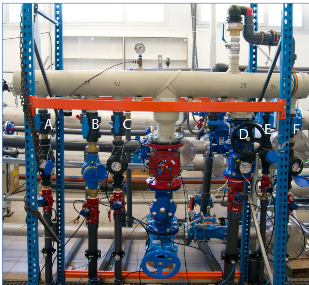
Fotografía 42: Detalle del hidrante 9.
