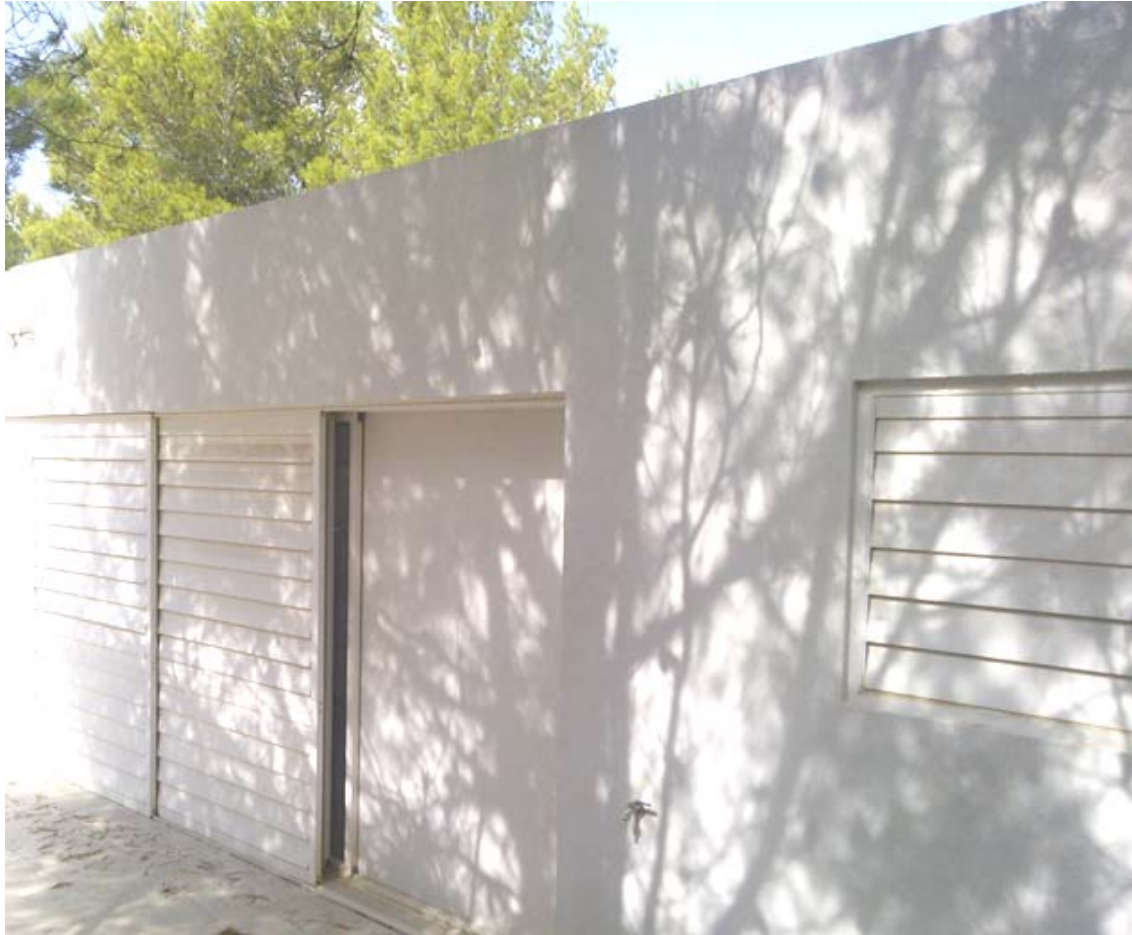
634. 635. 636. Viviendas en la Bahía de Alcudia (Mallorca, 1983-1984). Prototipo construido con bloque. Estado actual.
