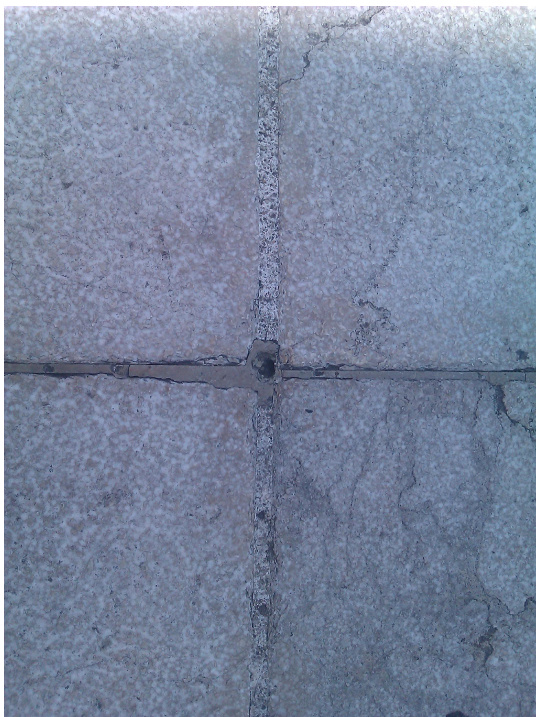
Figura 2.57: Taladro practicado sobre el pavimento de la parte superior de la torre del Miguelete para señalar el vértice denominado Miguelete II
