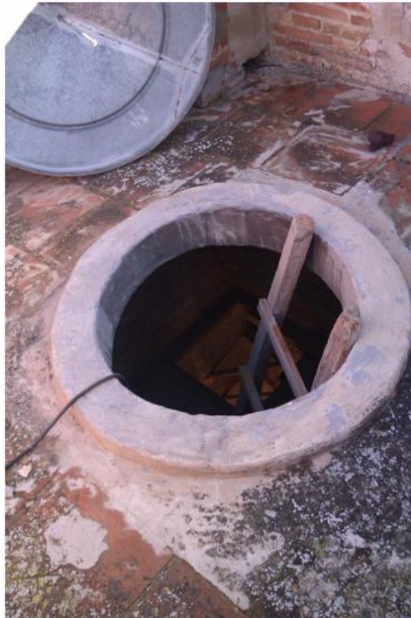
Figura 2.51: Pavimento de la parte superior de la torre de la Parroquia Nuestra Señora de Lepanto de Castellar
