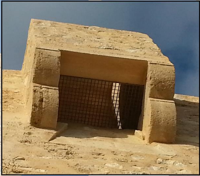
Vista cenital del matacán. Se observa la ausencia de suelo, ahora cubierto con una reja
