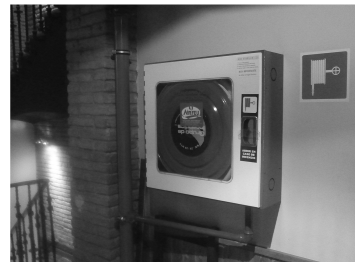
Instalación contra incendios.
