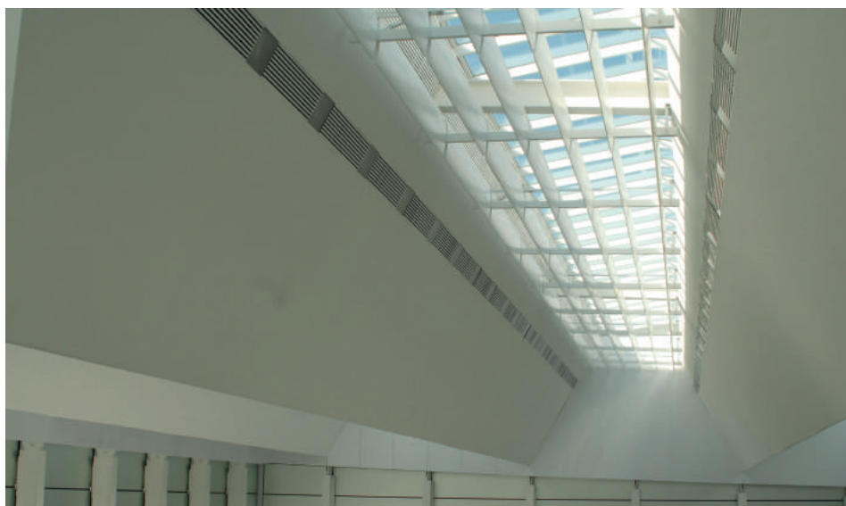
Fig. 141, Estructura triangular de sujeción de cubierta y paso de instalaciones con lucernario central.
