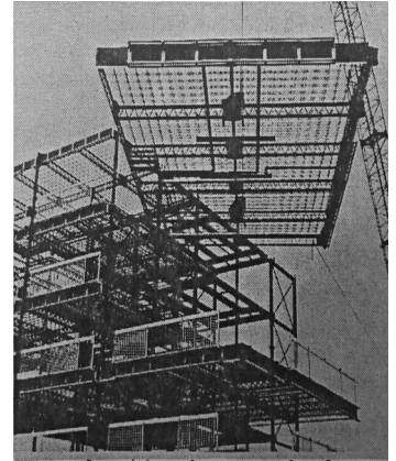
Instalación de uno de los forjados prefabricados de acero de las viviendas en Rouen.
