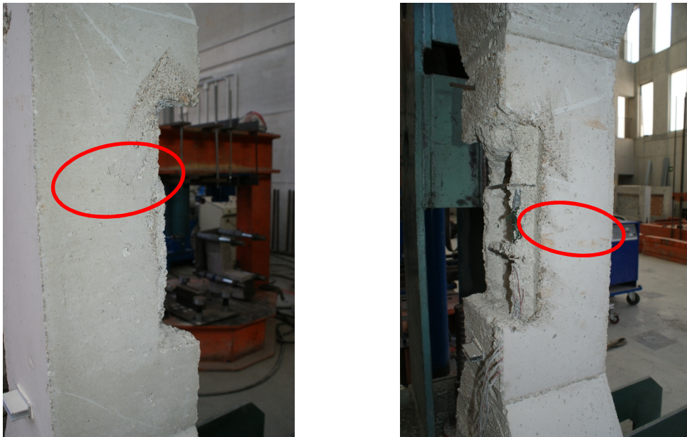
Figura 138 - Pilares PPDP tras el ensayo a compresión. Fisuración caras laterales C2 y C4 respectivamente.
