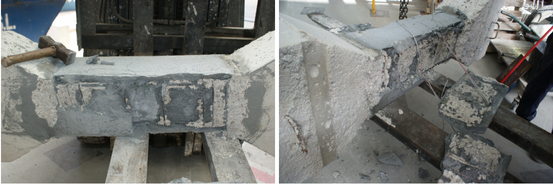
Figura 69 - Pilar PR4C_R3+PU tras el ensayo. Detalle del desprendimiento de la capa de reparación tras el ensayo.
