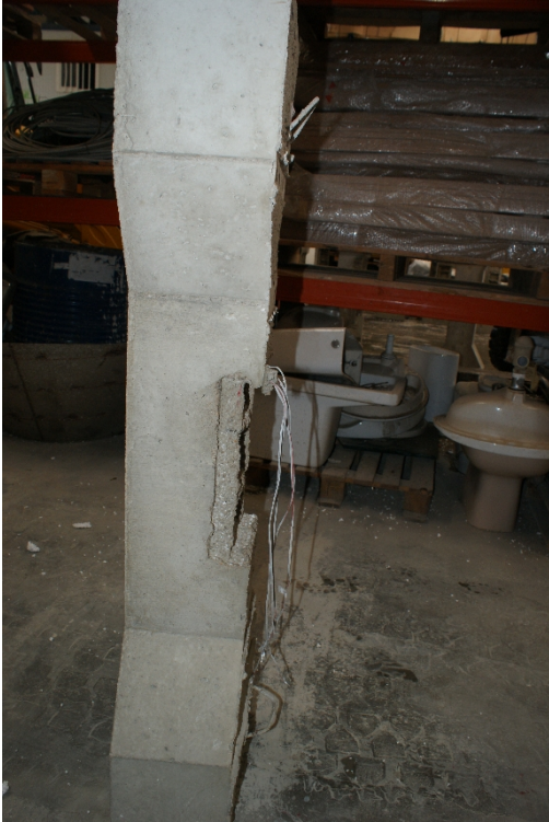
Figura 40 - Detalle pilar daño parcheo.
