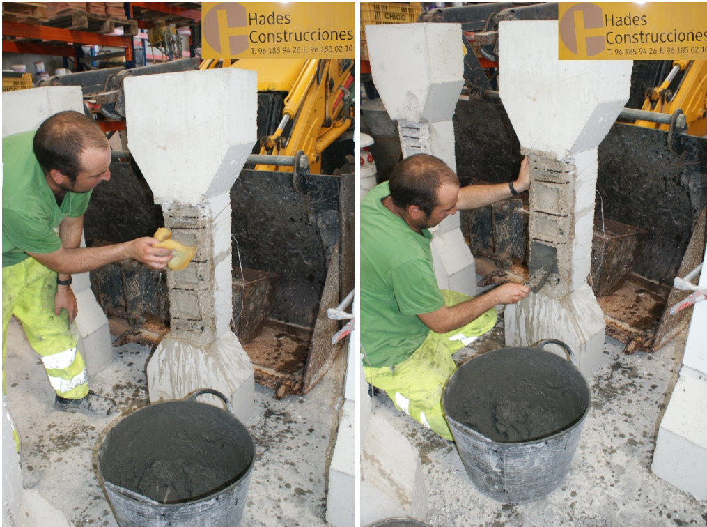
Figuras 41 y 42 - Humedecimiento de las superficies y relleno con una primera capa.
