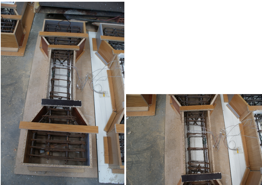
Figura 30 - Pilar daño en 1 cara, encofrado.
