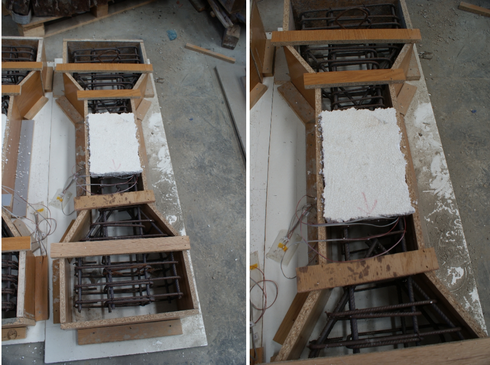
Figura 31 - Pilar daño parcheo, encofrado.
