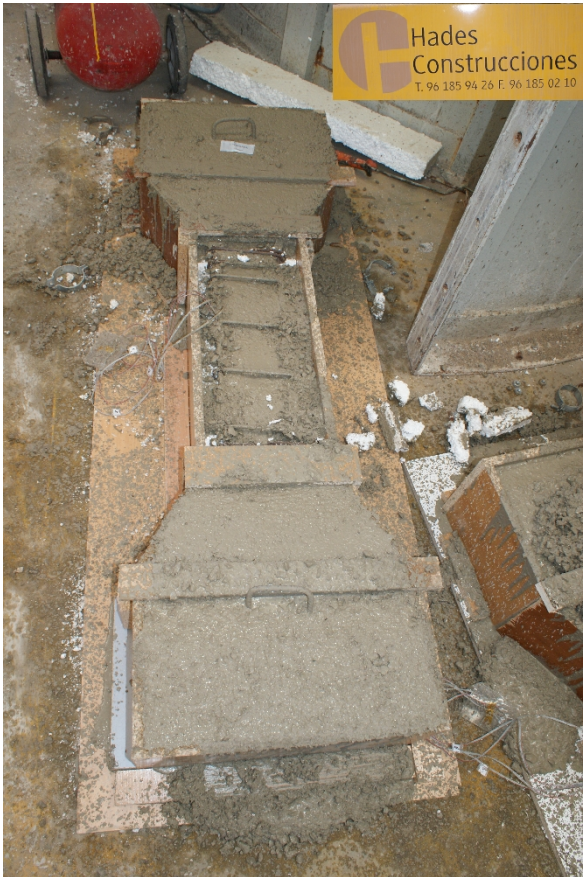
Figura 34 - Detalle del pilar dañado 4 caras hormigonado.
