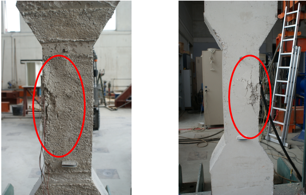
Figura 58 - Pilares PP tras el ensayo a compresión. Fisuración cara delantera (Cara C1) y trasera (Cara C3), respectivamente.
