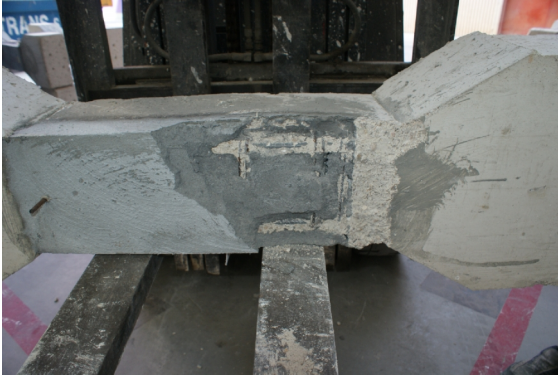
Figura 98 - Pilares PR1C_R3+PU tras el ensayo a compresión. Detalle del desprendimiento de la capa de reparación tras el ensayo.
