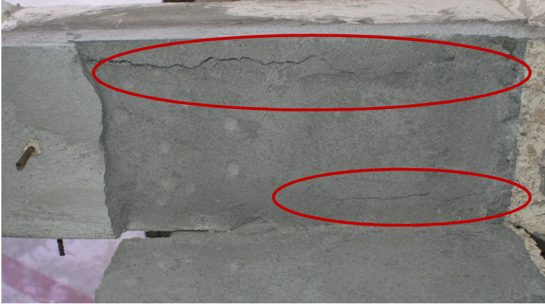
Figura 196. Detalle de la fisuración interna en la capa de reparación.
