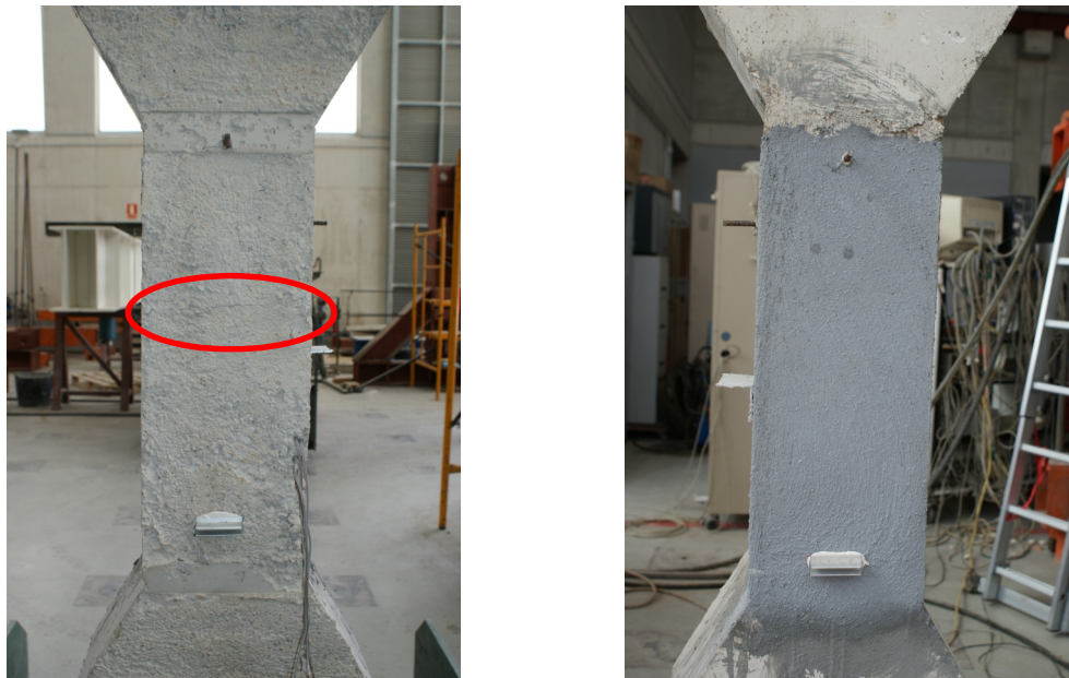
Figura 117 - Pilares PR1C_R4+PU tras el ensayo a compresión. Fisuración caras C1 y C3 respectivamente.
