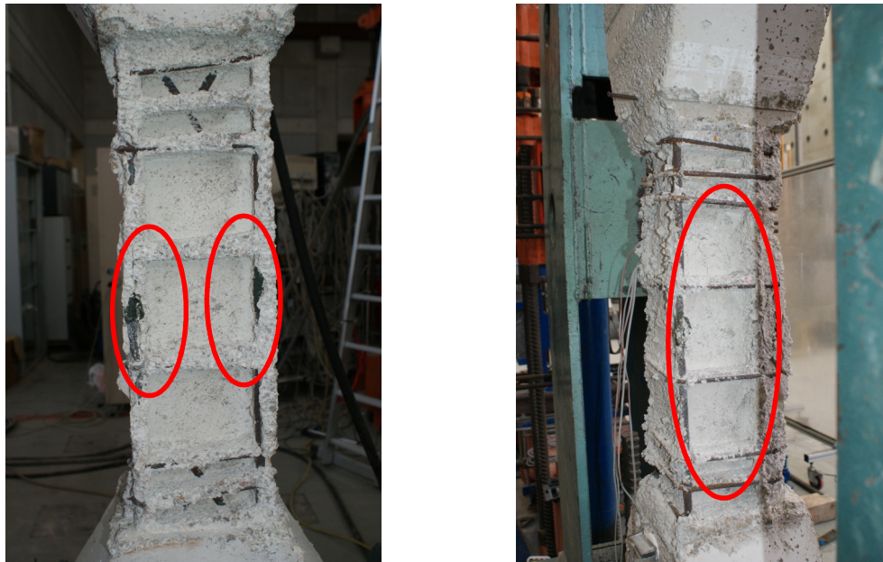
Figura 64 - Pilar PPD4C tras la rotura. Caras C3 y C4 respectivamente.
