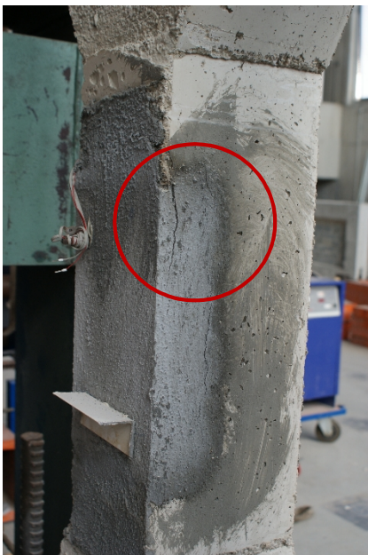
Figura 214. Detalle de la fisuración en el lateral del parcheo.
