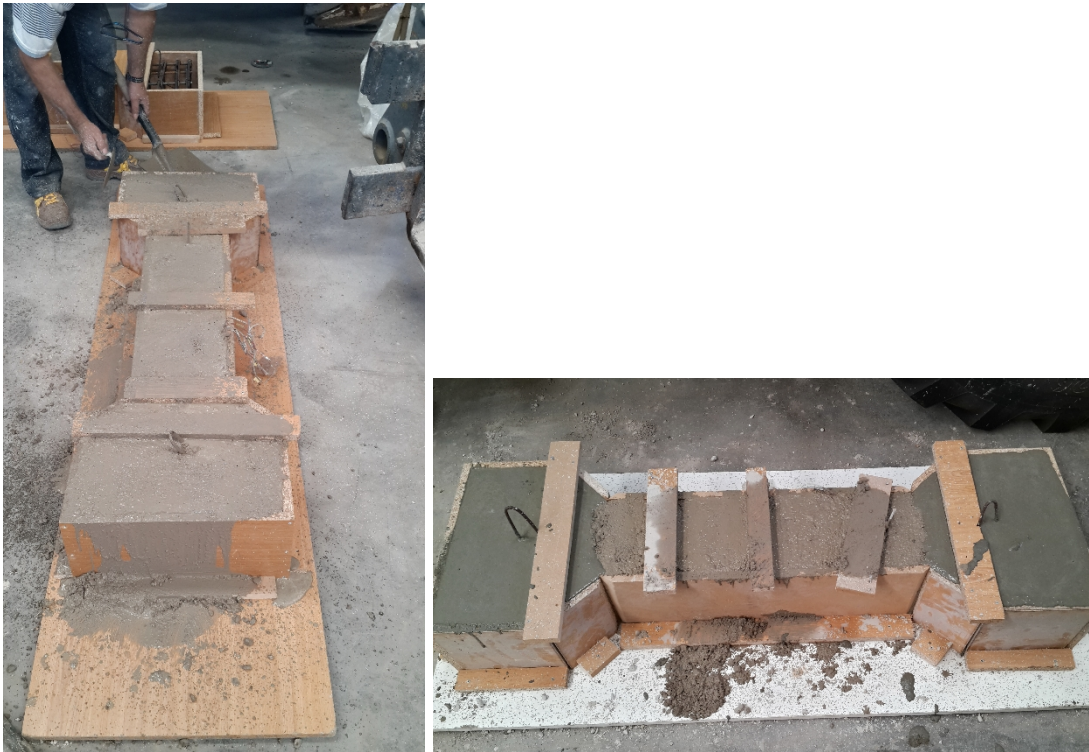
Figura 23 – Detalles del hormigonado para los dos diseños de la segunda tanda de pruebas.
