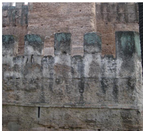
Foto_6 Verdugadas de ladrillo en la barbacana de Sevilla. Muralla Almohade, S. XII. 2008
