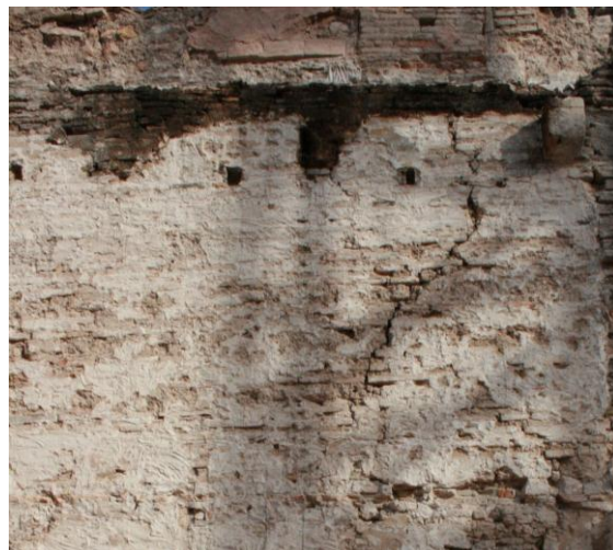
Foto_64 Canzorro y restos de otros dos, en el muro del siglo XV levantado sobre la muralla. Es de destacar la marca biológica de la pudrición de una viga maestra que supuso la ruina del alfarje y su sustitución, quizá ya en el siglo XIX. 2007
