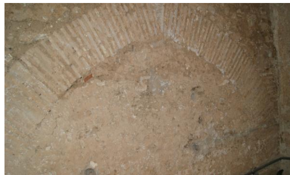
Foto_45 Arco de descarga en la fachada norte de la torre, foto tomada durante la intervención de rehabilitación del Palacio Marques de Caro. 2008
