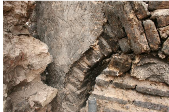
Foto_42 Detalle de la costra con incisiones que cubre los arcos de entrada a la torre desde el adarve, foto tomada durante la intervención de rehabilitación del Palacio Marques de Caro. 2007.
