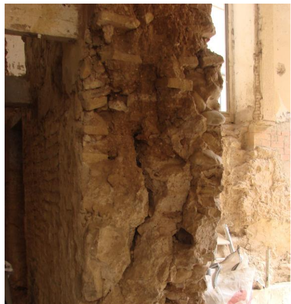
Foto_23 Tapia Valenciana del muro de separación entre el salón principal y el zaguán. En la imagen se observa una sección que permite ver la inserción de ladrillos en el muro. Siglo XII
