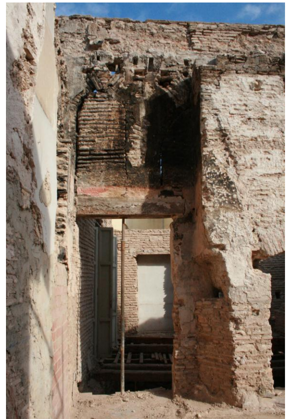
Foto_57 El nuevo muro del siglo XV cubre los arcos islámicos del adarve. Marqués de Caro. 2007.
