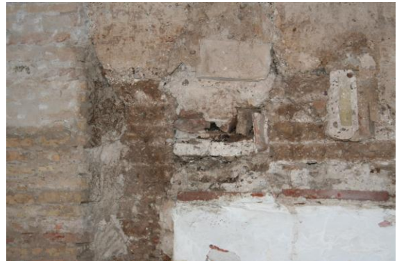
Foto_27 Tapia valenciana con gran contenido de cal dispuesto en tongadas cada 5 cm. Fachada oeste crujía transversal. 2007
