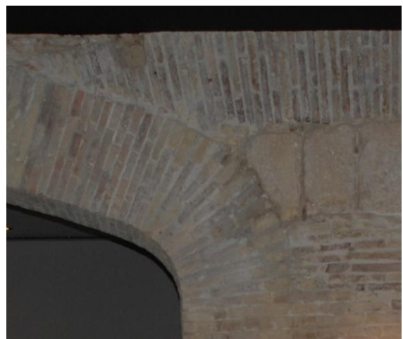
Foto_54 Detalle del encuentro del arco escarzano con el arco carpanel del siglo XIX que lo secciona. 2015
