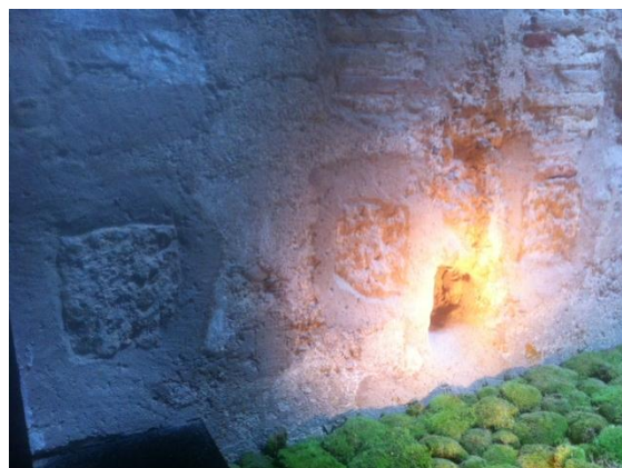
foto_65 Canzorros degollados en la primitiva fachada sur, ubicados en el patio cubierto de la segunda crujía del nuevo Palacio. 2015
