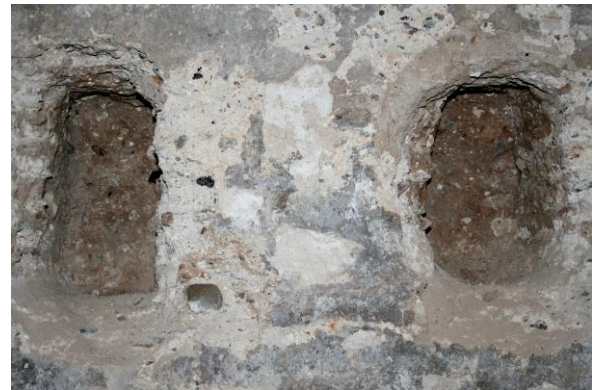
Foto 33_ Restos de mechinales abiertos en la tapia de tierra donde se aprecian las lengüetas características de costra que penetran en la masa de tierra.
