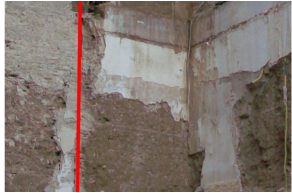
Foto_56 Adelgazamiento de la muralla a la altura del entresuelo. La línea roja marca el límite original de la muralla, que se rebaja hasta la esquina, más de un metro.
