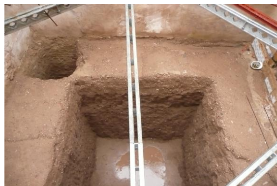
Foto_39 Cata en el relleno de la torre, 3ra fase de excavación del Palacio de Marques de Caro. 2008
