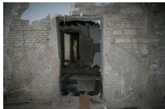
Foto_45 Arco ojival de entra al primitivo Palacio del Marqués de Caro, seccionado por el forjado de la Planta Entresuelo y por la apertura de una puerta de comunicación con la nueva crujía. Rehabilitación del Palacio del Marqués de Caro. 2007
