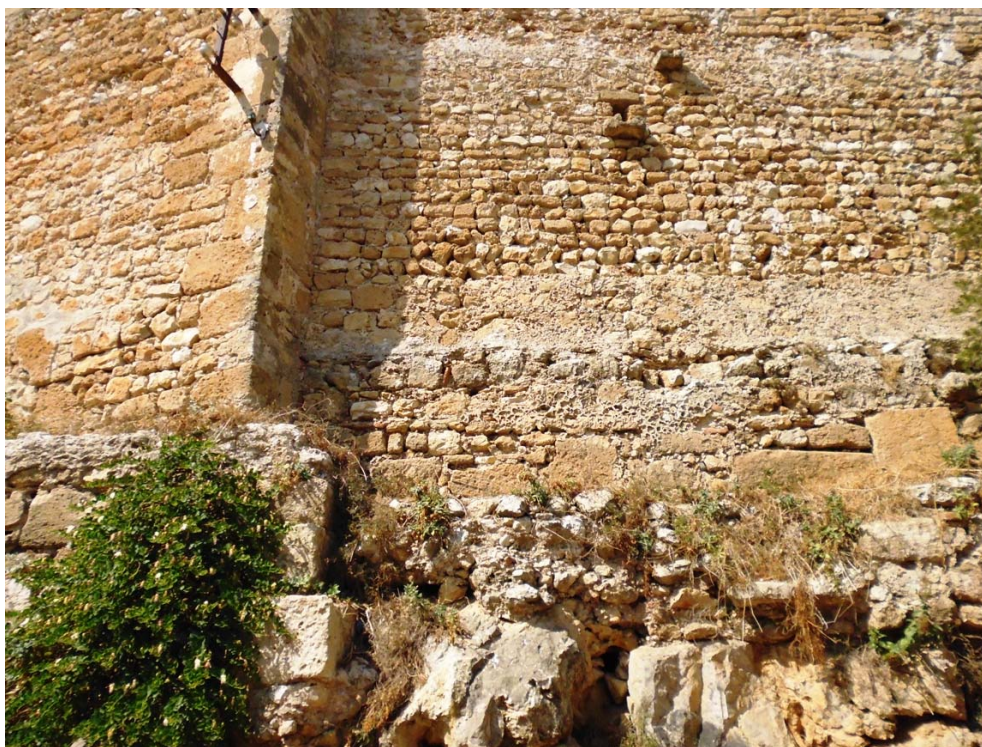
-Muro de tapia de la alcazaba de Dénia, siglo XI. Al perderse la costra aparecen las hiladas de la pseudo-mampostería del muro (Foto Ferrandis 2014).
