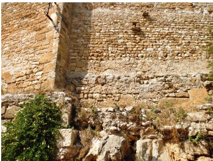
-Muros de tapia de argamasa con la costra perdida (Foto Ferrandis 2014).
