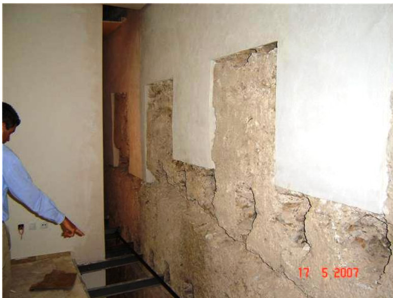
-Imagen de la puesta en valor de las almenas, en el interior de algunas habitaciones de la planta superior (Foto cortesía del centro, 2007).
