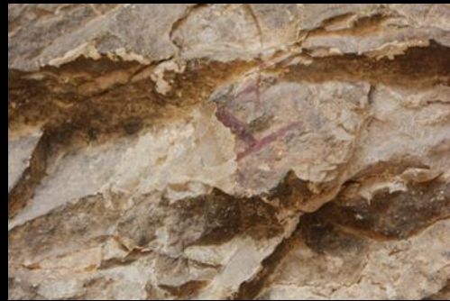
Fragmentación y desprendimiento
