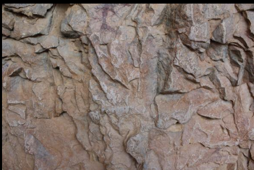
Descamación superficial y fisuración
