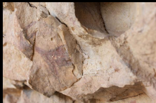
Fragmentación y desprendimiento.
