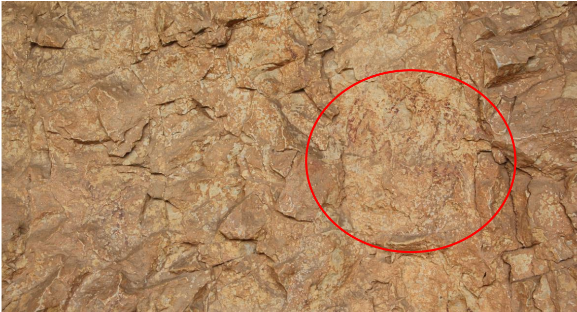
Figura 175. El grupo nº 14 presenta alteración mecánica por descamación y ruptura del soporte en forma de fisuras, ubicado en la Cavidad III ( Cova Remígia-Ares del Mestre ).
