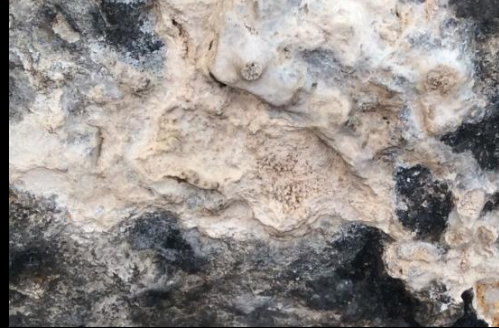
Pérdida de materia por acción físico-química provocada por el metabolismo de hongos
