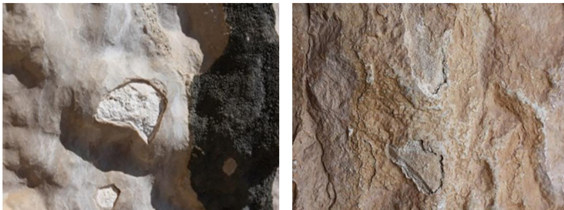
Figura 135-136. Costra de carbonato cálcico con desprendimiento de la capa externa más compacta, dejando al descubierto la parte inferior arenizada. Alteraciones de la superficie pétreo de Cova Remígia .
