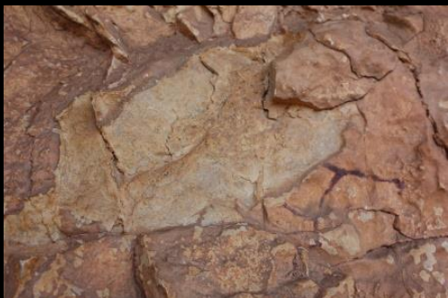
Fragmentación y desprendimiento.
