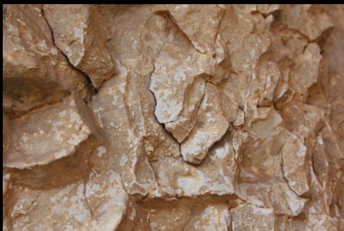
Fragmentación y fisuras.
