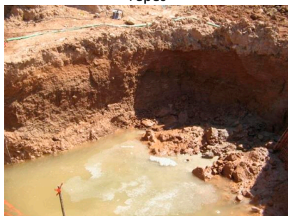
Figura 21. Inestabilidad de las paredes. Fuente: http://www.elblogdeapa.com/
