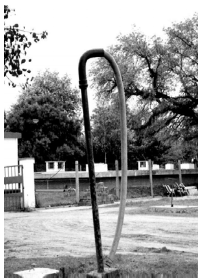
Figura 6. Grifo para la carga de camiones cisterna encargados de la distribución de agua potable en puntos de consumo público sin red de distribución.
