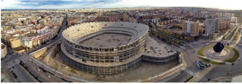
El nuevo estadio de Mestalla, a medio construir, Avenida de las Cortes Valencianas, 2015. [Foto: EFE]
