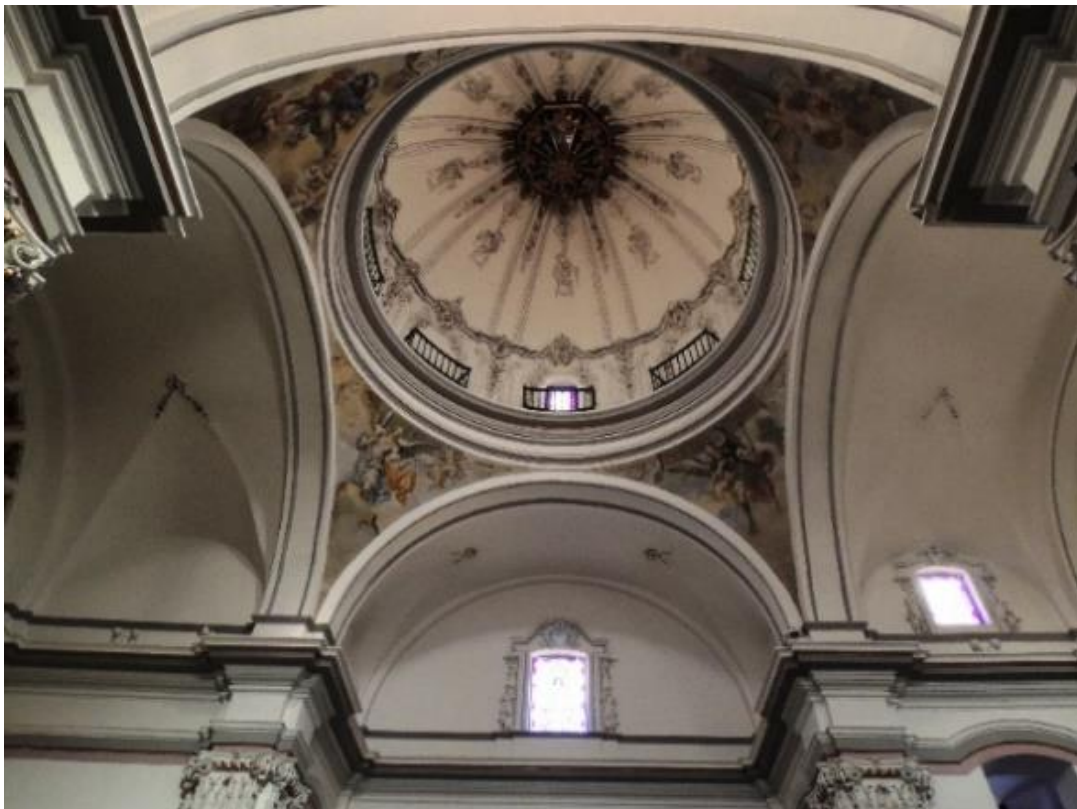
Fig. IV-70 Vista del tambor y media naranja desde el crucero, se puede apreciar la falta de boquilla en las pilastras. (Autor)
