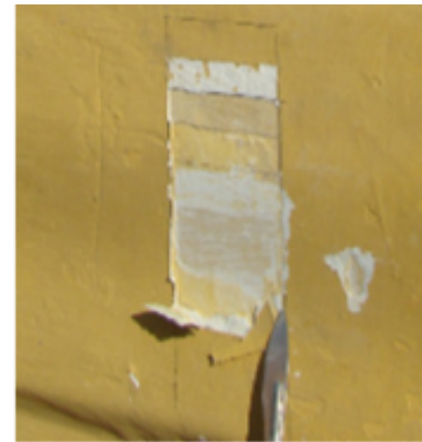
86. Extracción de muestras – calas estratigráficas. Edificio Faillace. Sección basamento o planta baja, detalle ornamental muro texturizado almohadillado.( Rossana Llanos).
