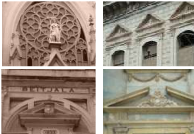
21, 22, 23, 24. Detalles ornamentales, nótese el estado de deterioro, cegamiento de vanos y alteraciones de los elementos compositivos y ornamentales. Izquierda superior Rosetón de la Iglesia de San Roque, Derecha superior, detalle vanos Antiguo Palacio Alzamora, Izquierda inferior sección del remate Edificio Beitjala, Derecha inferior, Detalle frontispicio partido Edificio Antiguo Almacén Ley. Barranquilla, 2009. (Rossana Llanos).
