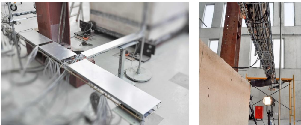
Figura IV-30. Detalle de bandejas y cableado
