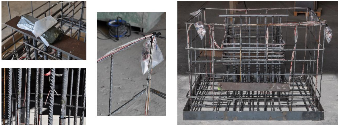
Figura IV-23. Detalle masilla AK22, protección de galgas y distribución y embolsado de cables
