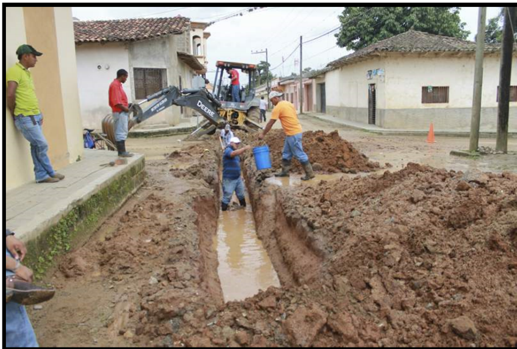
Figura 24. Problemas de roturas de tubería por exceso de presión en la comunidad de Tegucigalpa.
