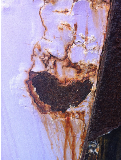
Imagen 3 | Delaminación y pérdida de material original provocado por una corrosión acusada
