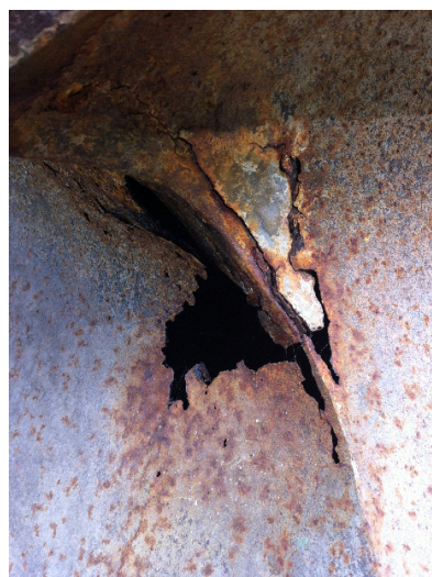
Imagen 4 | Restos de masilla epoxi de una intervención anterior (zona superior derecha)
