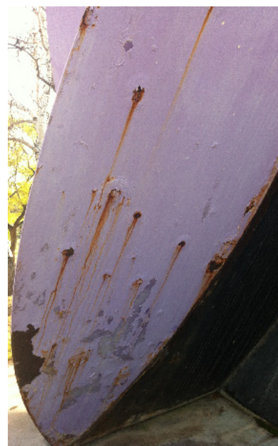
Imagen 2 | Claros daños por corrosión de la superficie en la obra Sin título de Edgar Negret ( Campus Escoltòric UPV )
